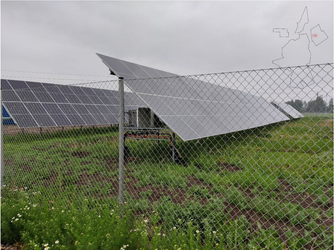
Kuva 26: Huhtikussa 2023 avatun Helen Oy:n Nurmijärven aurinkopuiston aurinkopaneeleita läheltä nähtynä. Kyseisen aurinkopuiston piikkiteho on 1,5 MWp.
