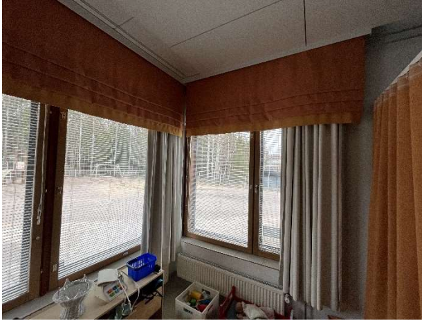
Kuva 99. Verhoissa havaittiin paikoin runsasta pölykertymää.
