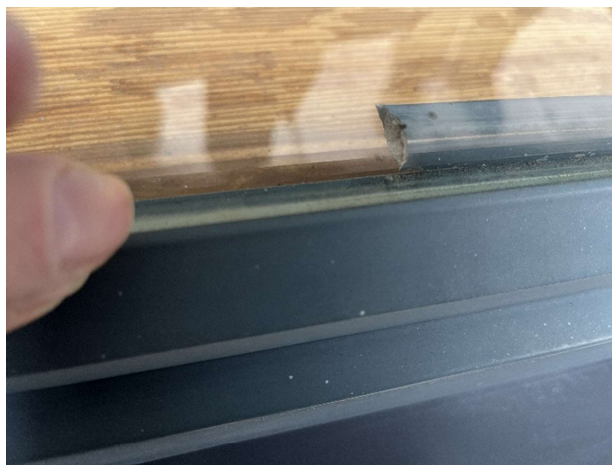
Kuva 46. Uloin ikkunalasi on epätiivis ilman reunalistaa.
