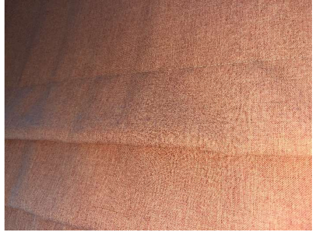
Kuva 100. Verhoissa havaittiin paikoin runsasta pölykertymää.
