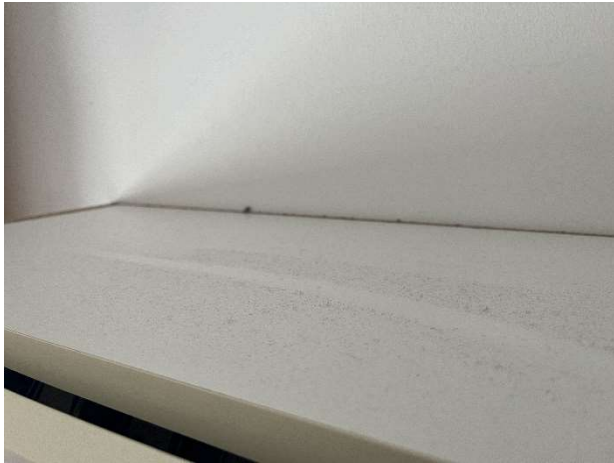
Kuva 101. Korkeiden kaappien päällä havaittiin pölykertymää.
