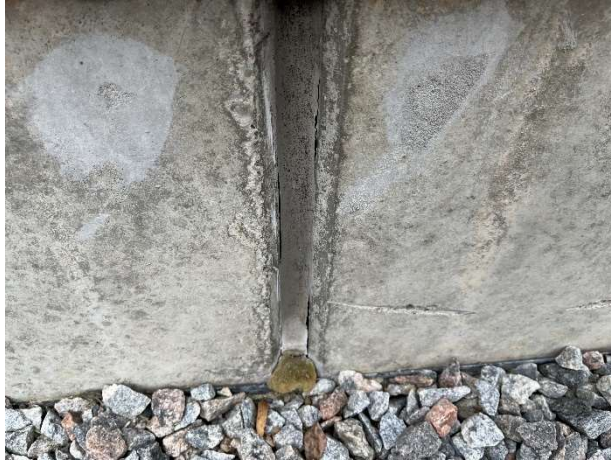
Kuva 52. Sokkelin elementtisaumauksissa havaittiin puutteita.
