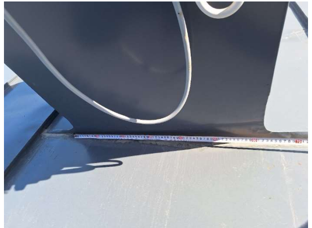
Kuva 66. Ilmanvaihtokoneesta puuttuu taustakallistus.
