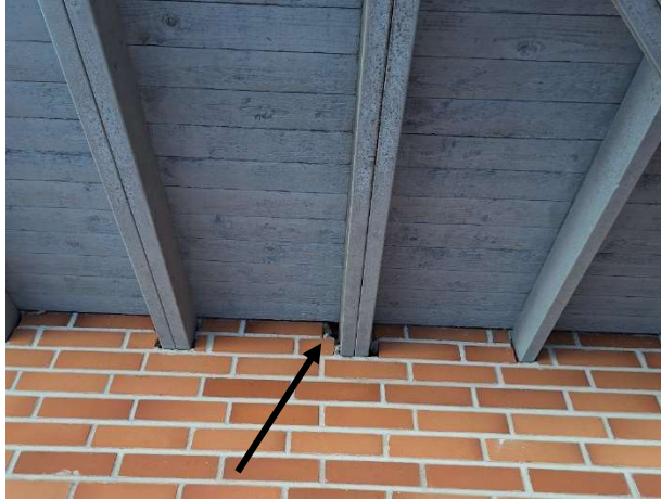
Kuva 77. Julkisivussa aukkoja, josta pieneläimet pääsevät yläpohjaan.
