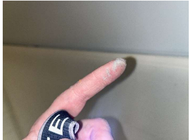
Kuva 102. Korkeiden kaappien päällä havaittiin pölykertymää.
