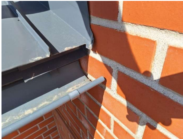
Kuva 79. Sadevesikourusta puuttuu päätylappu.
