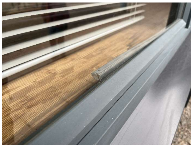
Kuva 44. Uloimpien ikkunalasien reunalistoissa havaittiin puutteita. Listat olivat paikoin poikki.
