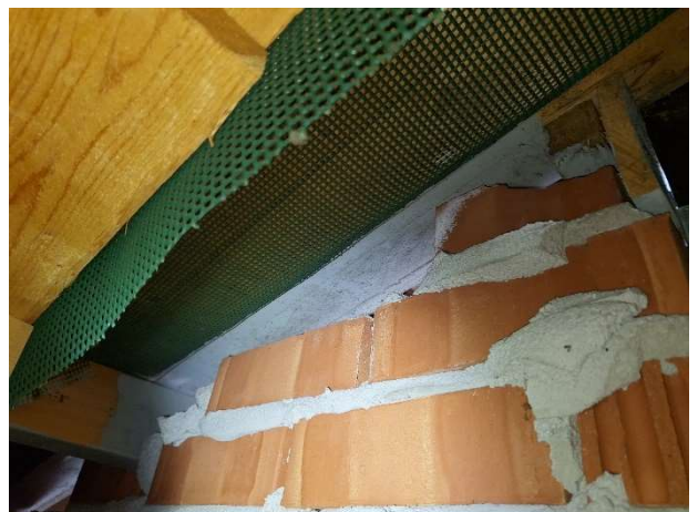
Kuva 76. Räystäällä on pieneläinverkko.
