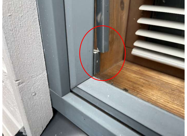
Kuva 47. Uloimpien ikkunalasien reunalistoissa havaittiin puutteita. Kuvassa reunalista on poikki (pystylistä).
