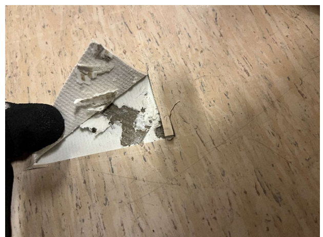
Kuva 34. Muovimattoa tilassa 022. Maton alapinta oli lujasti kiinni alustassaan.
