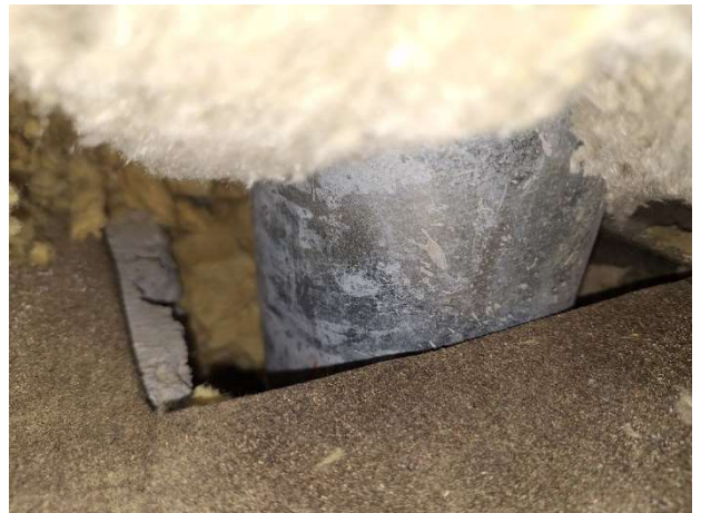
Kuva 74. Kermi ei ole tiivis läpivientien ympäriltä.
