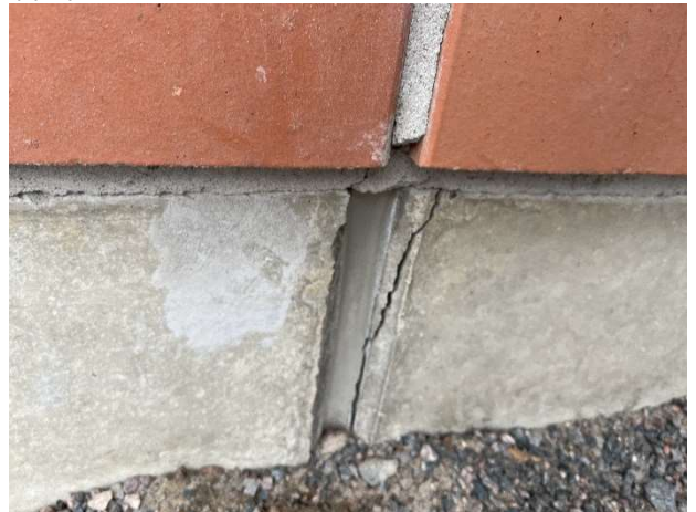
Kuva 49. Sokkelin elementtisaumauksissa havaittiin puutteita.
