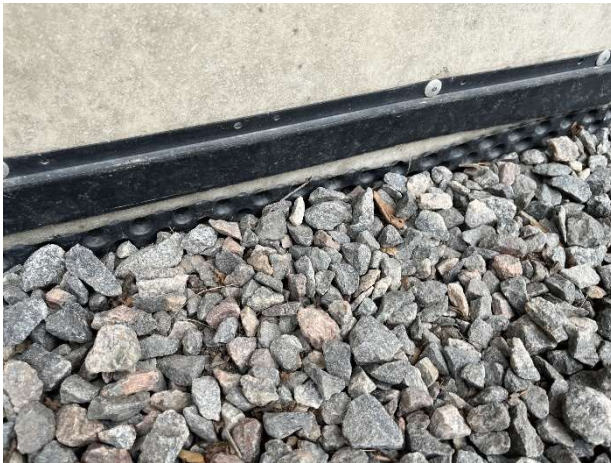
Kuva 48. Patolevyn reunalistan kiinnityksessä havaittiin puutteita.
