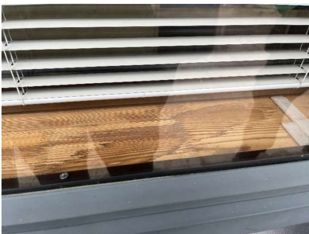
Kuva 45. Osa reunalistoista oli korjattu. Ikkunan karmirakenteissa havaittiin kosteusjälkiä.
