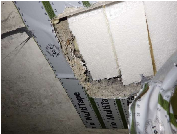
Kuva 24. Tiivistämätön läpivienti, jonka kautta havaittiin ilmavuotoa sisäilmaan.
