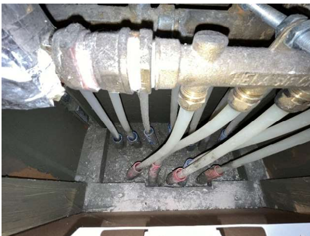
Kuva 103. WC-tilan kotelointia, jossa havaittiin jonkin verran rakennusmateriaalipölyä.
