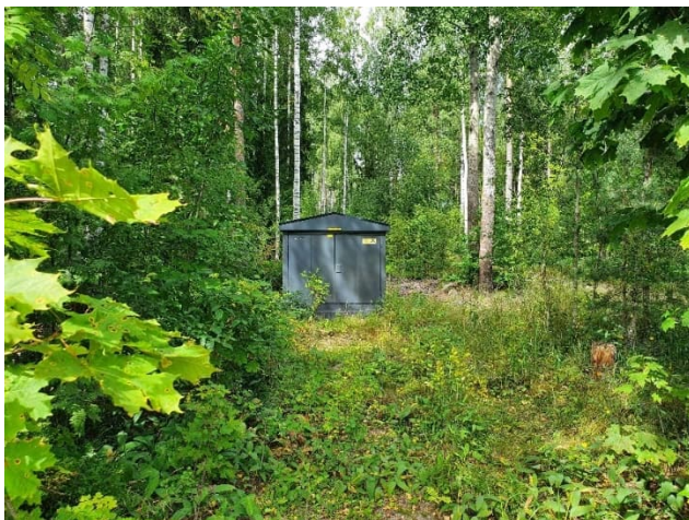
Kuva 15-1. Puistomuuntamo Nummenpään pohjavesialueella.
