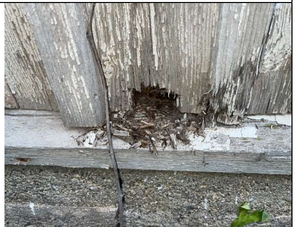
Kuva 10 Ulkoseinäverhouksessa havaittiin laajoja lahovaurioita.
