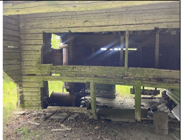
Kuva 40 Etuosan ulkoseinähirret ovat notkolla.
