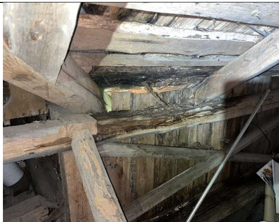
Kuva 5 Kosteus- ja lahovaurioita yläpohjassa ja ulkoseinärakenteissa.
