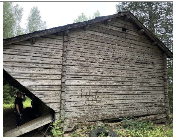
Kuva 47 Rakennuksen itäpuolen päädyssä ulkoseinähirsissä havaittiin laajoja laho- ja hyönteisvaurioita.
