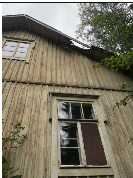
Kuva 17 Räystäät ovat paikoin lahot.
