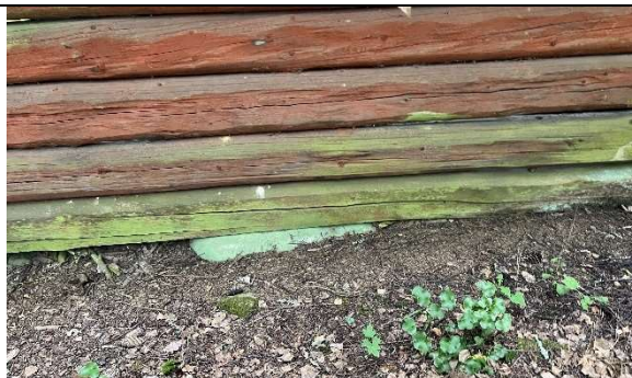
Kuva 50 Alimmat ulkoseinähirret on osin maata vasten.
