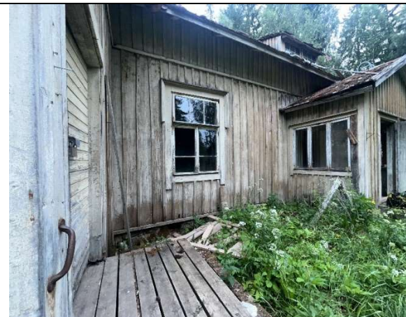
Kuva 9 Sisäänkäynnin puoleinen julkisivu on osittain pullahtanut ulospäin
