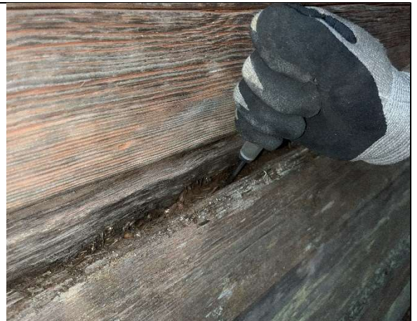
Kuva 28 Ulkoseinähirsissä havaittiin lahovaurioita.
