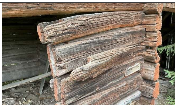
Kuva 52 Ulkoseinähirret ovat vaurioituneet.
