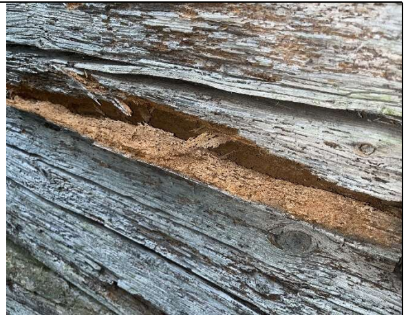
Kuva 46 Ulkoseinäverhouksessa havaittiin laajoja lahovaurioita.
