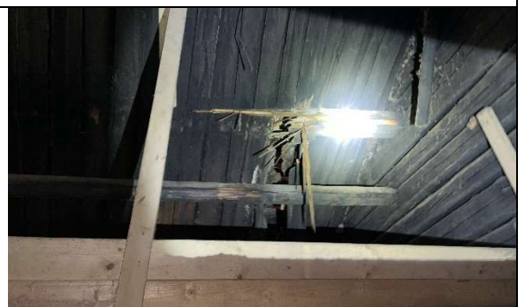
Kuva 44 Vesikatto on paikoin vaurioitunut.
