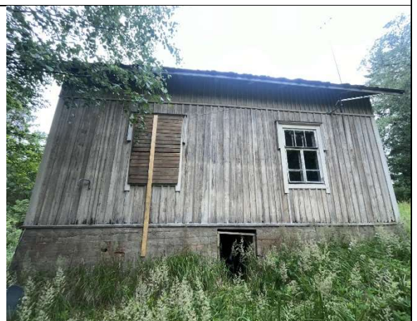
Kuva 12 Sokkeli on paikoin korkea.
