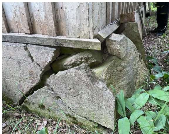
Kuva 14 Luonnonkivisokkelin päälle on valettu betoni, joka on paikoin halkeillut
