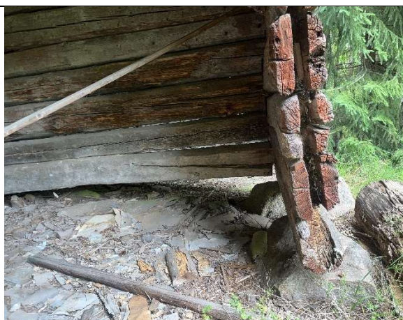
Kuva 54 Rakenteet ovat pettäneet.
