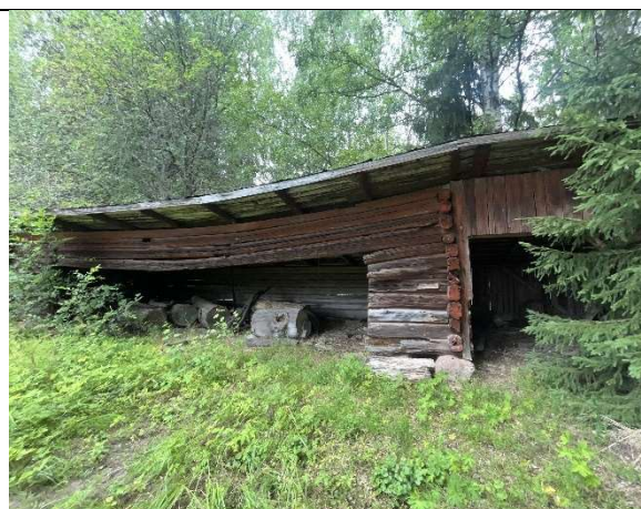
Kuva 53 Rakennuksessa on romahdusvaara.
