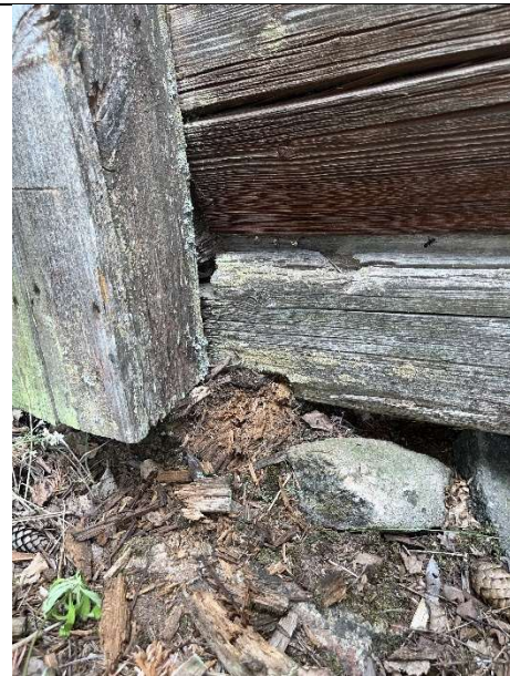
Kuva 27 Alimmat ulkoseinähirret ovat osin maata vasten.
