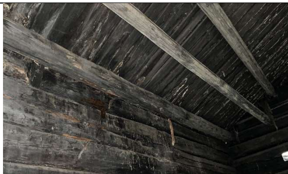
Kuva 41 Kosteus- ja lahovaurioita yläpohjassa ja ulkoseinärakenteissa.
