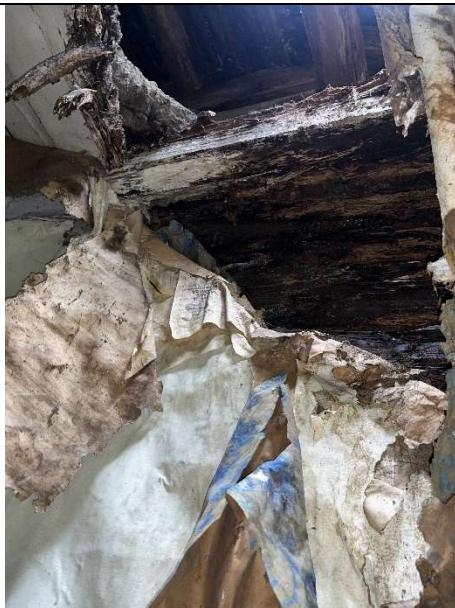
Kuva 22 Kosteus- ja lahovaurioita välipohjassa ja yläpohjassa.
