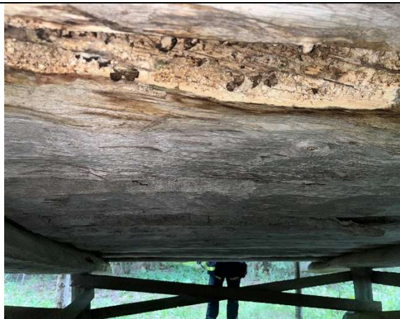
Kuva 36 Kosteus- ja mikrobivaurioita alapohjarakenteissa.
