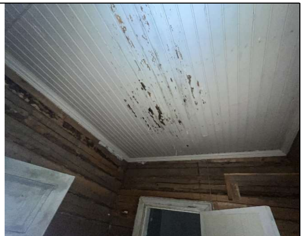
Kuva 4 Välipohja on notkolla.
