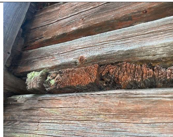
Kuva 29 Välipohjalaudoituksessa havaittiin lahovaurioita.
