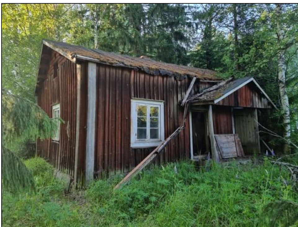
Kuva 6. Aitta 2 on huonossa kunnossa ja katto on osittain romahtanut.
