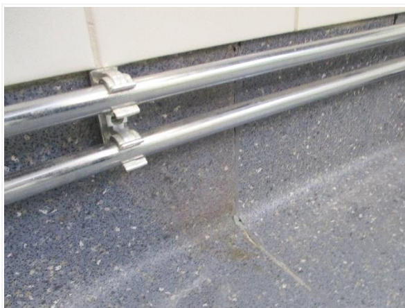
Kuva 19. Halkeama muovimaton saumassa, Pesuhuone/WC 17.
