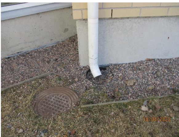
Kuva 5. Osa rännikaivoista on täynnä sepeliä.
