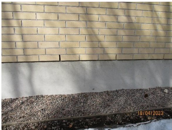
Kuva 8. Sokkelin betonipinnassa ei havaittu vaurioita.
