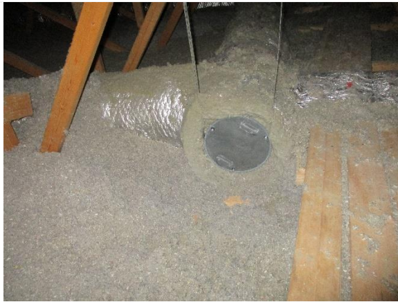
Kuva 34. Ilmanvaihtokanavien puhdistusluukut ovat yläpohjan eristekerroksessa, alkuperäinen rakennusosa.
