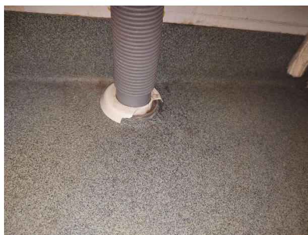
Kuva 23. Käsienpesualtaan viemäriputken mansetti on rikki. Lattiapinnalla havaittiin poikkeavia kosteusarvoja.
