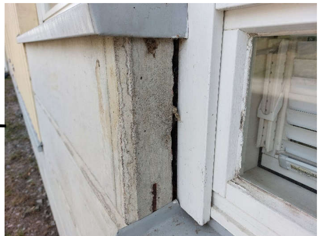
Kuva 12. Ikkunan ja kuorielementin välissä tiivistämätön rako.
