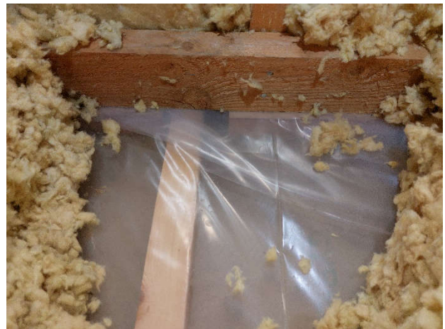
Kuva 93. Höyrnsulku on limitetty mutta ei teipattu.
