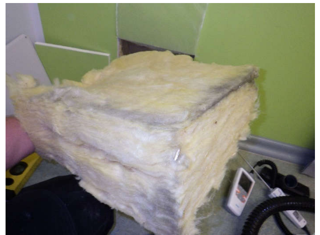
Kuva 48. Lämmöneristeessä havaittiin ilmavuodon aiheuttamaa tummentumaa.
