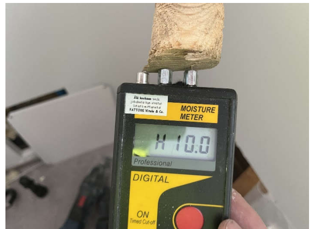
Kuva 46. Alaohjauspuun alapinnan kosteuspitoisuudeksi mitattiin 10 p-%.
