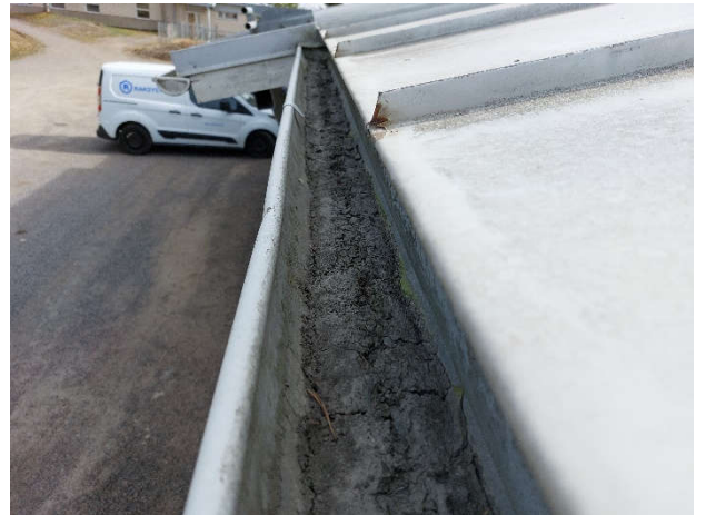
Kuva 87. Sadevesikouruissa havaittiin tarkastushetkellä roskaa.
