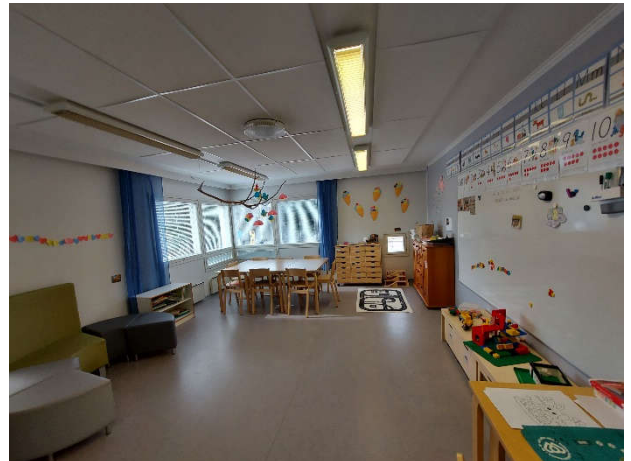
Kuva 76. Päiväkodin akustiikkalevyverhoilua katossa.
