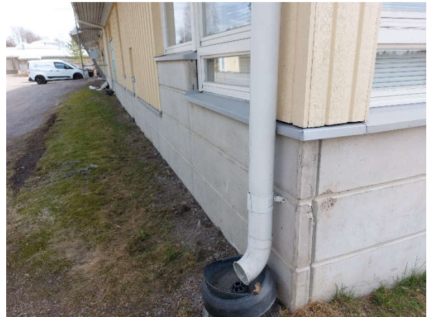
Kuva 10. Nurmialue on kasvanut kiinni sokkeliin.
