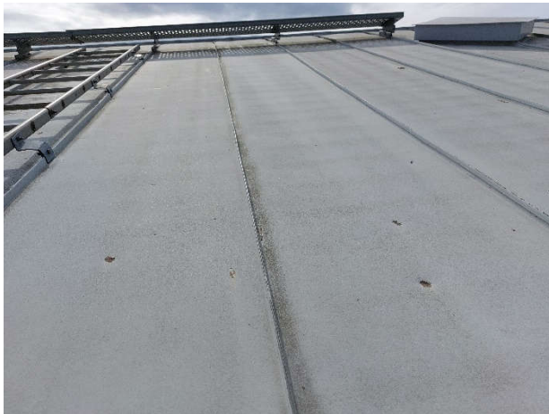
Kuva 80. Vesikatteessa havaittiin paikoin iskemiä.
