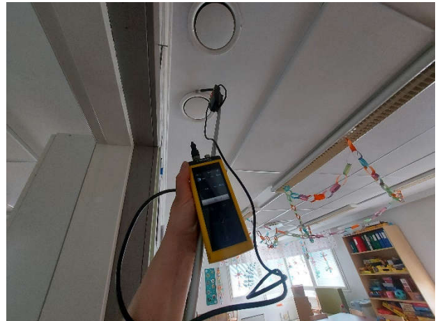
Kuva 95. Ilmavuotoa yläpohjan läpivientien kautta.
