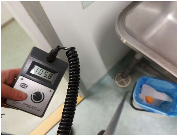
Kuva 26. Kodinhoituhuoneen lattiapinnoilla havaittiin poikkeavia pintakosteusarvoja.
