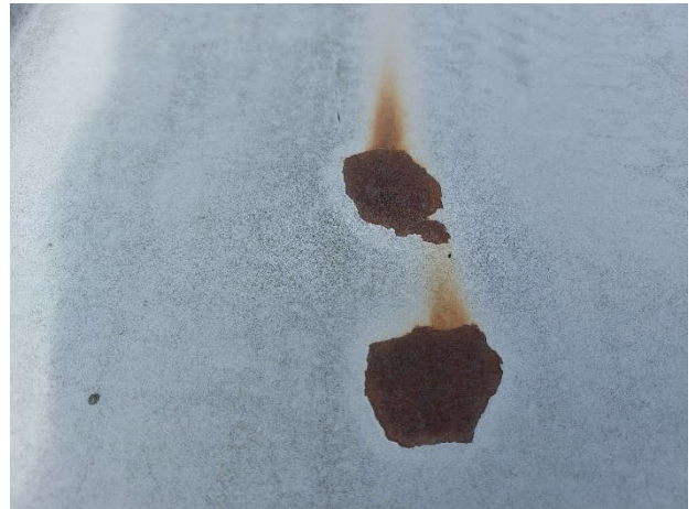
Kuva 81. Katteessa on paikallisia ruostevaurioita.
