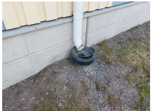
Kuva 8. Kattosadevedet on osittain ohjattu sadevesikaivoihin.
