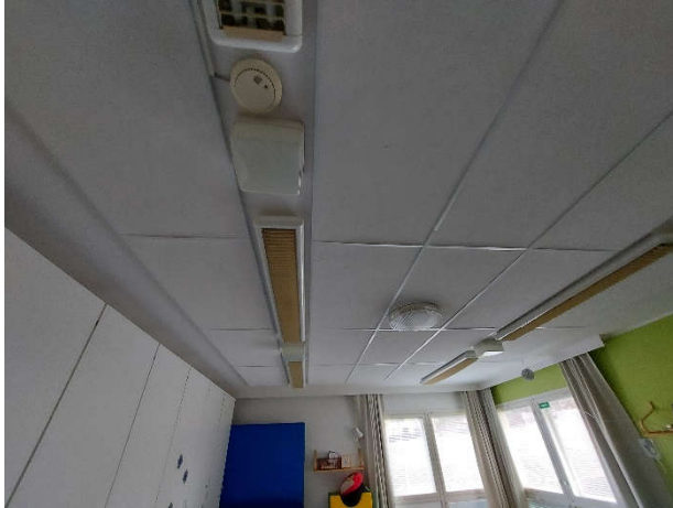
Kuva 71. Päiväkodin lepo- ja leikkitalan akustiikkalevyverhoilua katossa.
