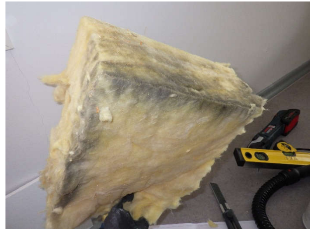
Kuva 32. Lämmöneristeessä havaittiin ilmavuodon aiheuttamaa tummentumaa.
