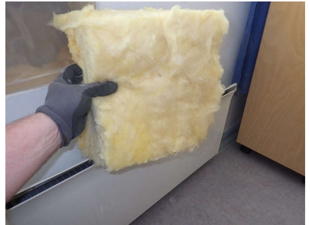
Kuva 36. Lämmöneristeessä ei havaittu aistinvaraisesti arvioituna puutteita.
