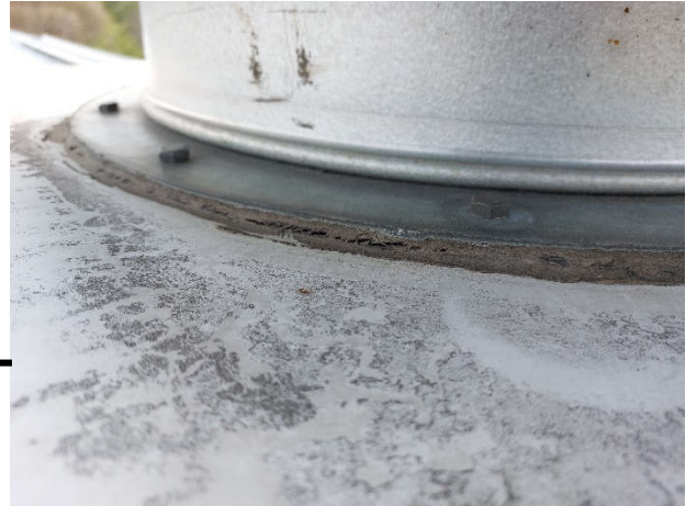
Kuva 85. IV-koneen liittöksen tiivistemassa on haurastunut.
