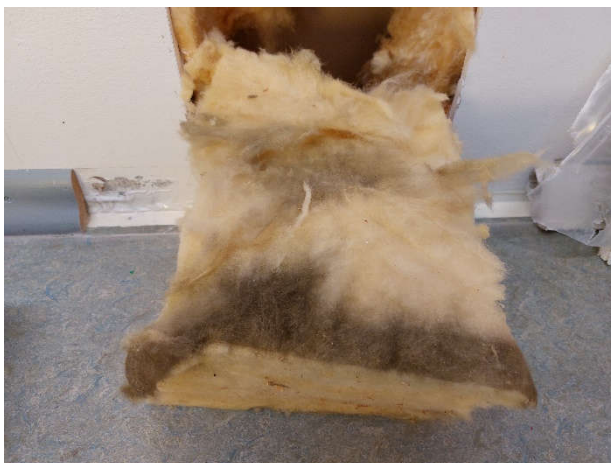
Kuva 61. Lämmöneristeissä viitteitä ilmavuodoista.
