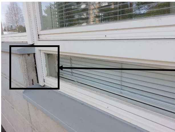
Kuva 11. Ulkoseinän rakenneliitoksissa havaittiin puutteita.
