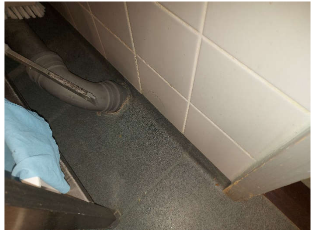
Kuva 25. Keittiön viemäriputken lähistöllä lattiassa havaittiin poikkeavia pintakosteusarvoja.
