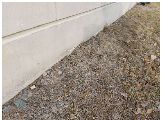
Kuva 18. Sokkeleissa havaittiin kosteuden aiheuttamia jälkiä.
