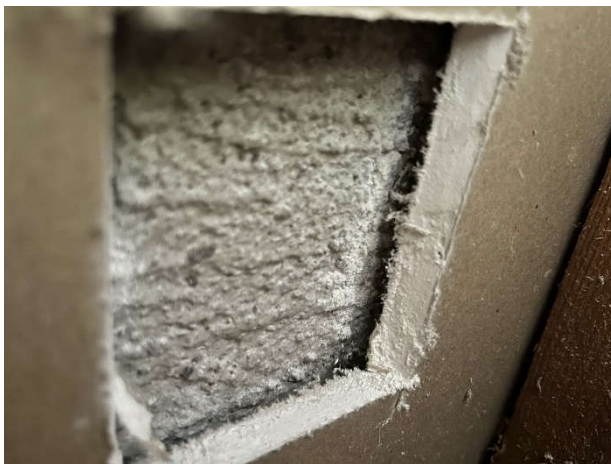
Kuva 45. Ulkoseinän tuuletusrako on niukka.
