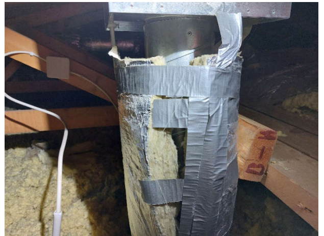
Kuva 89. IV-kanavan eristys puutteellinen.
