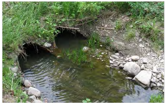
Kuva 11. Aspinniituntien alittavat kaksi rumpua ovat riittämättömät hulevesimäärän kasvaessa äkillisesti.
