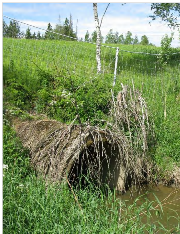
Kuva 2. Hämeenlinnanväylän alittava rumpu oli risukon peitossa.
