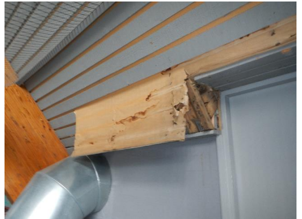
Kuva 134 Vuotojälkiä alemman lappeen liityntäkohdassa (YP4). Rajataitteesta on avoin ilmayhteys myös tasakattolapteen eristetilaan.
