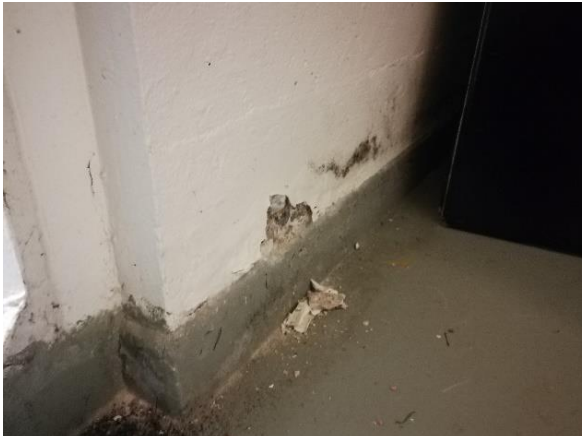
Kuva 39 Väestönsuojan tiloissa havaittiin näkyviä viitteitä kohonneesta kosteudesta.
