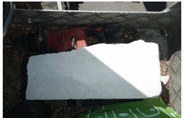
Kuva 68 Osa julkisivuviitistä on lohkottu ohuemmiksi. Normaali kalkkijiekkatiilen paksuus on 130 mm, kavennettujen tiilien vahvuus vaihteli 100...130 mm välillä.
