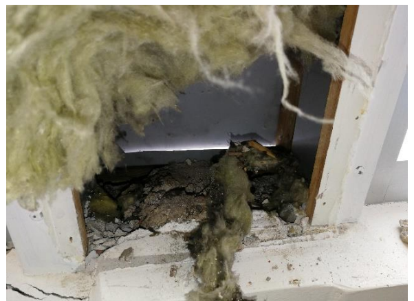
Kuva 70 Ulkopuolen pellitys oli alareunastaan ulos asti avoin. Mineraalivilloissa esiintyi ilmavuotojälkiä.
