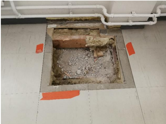
Kuva 35 Luokkatilassa RK1 (K17) lattiarakennetta tarkasteltiin myös kohdassa, jossa puukoolattu lattia muuttuu kokonaan betonirakenteiseksi.
