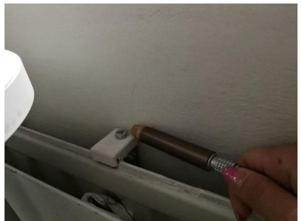
Kuva 86 Ilmavuotoja patterikannakkeiden kohdalla.
