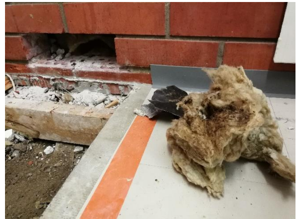
Kuva 23 Oppilaskunnan tilassa K20 maanvastaisen seinärakenteen mineraalivillat olivat selvästi kostuneita. Betoninen pengerrys kerää pintavesiä rinteestä oppilaskunnan tilan maanvastaista ulkoseinärakennetta vasten.
