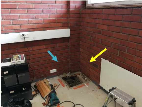
Kuva 20 Oppilaskunnan tilassa K20 molemmat maanvastaiset ulkoseinärakenteet ovat kastuneet sekä puurakenteisen alapohjan lämmöneristeissä ja koolauspuissa esiintyy kosteusvaurioita.
