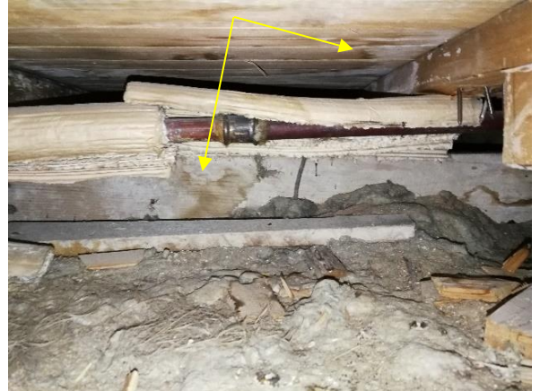
Kuva 96 Välipohjarakenteissa oli havaittavissa vuotojälkiä. Alapohjaan on päässyt vuotovesiä katto- tai läpivientivuotojen seurauksena. Lattian alla on erilaisia rakennusmateriaaliperäisiä jätteitä.
