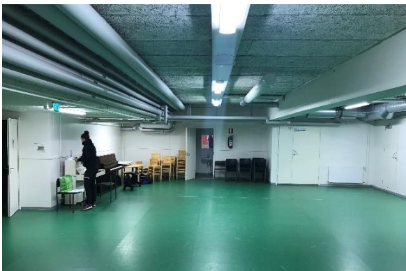
Kuva 43 Yleiskuva tanssisalista. Lattiavaneri on suoraan betonilaattaa vasten.
