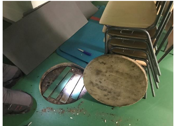
Kuva 14 Salaojan tarkastuskaivo tanssisalissa K50B. Tarkastuskaivossa vesipinta n. 300 mm lattiapinnasta. Kaivosta lähtee alkuperäinen tiilisiä salaojaputki. Salaojaputki veden peitossa, salaojitus ei toimi suunnitellusti.
