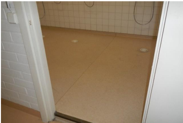
Kuva 41 Pohjakerroksen suihkuhuonetila K47, Lattiapintarakenteissa todettiin kosteutta.
