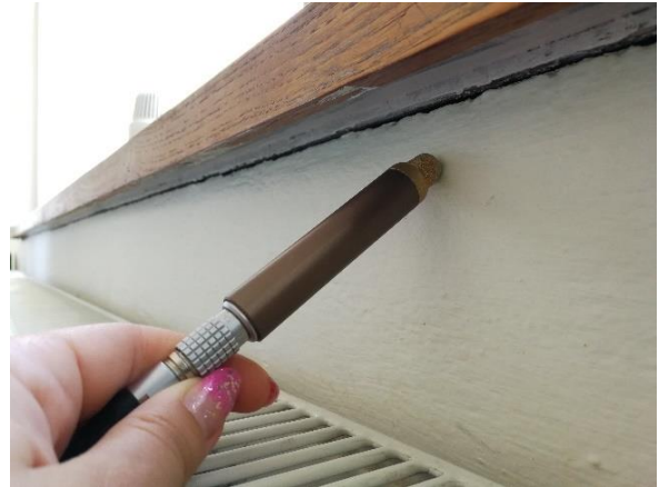
Kuva 90 Opettajanhuoneessa ilmavuotoa havaittiin ikkunalaudan alapuolelta.
