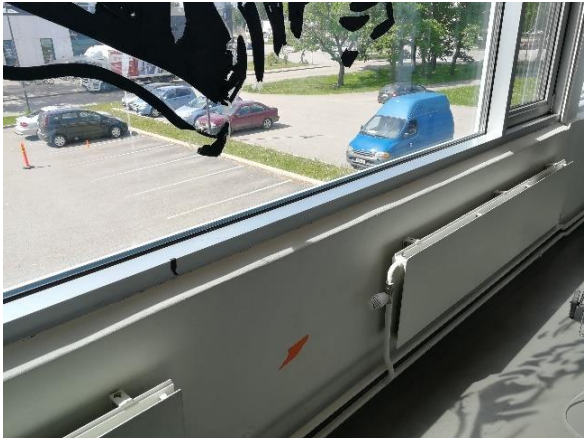
Kuva 87 Ilmavuotoa havaittiin ikkunan alakarmin ja ulkoseinärakenteen liittymäkohdassa.
