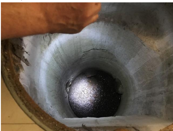
Kuva 15 Käytävällä K34 sijaitseva salaojan tarkastuskaivo. Kaivoon johdettu tanssisalista K50B salaoja, joka ei toimi.
