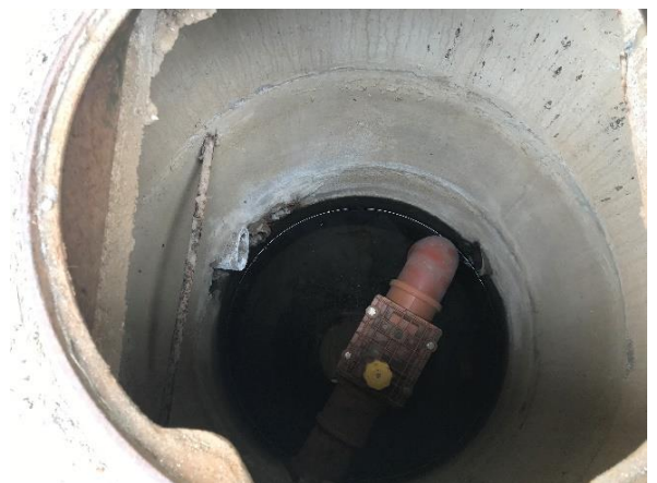
Kuva 16 Perusvesikaivo piha-alueella luokkatilan K06 edustalla. Kaivoon on liitetty salaojaputkia rakennuksen alta.
