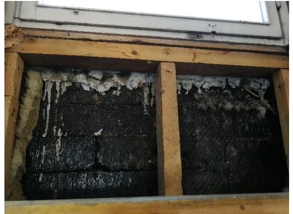
Kuva 54 Liikuntasalin betoniulkokuoressa on sisäpuolinen bitumivedeneriste. Rakenne on ulkoilmaa vasten kosteusteknisesti riskialtis rakenne.
