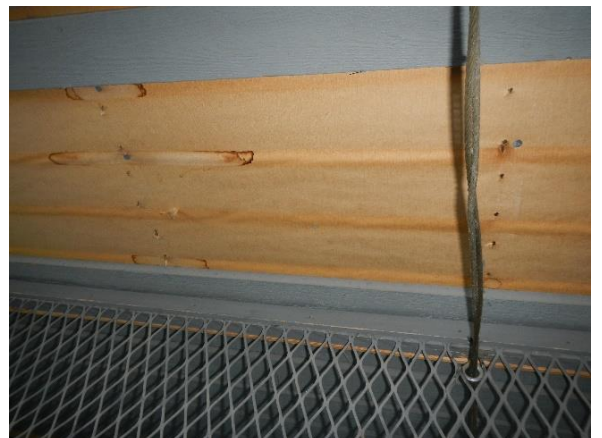
Kuva 136 Vuotojälkiä alemman lappeen kohdalla liikuntasalin itäpäädyssä (YP2).
