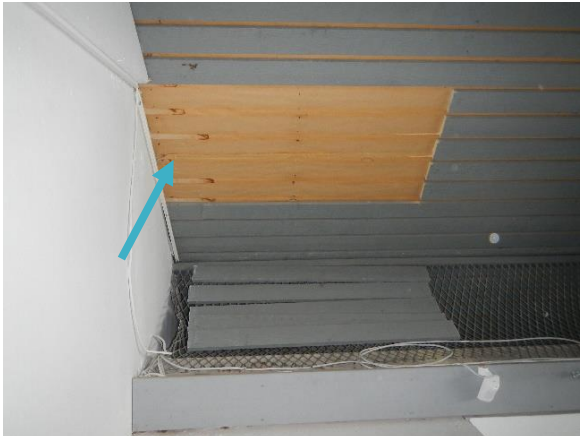
Kuva 131 Liikuntasalin yläpohjarakenteen kuntoa tarkastettiin sisäpuolisilla rakenneavauksilla (YP3). Harvalaudoituksen alapuolisessa ilmansulkupaperissa havaittavissa vuotojälkiä.
