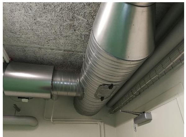
Kuva 149 Tanssisalin K50B tuloilmakanavan päällä havaittiin erittäin runsaasti pölyä.
