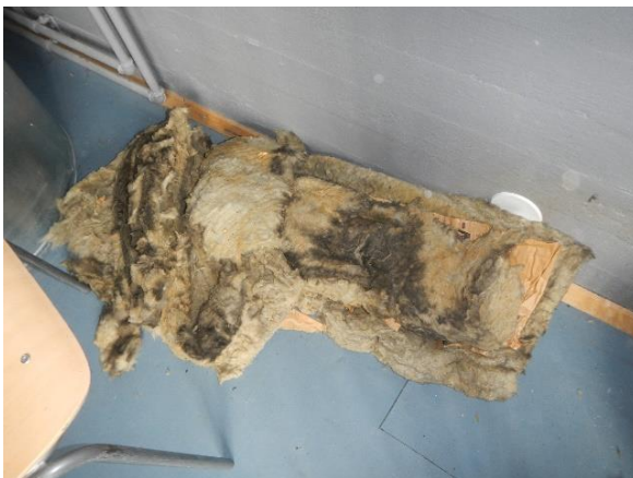
Kuva 135 Yläpohjaeristeessä runsaasti ilmavuotojen aiheuttamaa tummentumaa (YP4).
