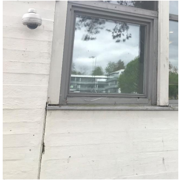
Kuva 66 Sokkeliosuuksilla on kosteusteknisesti riskialttiita saumoja (hallitilan päätyulkoseinä).
