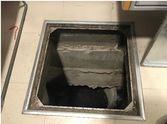
Kuva 13 Pohjakerroskäytävä K05A luokkahuoneiden edustalla. Käytävällä sijaitsee vanha kaivorakenne, johon on liitetty alkuperäisiä tiilisiä salaojaputkistoja. Salaojituksen toimivuutta ei voitu todentaa.
