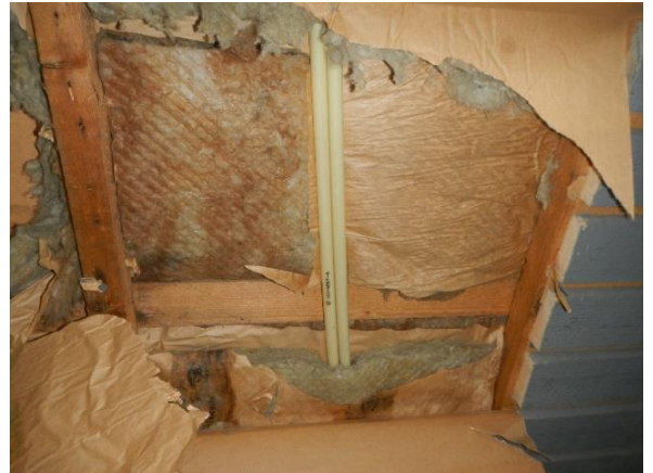
Kuva 132 Mineraalivillassa esiintyy runsaasti vuotojälkiä (YP3).
