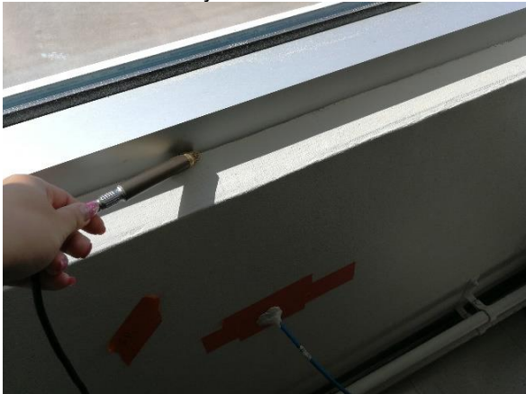
Kuva 89 Ilmavuotoja havaittiin ikkunan alakarmin ja ulkoseinärakenteen liittymäkohdassa.
