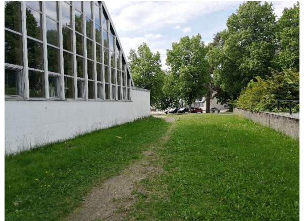
Kuva 10 Rakennuksen pohjoispuolella, rinteen yläpäässä maanpinta viettää rakennuksen vierustalla aavistuksen rakennukseen päin.
