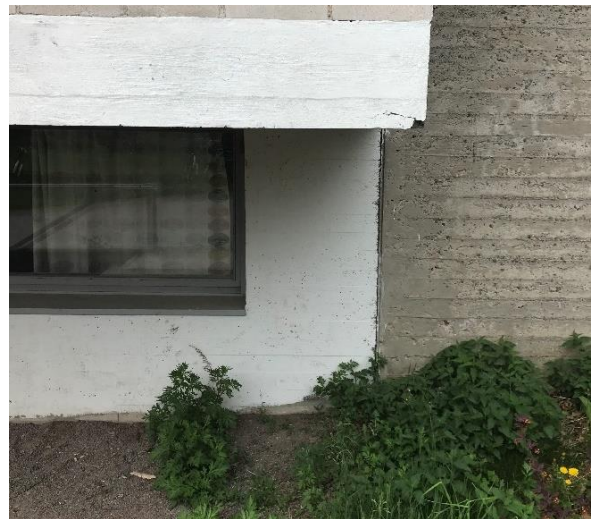
Kuva 64 Sokkeliosuuksilla on kosteusteknisesti riskialttiita saumoja (oppilaskunnan K20 tilan ulkokulmaus).
