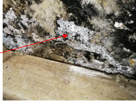
Kuva 27 Varasto-osan (tila 130) ulkoseinien betonisokkelin sisäpuolinen bitumieriste on rikkonainen ja betonipinta on pintakosteudentunnistimella havainnoiden märkä.
