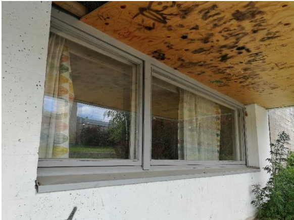
Kuva 80 Oppilaskunnan ikkuna ovat puuikkunoita, ikkunat ovat jo huonokuntoiset.
