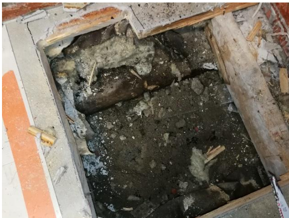
Kuva 31 Oppilaskunnan alapohjan rakenneavauksessa havaittiin mikrobivaurioitunutta puuainesta ja märkää hiekkaa.
