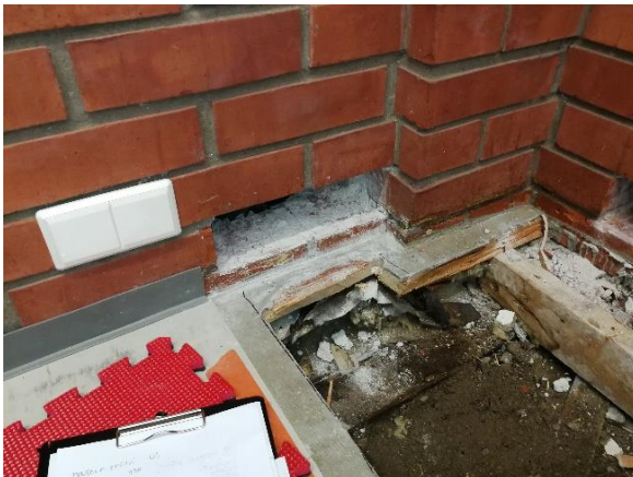
Kuva 22 Rakenneavaus tehtiin molemmille maanvastaisille seinärakenteille ulkonurkassa. Ulkoseinärakenteet ovat kastuneet sekä puurakenteisen alapohjan lämmöneristeissä ja koolauspuissa esiintyy kosteusvaurioita.
