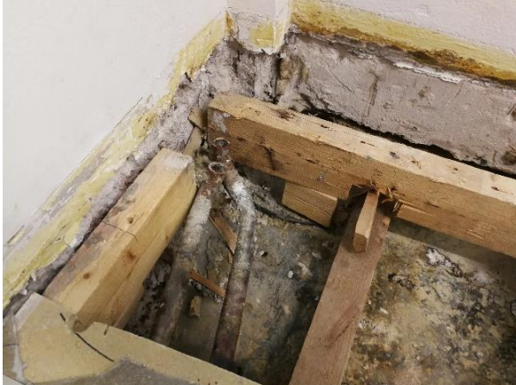
Kuva 33 Luokkatilassa RK1 (K17) lattiarakennetta tarkasteltiin luokan ulkonurkassa. Alapohjan bitumieristyskerros (vesieristys) on paikoin rikkonainen. Rakenne on kosteusteknisesti riskialtis rakenne.
