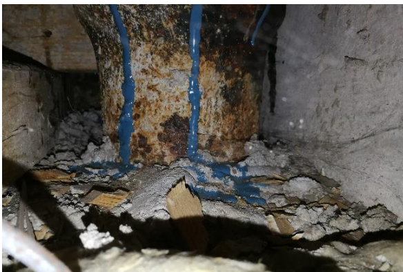
Kuva 97 Kattovesien viemärintiputki on ruostunut.
