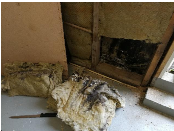
Kuva 57 Varastototilan 130 betoninen ulkokuori on vedeneristetty sisäpuolelta bitumilla. Mineraalivillaeristeissä oli havaittavissa runsaasti ilmavuotojen aiheuttamaa tummentumaa. Materiaalinäytteenanalyysin MN50 perustella lämmöneristeessä on vahva viite materiaalin mikrobivauriosta.
