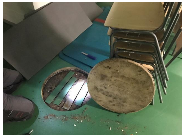
Kuva 38 Tanssisalissa betonilaatan päälle on asennettu lattiavaneri, jonka alapinnassa on silminnähtävää mikrobiperäistä tummentumaa (salaajan tarkastuskaivon kohta).
