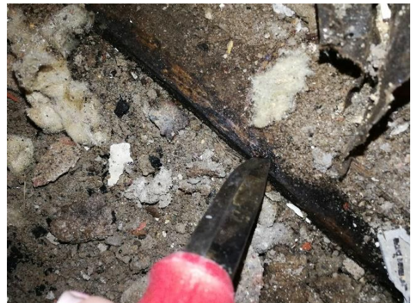
Kuva 32 Betonilaatan päällä kulkevat puukoolaukset olivat märät.
