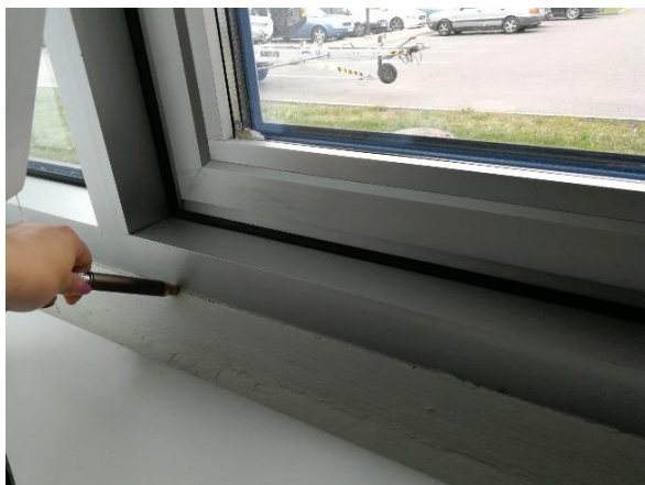
Kuva 85 Ilmavuotoja havaittiin ikkunan alakarmin ja ulkoseinärakenteen liittymäkohdassa.
