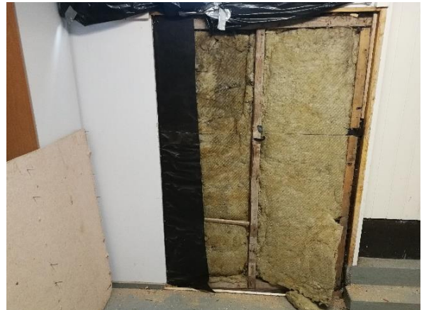
Kuva 56 Varastotilaan 130 tehtiin rakenneavaus sisäpuolelle. Mineraalivillaeristeisiin on muodostunut mikrobivaurioita.
