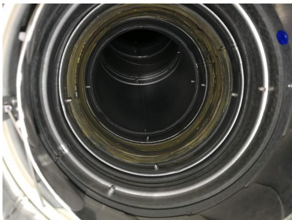
Kuva 148 Sisääntuloaulan/lämpön 106 tuloilmakanavasta otettiin pyyhintänäyte. Kanavassa havaittiin jonkin verran pölyä.
