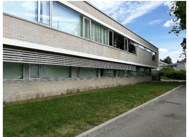
Kuva 4 Rakennuksen lounaispuolella (pysäköintialueen puoli) kellarikerros on kokonaan maanpinnan yläpuolella. Maanpinnan kaadot ovat rakennuksen vierustalla tasaiset ja seinänvierustalla on osin painanteita johon pintavesiä voi kerääntyä. Sokkelista tehtyjen havaintojen perusteella ulkopuolinen maanpintataso on ollut nykyistä tasoa n 200 mm korkeammalla → kosteusrasitus
