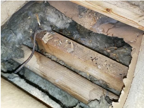
Kuva 99 Välipohjarakenteessa havaittiin vuotojälkiä paperi- ja pahvieristekerroksissa sekä puukoolauksissa (avaus VP3).
