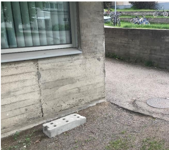
Kuva 63 Sokkeliosuuksilla on kosteusteknisesti riskialttiita saumoja (luokkatilan K17 ulkokulmaus).
