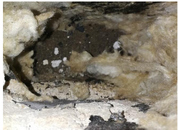
Kuva 25 Ulkoseinärakenteen "pohjalla" on hienoa hiekkaa ja laastia, jotka ovat kastuneet.
