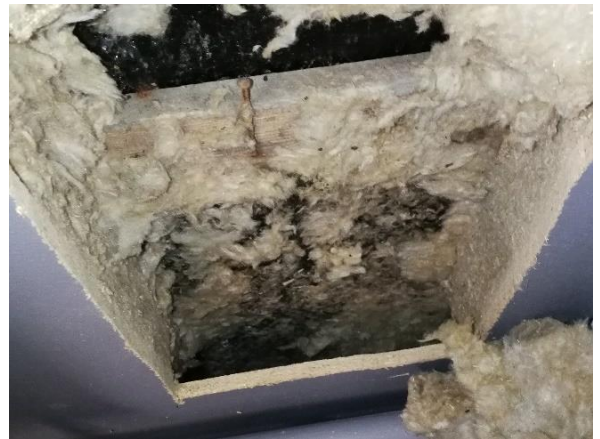
Kuva 29 Liikuntasalin patjavaraston ulkoseinä Betoninen ulkokuori on vedeneristetty bitumilla. Lämmöneristeenä on käytetty mineraalivillaa. Lämmöneristeet ovat aistinvaraisten havaintojen perusteella vaurioituneet poikkeavan kosteuden vaikutuksesta. Kyseinen avattu ulkoseinä on maanpinnan tason alapuolella.
