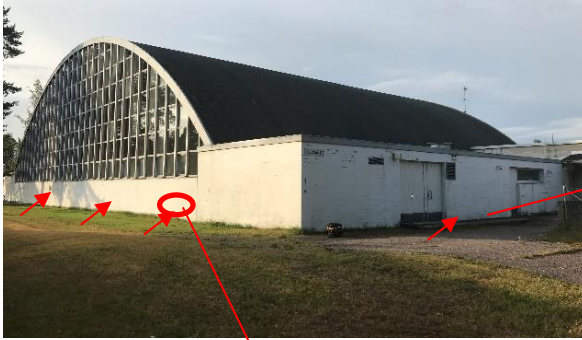
Kuva 26 Liikuntasaliosan, varaston ulkoseinien sekä maanpaineseinien puukoolatuissa ja mineraalivillalla lämmöneristetyissä seinissä esiintyy kosteus- ja mikrobivaurioita.
