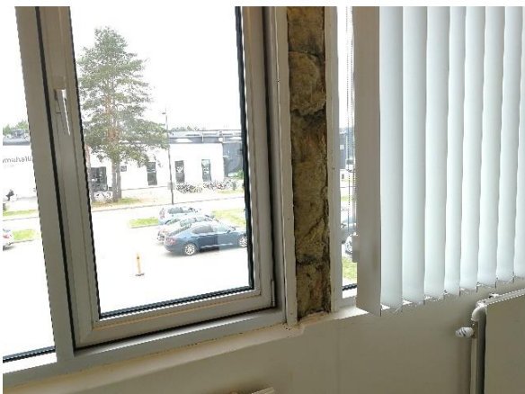
Kuva 69 Toisen kerroksen ikkunalinjalta poistettiin peitelevy. Ikkunavälin rakenteessa ei ole höyrynsulkuja.
