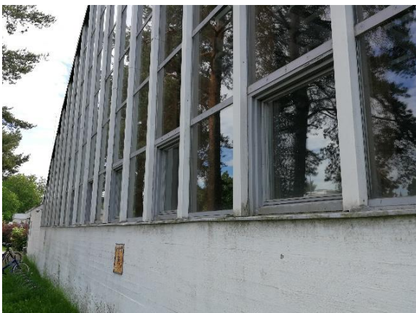
Kuva 78 Liikuntasalin päädyn ikkunat on todennäköisesti joissain kohtaa uusittu, mutta ikkunat ovat jo huonokuntoiset. Erityisesti tuuletusikkunoista on tullut vesivuotoja.
