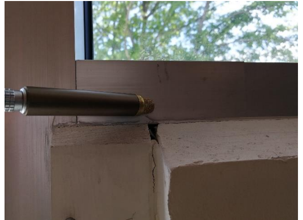
Kuva 88 Ilmavuotoja ulkoseinän liittymärakenteista.
