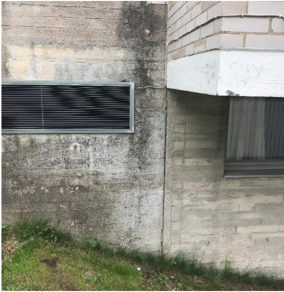
Kuva 65 Sokkeliosuuksilla on kosteusteknisesti riskialttiita saumoja (tilan K04 ulkokulmaus).
