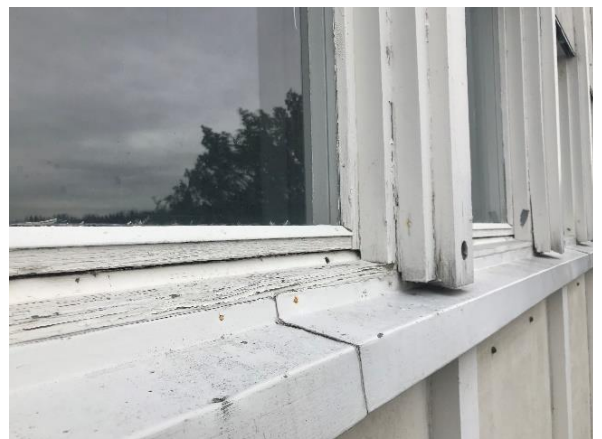
Kuva 79 Liikuntasalin kaaren toisessa päädyssä ikkunat ovat niin ikään huonokuntoisia. Ikkunapellitykset ikkunakarmeihin on toteutettu epätiiviisti.
