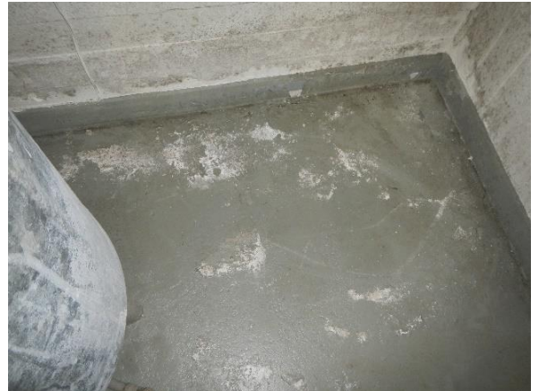
Kuva 40 Väestönsuojan tiloissa havaittiin näkyviä viitteitä kohonneesta kosteudesta.
