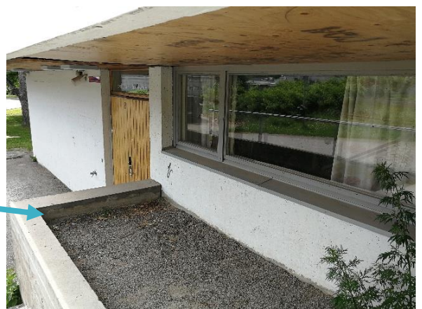
Kuva 6 Pintavedet pääsevät kerääntymään pengerrykseen, jolloin maanvastaisille seinärakenteille kohdistuva kosteusrasitus on suuri. Taustalla olevan oppilaskunnan huonetilan maanvastaisen ulkoseinän eristetilään ja puurakenteiseen alapohjarakenteeseen muodostunut kosteusvaurioita ulkopuolisen kosteuden seurauksena.
