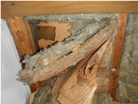
Kuva 133 Vuotojälkiä esiintyy mineraalivillaeristeiden välisissä papereissa (YP3). Lisäksi eristeissä on havaittavissa ilmavuotojen aiheuttamaa tummentumaa.
