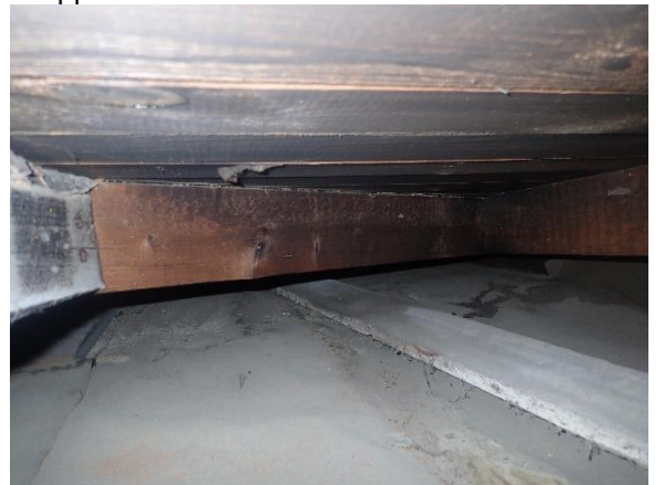
Kuva 116 Yleiskuva yläpohjaan edellisen valokuvan kohdalta. Vesikatteen alustalaudoitus on tummunut puutteellisen yläpohjan tuulettuvuuden seurauksena. Yläpohjan paperipäällysteisen mineraalivillan päällä on havaittavissa paikoin myös vanhoja vesivuotojälkiä.
