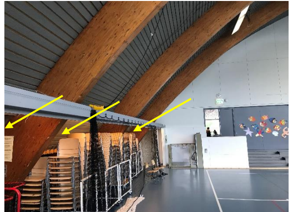
Kuva 100 Kaaren molemmissa päissä, kaaren alaosissa on vesivuotojälkiä ja korjattuja alueita. Vuotovesiä on todennäköisesti päässyt myös lattialle ja välipohjan eristetilaan.
