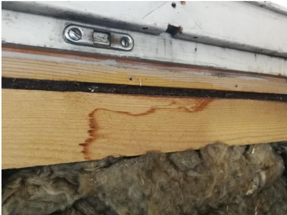
Kuva 53 Vesijälkiä esiintyi myös liikuntasalin ikkunarakenteiden tukipuurakenteissa
