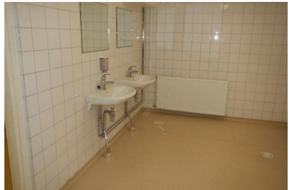
Kuva 42 Pohjakerroksen suihkuhuonetila K47, Lattiapintarakenteissa todettiin kosteutta.
