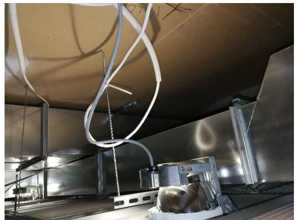
Kuva 47 Ilmanvaihtokanavat ym. tekniikkaa kulkee käytä- vätilassa, alakattojen yläpuolella.
