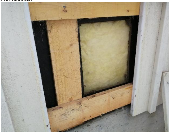
Kuva 22 Rakenneavauksia tehtiin ympäri rakennusta. Rakenneavauspisteistä todettiin yleisesti, että rakenteet ovat aistinvaraisesti havainnoiden terveitä ja vaurioitumattomia.
