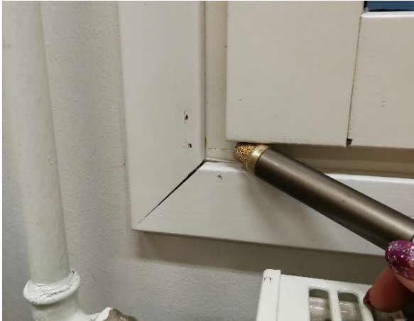
Kuva 34 Ilmavuotoa ikkunaliittymästä luokkatilassa 104.
