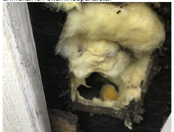
Kuva 23 Ruokasalin kohdalle tehtiin rakenneavaus, josta otettiin mikrobinäyte mineraalivillasta (MN18).
