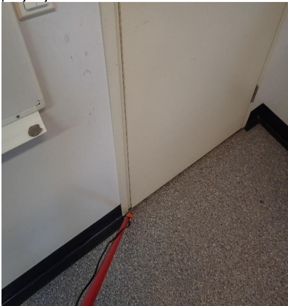
Kuva 14 Luokkatilassa 105 pistemäistä merkkiainevuotoa todettiin oven kohdalla, missä muovinen jalkalista päättyy.
