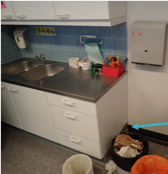
Kuva 12 Luokkatilassa 104 todettiin pistemäisiä merkkiainevuotokohtia kiinteään allaskaapin takaa alapohjan ja ulkoseinän liitoskohdassa.
