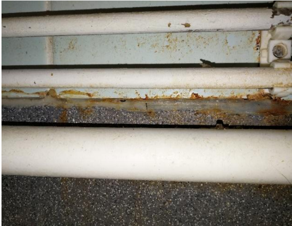
Kuva 28 Muovimaton ylösnoston ja seinäläatoituksen välistä rajapintaa on tiivistetty jälkikäteen silikonilla, mutta liittymässä oli havaittavissa edelleen epätiiviyiskohtia. Muovimatto päättyy seinäläatoituksen alaosaan.
