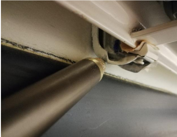
Kuva 32 Ilmavuotoa patterikannakkeiden läpiviennistä luokkatilassa 105.
