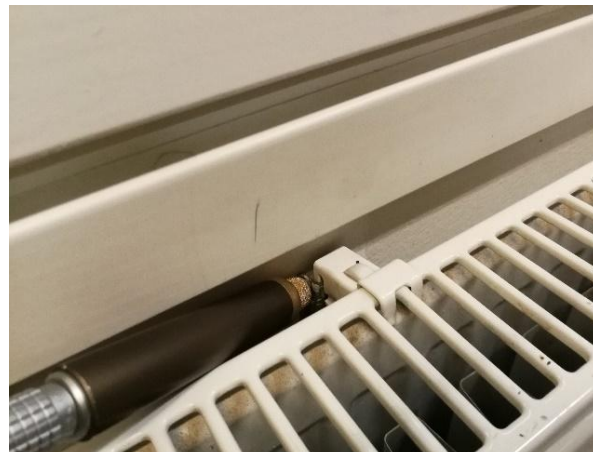
Kuva 31 Ilmavuotoa patterikannakkeen läpiviennistä luokassa 106.
