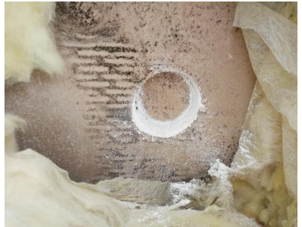
Kuva 27 Näkyvää mikrobikasvustoa esiintyy myös sisäpuolisen kipsilevyn pinnassa.
