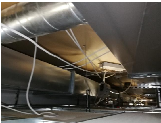
Kuva 46 Ilmanvaihtokanavat ym. tekniikkaa kulkee käytä- vätilassa, alakattojen yläpuolella.
