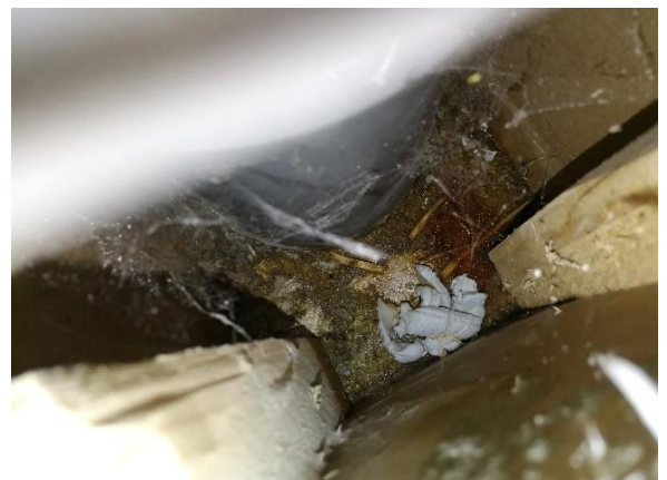
Kuva 9 Kosteutta oli aistinvaraisesti havaittavissa myös tuuletusputken koteloinnin sisällä.
