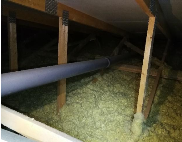
Kuva 44 Viemärin tuuletusputki on lämmöneristämättä yläpohjassa.
