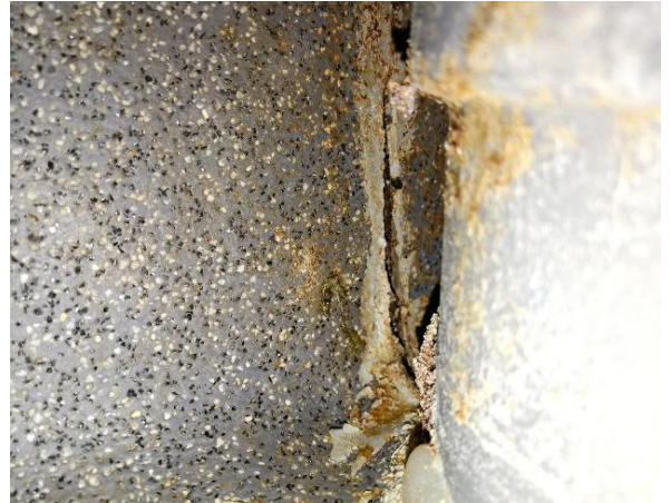
Kuva 29 Viemäriputken takana muovimaton lattian ylösnosto on ratkennut.
