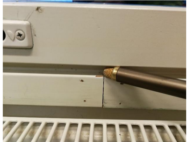
Kuva 33 Ilmavuotoa ikkunaliittymistä luokkatilasta 105.
