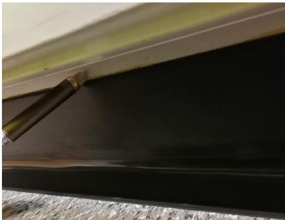
Kuva 30 Ilmavuotoa lattialistan yläreunasta (lattian ja ulkoseinän liittymästä) luokassa 106.
