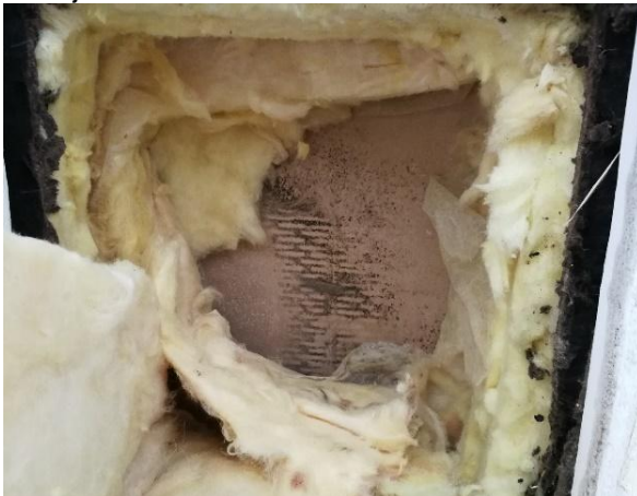
Kuva 26 Astianpesulinjaston kohdalle tehdyssä rakenneavauksessa todettiin selvä kosteusvaurio.
