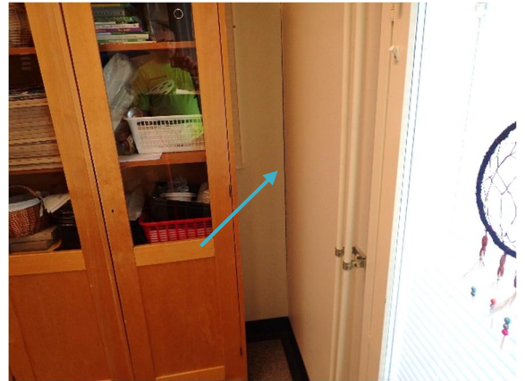
Kuva 38 Opettajanhuoneen ja luokkatilan 106 välisen väliseinän ja ulkoseinän liittymässä selvä rako.
