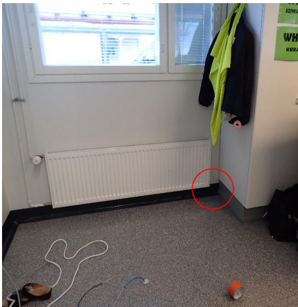
Kuva 10 Luokkatilassa 104 todettiin pistemäisiä ilmapuotokohtia kiinteän kaapin takaa alapohjan ja ulkoseinän liitoskohdassa.
