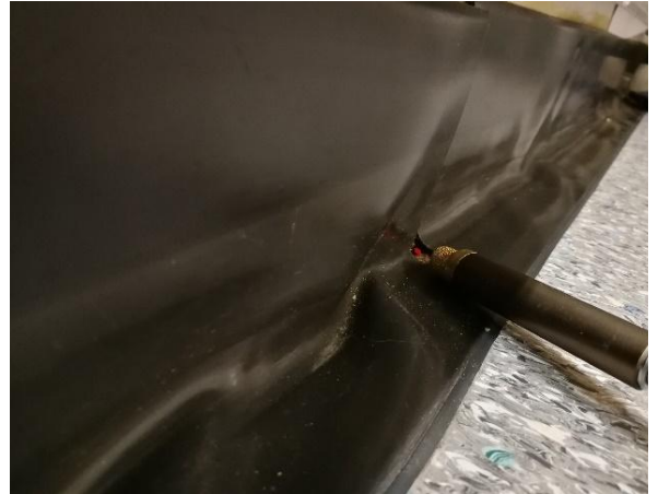
Kuva 35 Lattialista poimuttunut laatan painumisen johdosta luokkatilassa 104. Merkittävää ilmavuotoa alapohjan ja ulkoseinän liittymäkohdasta.
