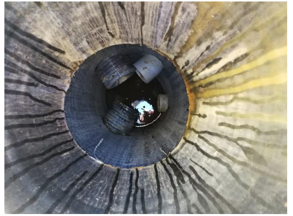
Kuva 7 Salaojien tarkastuskaivossa oli tarkastushetkellä vettä ja vettä valui salaojaputkista.
