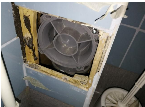
Kuva 8 Viemärin tuuletusputken juuressa havaittiin viitteitä kohonneesta kosteudesta lattiapinnalla.
