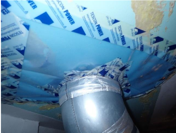
Kuva 50 Ilmanvaihtokanavien läpiviennit on tiivistetty höyrynsulkuteipillä ja ilmastointiteipillä, höyrynsulun läpivientikappaleita ei ole käytetty. Höyrynsulku teipattu kiinni ympäröivään levytykseen.
