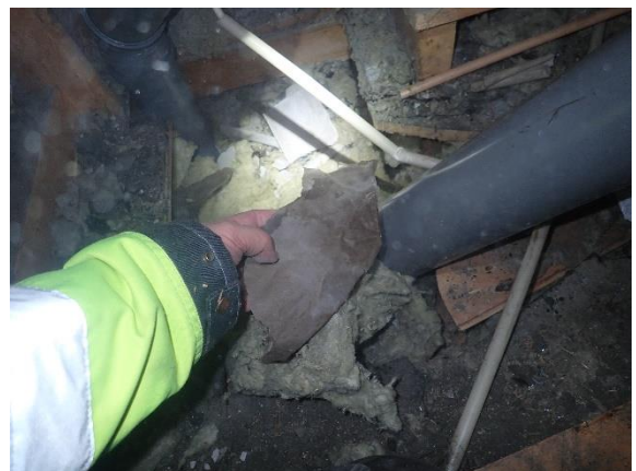
Kuva 45 Tuuletusputken läheisyydessä yläpohjaeristeiden päällä on paikallisia kosteusjälkiä.
