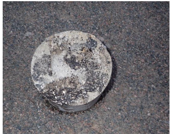
Kuva 10 Sokkelin rakenneavauslieriö. Sokkelin sisäpinnassa havaittavissa bitumisively. Sively ei ole yhtenäinen (kuva US1).
