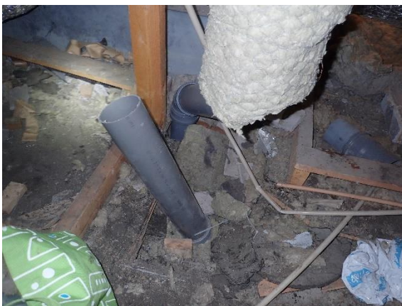
Kuva 44 Puutteellisesti lämmöneristetty viemärin tuuletusputki sekä vanhoja tuuletusputken kappaleita.
