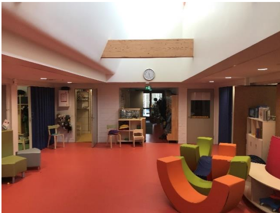
Kuva 15 Eteisaulassa 130 todettiin viiltomittauksissa kohonneita kosteuspitoisuuksia useammassa kohdassa.
