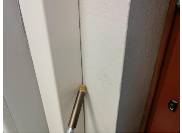
Kuva 29 Ilmavuotoa pilarin vieressä kulkevan sähkökaapelikoteloinnin takaa.
