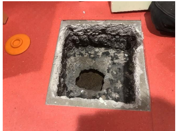
Kuva 16 Eteisaulaan tehtiin suurempi rakenneevaustus (AP11). Pohjalaatan pinnassa oleva bitumisively ei ollut yhtenäinen.
