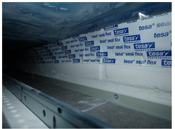
Kuva 49 Höyrynsulkumuovi on tiivistetty väliseiniin höyrynsulkuteipillä. Tiiliseiniä ei ole tasoitettu, jolloin tiilien sisempänä olevien saumakohden tiivistys on haasteellista ja höyrynsulku ei muodosta yhtenäistä ilmatiivistä kerrosta.
