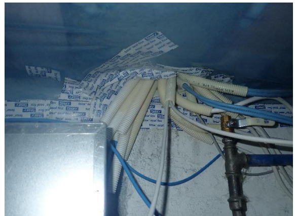
Kuva 53 Epätiivis sähköputkien läpivienti. Suojaputkia ei ole erikseen tiivistetty. Putkien välistä on avoimet ilmayhteydet yläpohjaan.
