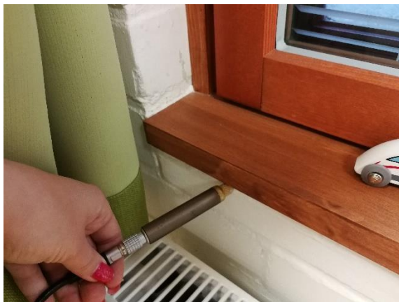
Kuva 26 Ilmavuotoa havaittiin ikkunaliittymissä.
