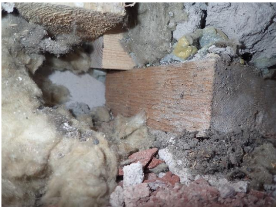
Kuva 25 Ruokasalin ikkunan alakulmaan tehdyssä avauksessa (US5) todettiin viite vauriosta mineraalivil-
