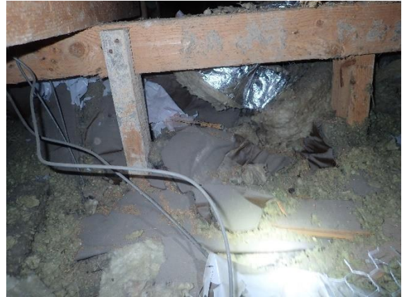
Kuva 41 Yläpohja on erittäin epäsiisti. Yläpohjatilassa on erilaista rakennusjätettä
