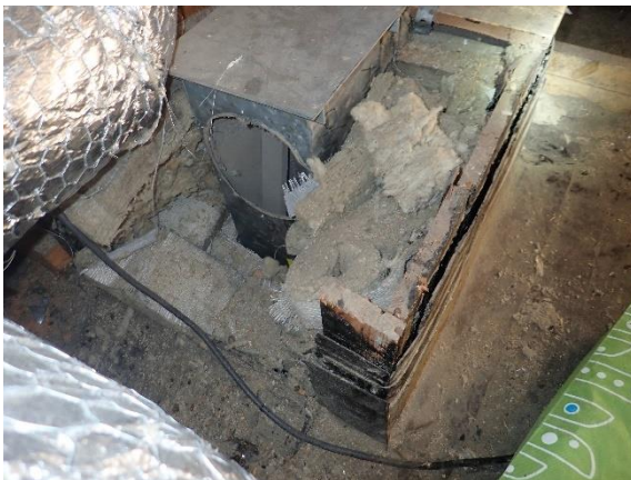
Kuva 38 Vanhoja ilmanvaihtolaitteiston osia ei ole purettu pois. Vanhat ilmanvaihtoputket ovat avoimina yläpohjatilassa
