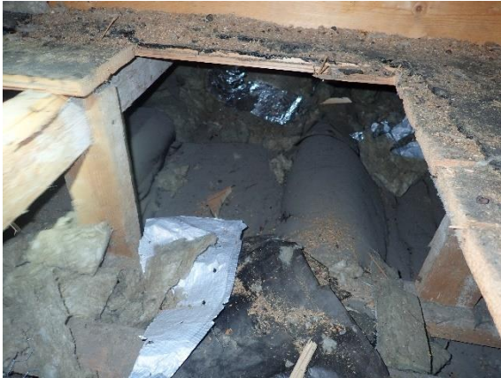
Kuva 40 Yläpohjassa on runsaasti erilaista rakennusjätettä.
