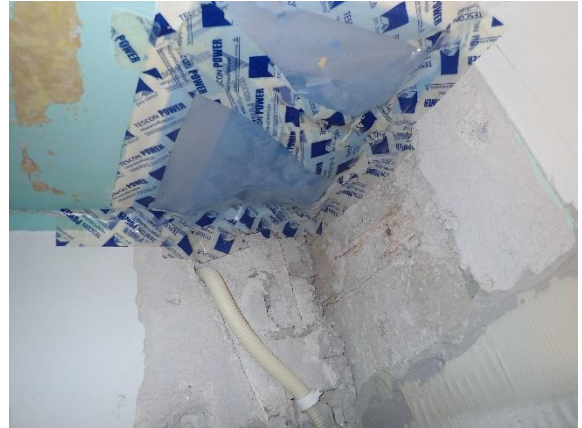
Kuva 51 Höyrynsulkumuovilla ja -teipillä tiivistetty vanha läpivienti. Teipin kiinnitys seinätasoihteeseen on heikko. Teipin ja seinän välistä on avoin ilmayhteys yläpohjaan.
