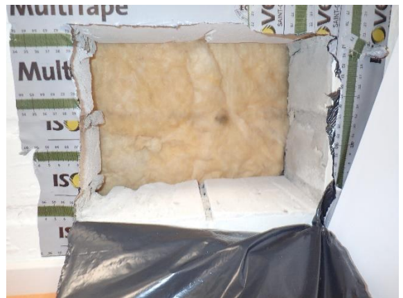
Kuva 12 Ryhmätilaan 132 sisäpuolelta tehdyssä rakenneavauksessa (US13) todettiin sokkelihalkaisusta otetussa näytteessä vahva viite vauriosta.
