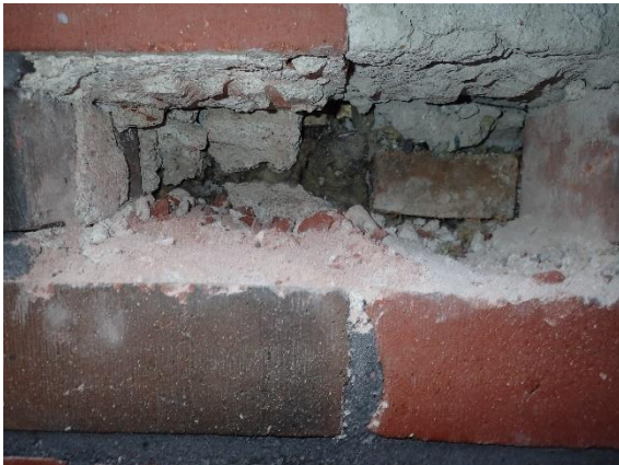
Kuva 23 Tiiliverhouksen takana näkyy laastipurseita, mikä heikentää tiilijulkisivun tuulettuvuutta (US5).
