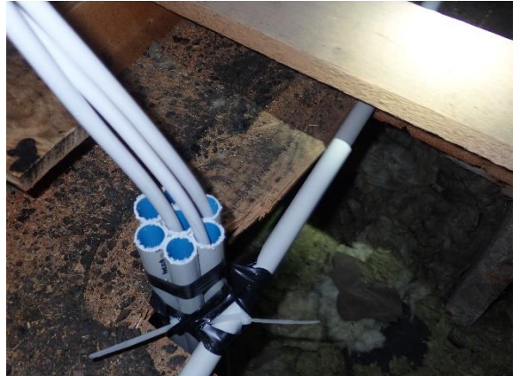
Kuva 47 Avoimia johdotusten suoja putkia yläpohjatilassa
