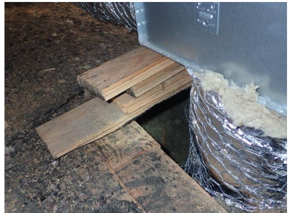
Kuva 43 Ilmanvaihtokanavia on tuettu lautakasoilla.
