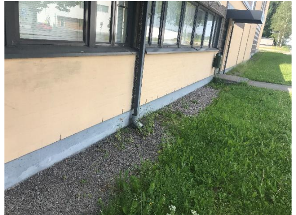
Kuva 10 Sisäntulojen yhteydessä olevilta katoksilta johdetaan kattovedet suoraan maahan sokkelin vierustalle, jolloin sokkeli- ja perustusrakenteille kohdistuu kosteusrasitusta.
