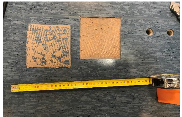
Kuva 30 Muovimattopinnoitteiden kuntoa tutkittiin kääntämällä pinnoitteita ja ottamalla VOC(bulk)-näytteitä. Kotitalousluokissa pinnoitteen alla oli havaittavissa normaalista poikkeavaa hajua.
