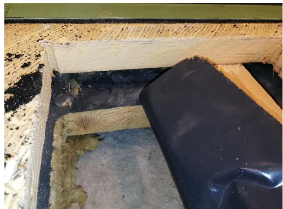
Kuva 38 Liikuntasalin lattian rakenneavaus. Betonilaatan päällä tai alapuolella ei ole vedeneristävää kerrosta.
