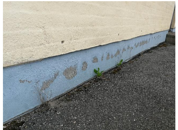
Kuva 18 Näkyviltä osin sokkelirakenteissa on havaittavissa kosteuden aiheuttamaa pinnoitteiden vaurioitumista.
