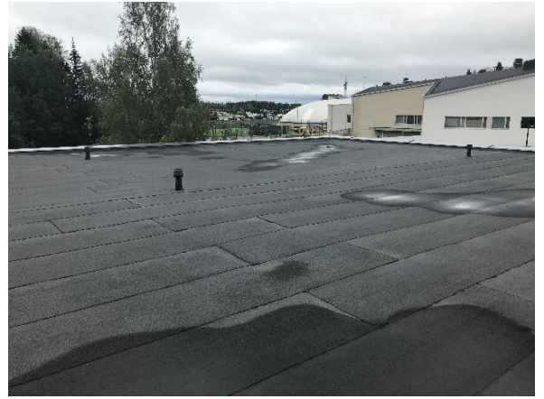
Kuva 81 Vesikatteet on uusittu 2005-2006 ja katteet ovat aistinvaraisesti arvioiden hyväkuntoisia.
