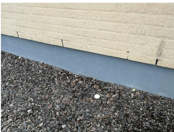
Kuva 51 Julkisivun tuulettuvuutta on jälkikäteen pyritty parantamaan avaamalla tiiliverhouksen pysytsaumoja ja tekemällä saumoihin reikiä.
