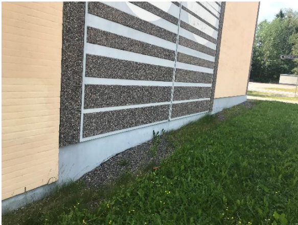
Kuva 3 Liikuntasalin ulkoseinä on osittain maan pinnan alapuolella.
