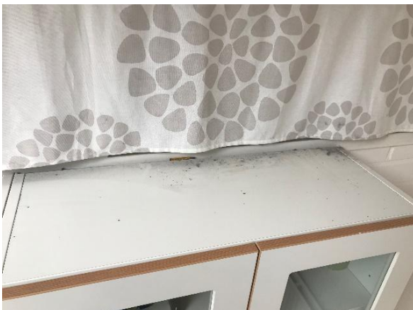
Kuva 98 Luokkatilassa 210 (kirjasto) myös korkeiden kaapistojen päällä runsaasti yläpölyä.
