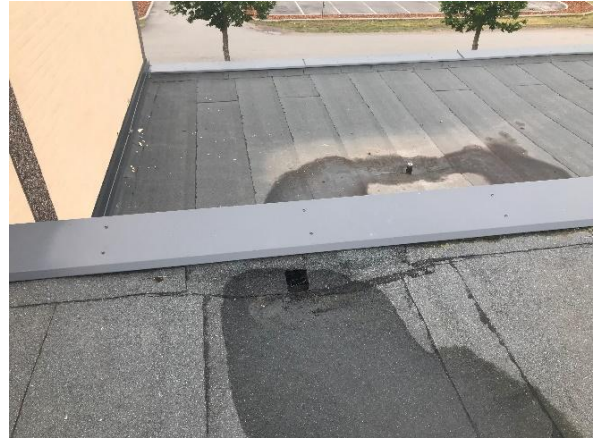
Kuva 85 Liikuntasalin ja auditorion välissä olevien ilmanvaihtokonehuoneiden vesikaton vedenpoisto toteutettu ulosheittäjällä alemman lappeen kautta.
