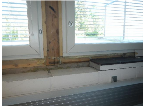
Kuva 54 Opettajanhuoneessa tehdyssä avauksessa ikkunan alkuperäisissä ala- ja pystypuissa ei ollut havaittavissa merkittäviä vuotojälkiä.
