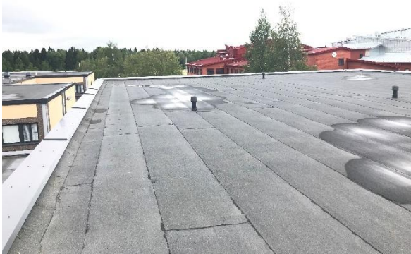
Kuva 82 Vesikate on yleisesti vielä hyväkuntoinen ja teknistä käyttöikä on vielä jäljellä.
