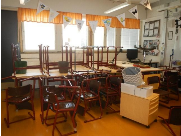
Kuva 57 Opetustilassa 11 on rakennuksen käyttäjien toimesta havaittu poikkeavaa hajua. Haju oli paikallistettavissa ulkoseinärakenteeseen.
