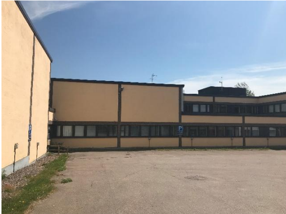
Kuva 7 Sisäpihan puolella maanpinnan kallistukset ovat rakennukseen päin. Opettajanhuoneiden edustalla on nurmikkoa. Nurmialueen kohdalla sokkelia vasten ei ole asennettu patolevyä.
