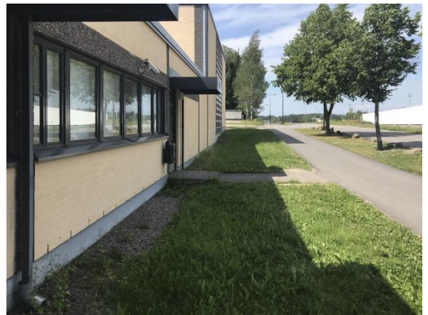
Kuva 6 Rakennuksen koillisen puoleisella seinustalla maanpinta viettää rakennukseen päin.
