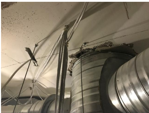
Kuva 92 Ilmanvaihtokanavan läpivientä ei ole tiivistetty. Ilmavuodot IV-konehuoneesta ovat mahdollisia.
