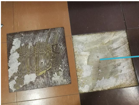
Kuva 27 Huonetila 136, eteishalli. 1. kerroksen vinyylilaattojen alla oli selviä kosteuden aiheuttamia vauriojälkiä ja vinyylilaattojen alustat sekä liima-aineet ovat aistinvaraisesti pilaantuneita.
