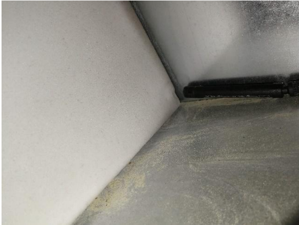
Kuva 105 Tuloilmakanavan päätelaitteella havaittavissa keltaista siitepölyä. Kuva toisen kerroksen käytävälästä 227.
