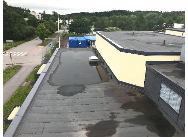
Kuva 87 Rakennuksen itäkulmauksessa vesi lammikoituu voimakkaasti. Kattokaivon roskasihti tukkeutunut.
