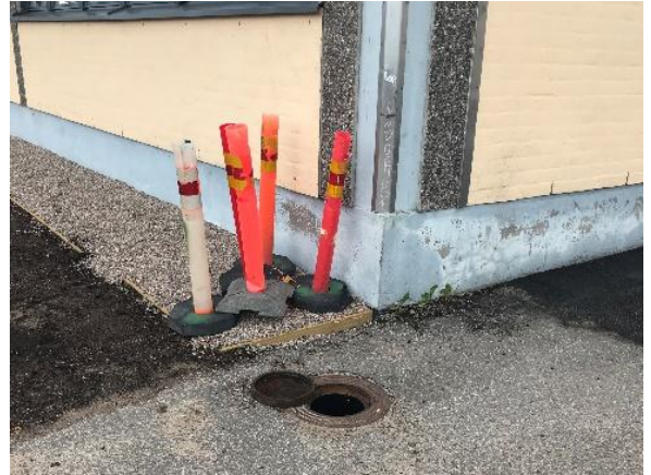
Kuva 14 Yleiskuva salaojien tarkastuskaivosta rakennuksen pääsisäänkäynnin puoleisella alueella.
