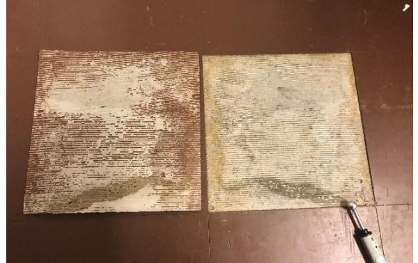
Kuva 26 Huonetila 188, voimisteluvälinetila. Vinyylilaatan alusta ja liima-aine ovat pilaantuneita kosteuden vaikutuksesta. Liima-aine on haisevaa ja pistävän hajuista.
