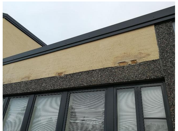
Kuva 50 Musiikkiluokan yhteydessä olevan varastohuoneen 1122 ulkoseinän yläosassa pakkasrapautumaa.
