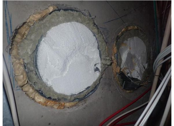
Kuva 95 Vahtimestarin huoneen (1103) alakattojen päällä epätiivittä, vanhoja IV-kanavien läpivientejä yläpohjaan. Ilmavuodot yläpohjasta mahdollisia.
