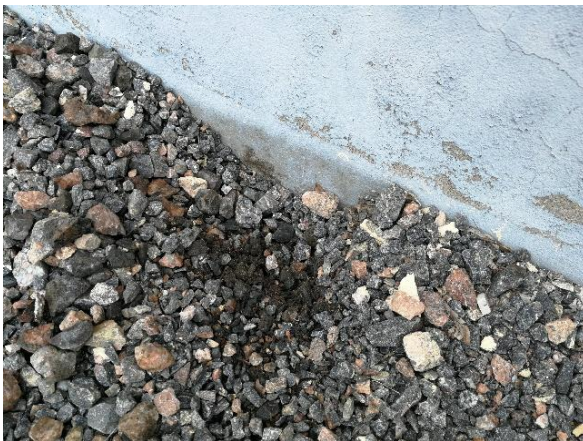
Kuva 5 Liikuntasalin lounaan puoleisella (sisäpihan) puoleisella seinällä ei patolevyä havaittu ollenkaan.
