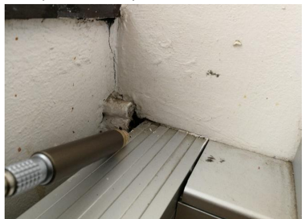
Kuva 68 Ulkoseinissä vanhoja läpivientejä, joista havaittiin selvää ilmavuotoa.
