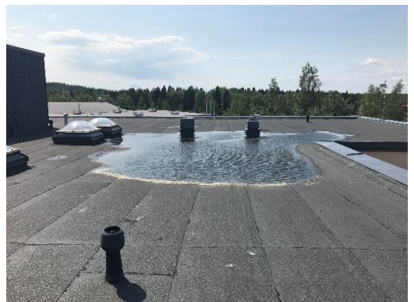
Kuva 89 Lammikoitumista myös ruokasalin kohdalla.
