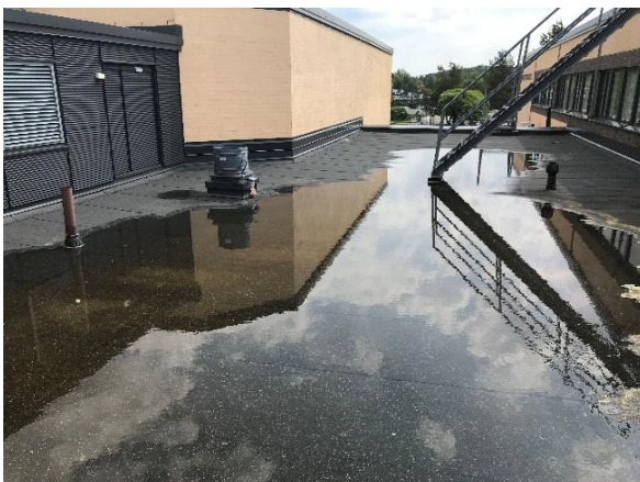
Kuva 88 Sisääntuloaulan päällä suuri vesilammikko, kattokaivon roskasihti tukkeutunut.
