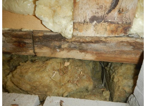
Kuva 58 Opetushuoneessa 11 ikkunan alkuperäisessä ala- ja pystypuussa selviä vanhoja vesivuotojälkiä. Rakenneavauksesta oli havaittavissa selvästi mikrobivaurioon viittaavaa hajua.
