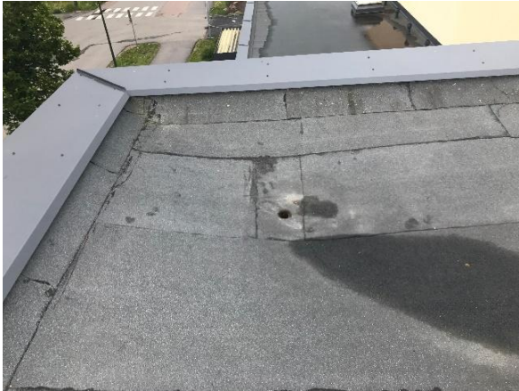
Kuva 86 Liikuntasalin vesikattoa. Kattokaivosta puuttuu roskasihti.
