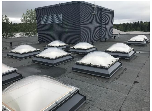
Kuva 83 Rakennuksessa on useampia kattoikkunoita, jotka on uusittu 2005. Kattoikkunat ovat yleisesti vielä hyväkuntoisia, näkyviä sisäpuolisia vesivauriojälkiä ei havaittu.
