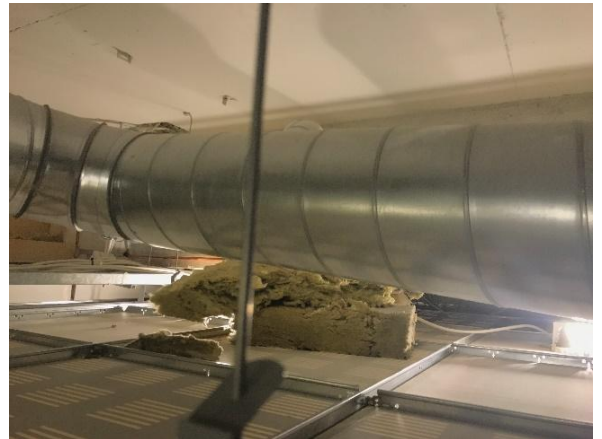
Kuva 91 Alakattojen päällä havaittiin toisessa kerroksessa, useammassa kohdassa mineraalivillaeristepaloja.
