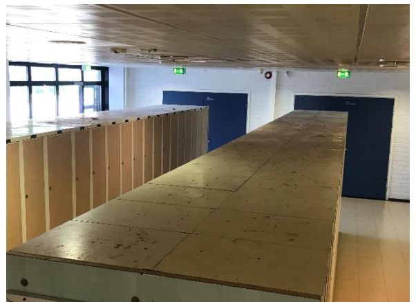
Kuva 99 Sisäntuloaulan yhteydessä olevien kaapistojen päällä runsaasti yläpölyä.
