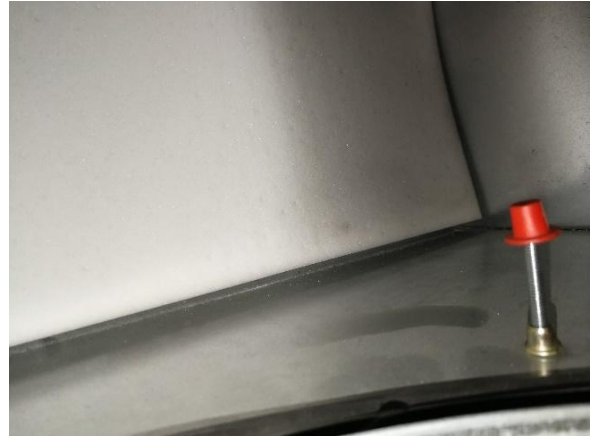
Kuva 106 Tuloilmakanavan päätelaite ensimmäisen kerroksen eteishallissa 129. Päätelaitteen pinnalla jonkin verran pölyä.
