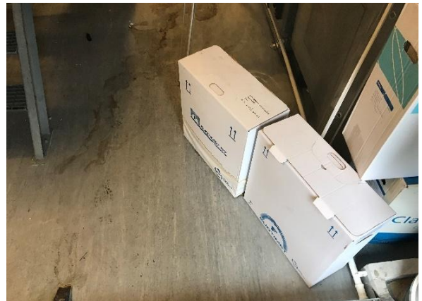
Kuva 108 Ilmanvaihtokonehuoneissa havaittiin kastuneita ilmansuodatinlaatikoita. Kastuneita suodattimia ei saa käyttää.
