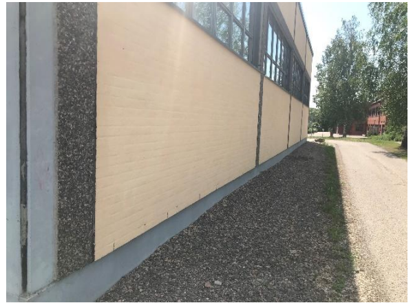
Kuva 4 Liikuntasalin pohjoispäädystä patolevyn reuna jää paikoitellen maanpinnan alapuolelle.
