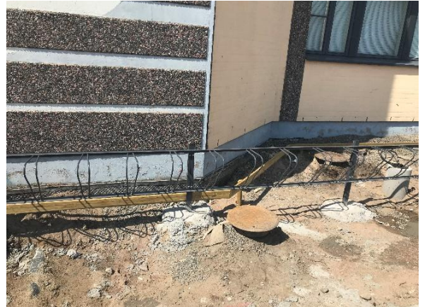
Kuva 8 Patolevyt on asennettu 2005-2006 perusparannuksen yhteydessä. Patolevyt selvästi havaittavissa pihan ollessa kaivettuna auki rakennuksen kaakkoispuolella.
