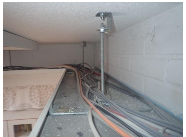
Kuva 93 Luokkatilassa 210 (kirjasto) kaapelikourujen päällä runsaasti pölyä ja rakennusmateriaalipölyä.
