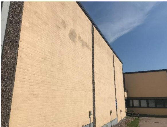
Kuva 49 Liikuntasalin julkisivun yläosassa tiilipinnoilla pakkasrapautumaa, joka paikattu.
