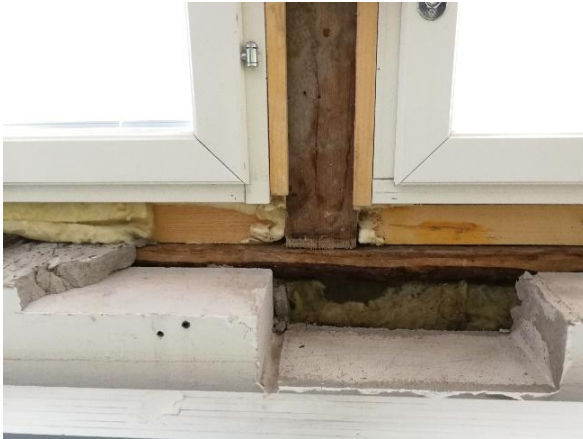
Kuva 53 Ikkunarakenteen alkuperäisissä alapuissa ja pystypuissa on vanhoja vesivuotojälkiä (kotitalousluokka 164).
