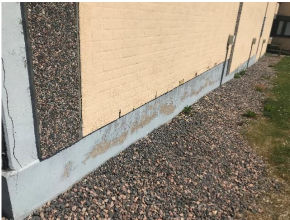
Kuva 17 Sokkelirakenteissa on havaittavissa kosteuden aiheuttamaa pinnoitteiden vaurioitumista. Liikuntasalin luoteiskulmauksessa maanpintatason yläpuolella ei ollut havaittavissa sokkelin kosteuseristeenä käytetyn patolevytyksen yläreunaa.
