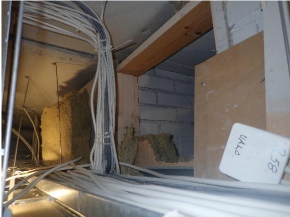
Kuva 94 Toisen kerroksen fysiikka-kemia-luokkien läheisten wc-tilojen yhteydessä runsaasti mineraalivillaaeristettä alakattojen päällä.
