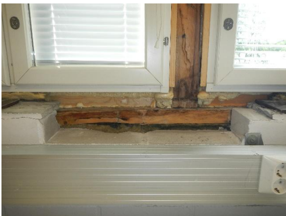
Kuva 55 Toisen kerroksen fysiikka-kemia 2 (233), ikkunan rakenteessa runsaasti vanhoja vesivuotojälkiä.
