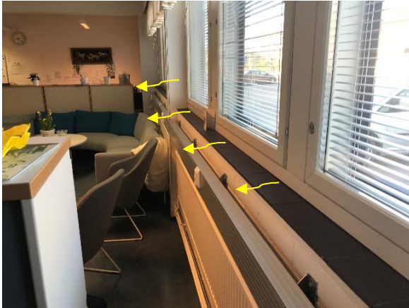
Kuva 63 Tyypillinen ikkunaliittymä. Merkkiainekokeiden perusteella ulkoseinän lämmöneristeeseen johdettu merkkiainekaasu kulkeutuu ikkunaliittymistä sisäilmaan päin.
