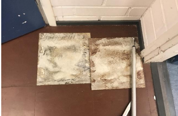
Kuva 25 Huonetila 183, voimisteluvälinetila. Vinyylilaatan alusta ja liima-aine ovat pilaantuneita kosteuden vaikutuksesta. Liima-aine on haisevaa ja pistävän hajuista.
