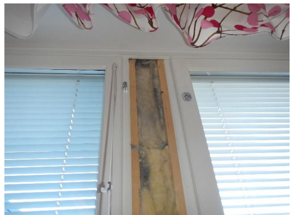
Kuva 56 Pystypuiden sisäpuolella olevassa lämmöneristeessä ilmavuotojen aiheuttamaa tummentumaa. Rakenne ei ole tiivis sisätiloihin nähden (fysiikka-kemia 2).
