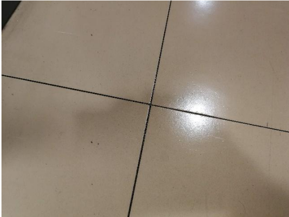
Kuva 31 Ensimmäisessä kerroksessa vinyylilaattojen saumoissa on havaittavissa selviä rakoja. Avomien saumojen kautta pinnallisten vesien tunkeutumisen laatan alle.
