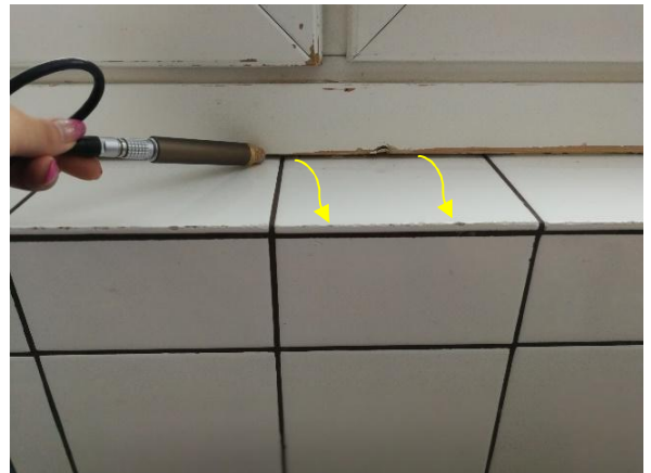
Kuva 66 Merkittäviä ja toistuvia ilmavuotoja havaittiin ikkuna- ja ulkoseinäliittymissä.
