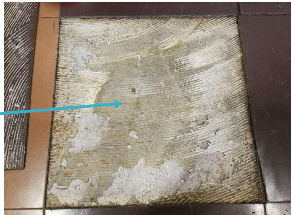
Kuva 28 Valkoiset jäljet betonin päällä olevassa tasoitteessa laatan reuna-alueilla ovat poikkeavan kosteuden aiheuttamia.
