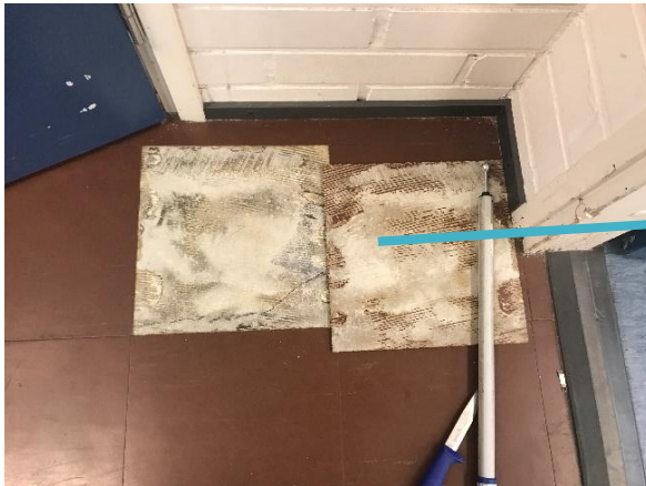
Kuva 39 Huonetila 183, esimerkki pintakosteushavain- noin kosteaksi todetusta alueesta. Betonipinta on pintakosteushavainnoin märkä (Gann 128, normaali n 50-70).
