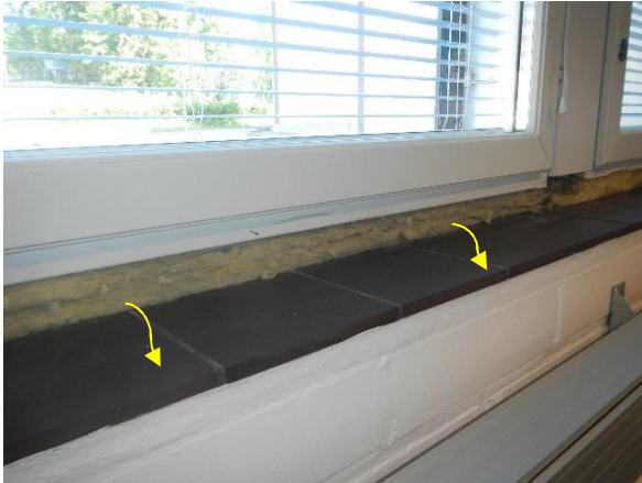
Kuva 69 Ikkunalista poistettuna. Ikkunan alta on avoin ilmayhteys seinän eristetilaan.
