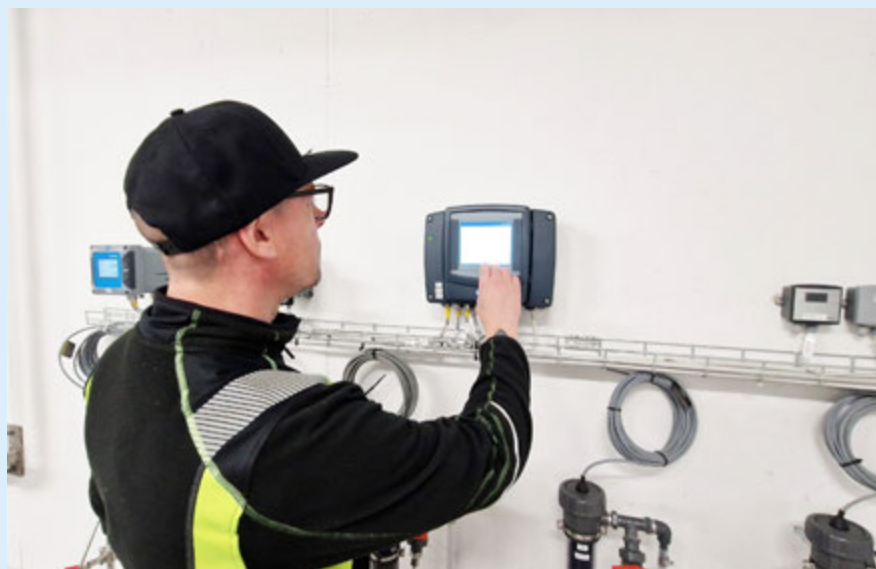
Vesilaitoshoitaja Jesse Ojanen säätää tekopohjavesilaitoksen pH:n mittalaitteita.
