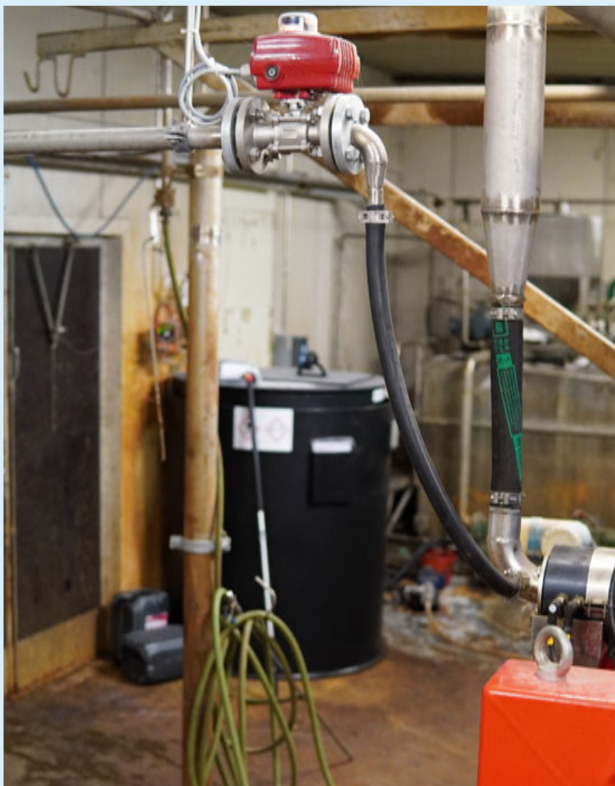
Kirkonkylän nykyisen jätevedenpuhdistamon laitteistoja
