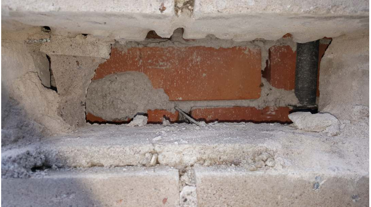
Kuva 14. Seinärakenteesta puuttuu lämmöneristeet ja muista rakenneavauksista poiketen runkorakenteena on tiilimuuraus. Seinän takana on lämmönjakohuone
