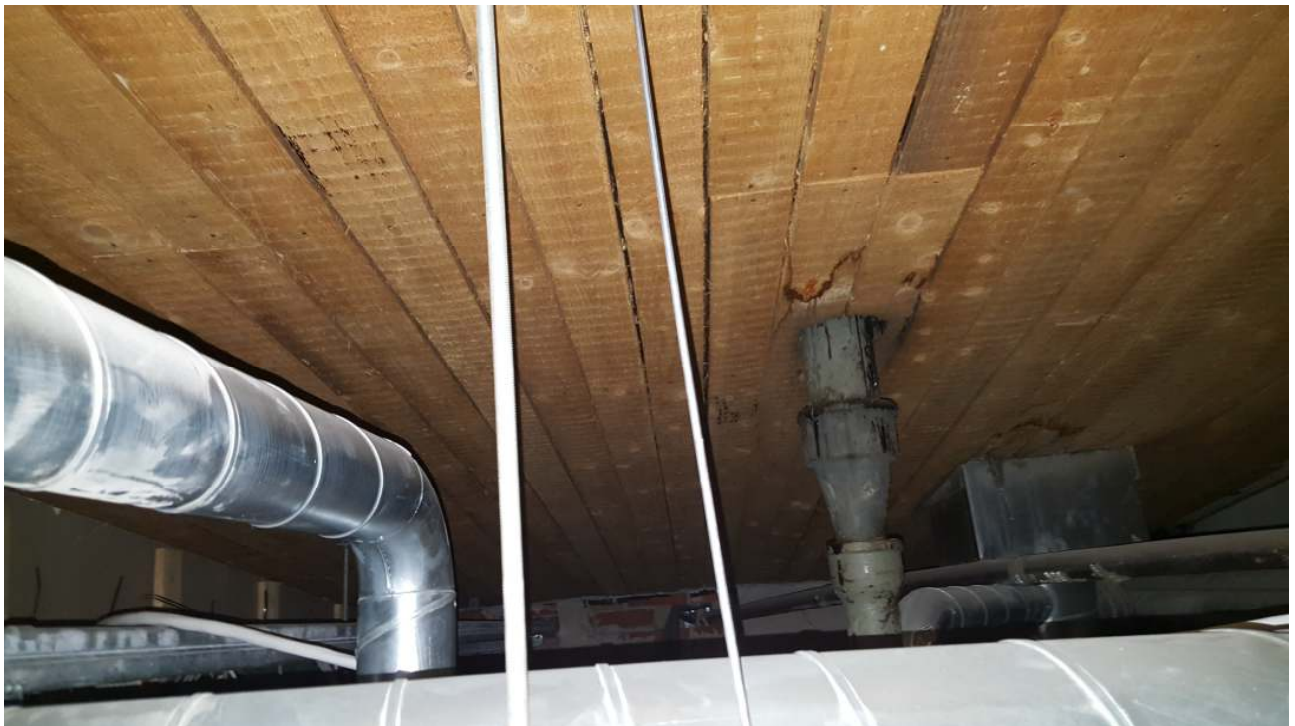
Kuva 39. Yleiskuva opon työhuoneen 105 alaslaskutilasta. Yläpohjan koolauspuussa on vesivuotojälkiä läpivientien kohdalla. Alaslaskutilasta havaittiin voimakas ilmavirtaus työhuoneeseen päin.
