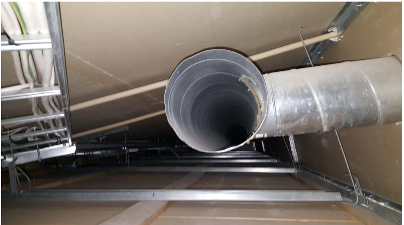
Kuva 41. Yleiskuva luokkatilan 160 alaslaskutilasta. Poistoilmakanavan päästä puuttui ”tulppa”. Tilaajalta saatujen tietojen mukaan ilmanvaihto on puhdistettu ja säädetty viimeisen vuoden aikana. Puuttuva kanavan ”tulppa” löytyi alaslasketun katon päältä ja huoltohenkilökunta asensi sen takaisin paikoilleen.
