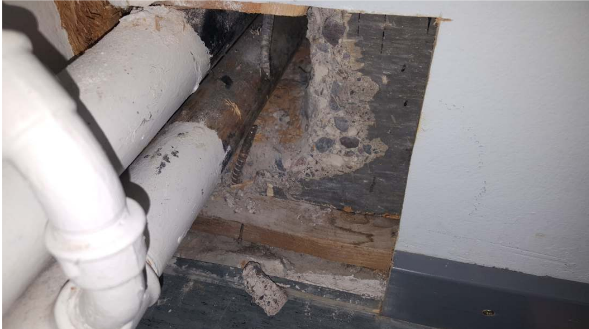
Kuva 58. Luokan 160 väliseinän ja ulkoseinän liittymän kohdalla havaittiin liuottimen/polttonesteen tyyppistä hajua, haju vaikutti tulevan väliseinässä olevan patteriputkien läpiviennin kohdalta. Seinän sisäverhouslevy poistettiin. Näytteenottoaika 1.
