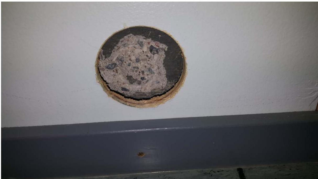
Kuva 59. Luokan 160 väliseinän ja ulkoseinän liittymän kohdalla havaittiin liuottimen/polttonesteen tyyppistä hajua, haju vaikutti tulevan väliseinässä olevan patteriputkien läpiviennin kohdalta. Seinän sisäverhouslevy poistettiin keskeltä seinälinjaa, ko. kohdassa samaa hajua ei havaittu. Näytteenottoaika 2.
