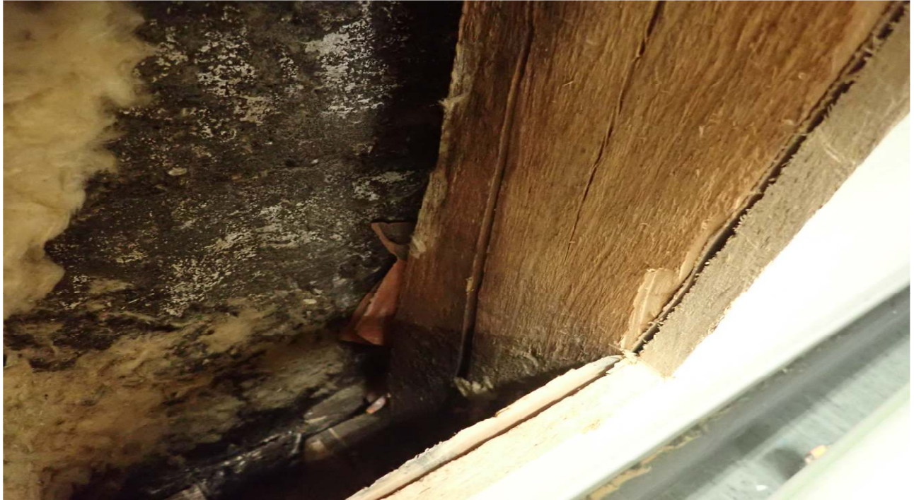
Kuva 2. Yleiskuva tutkimuspaikasta. Pystyrunkopuussa on näkyvissä vesivuotojälkiä. Betonisokkelin taustapinnassa on bitumisively. Lämmöneristeet ovat kiinni betonisokkelissa.
