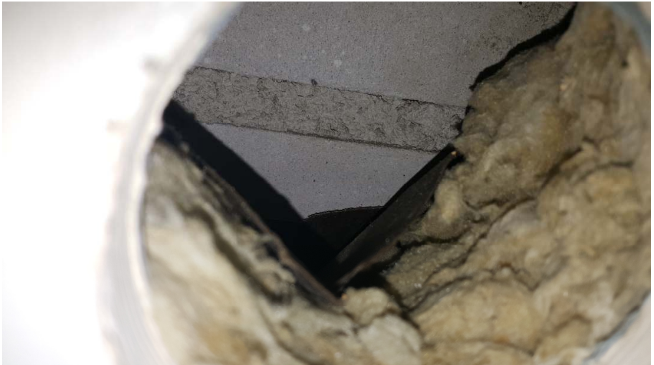
Kuva 13. Lämmöneristeen ja tiiliverhouksen välissä ei ole tuuletusrakoa, tuulensuojana on tervapaperi.
