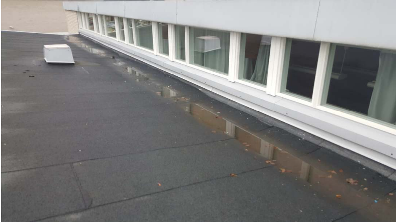
Kuva 46. Yleiskuva vesikatolta tasoerojen kohdalla, vesi lammikoituu seinän vierustalla. Mikäli kaivot tukkeutuvat/padottavat, ohjautuu vesi päädyn yli. Ko. tilanteessa on myös mahdollista että vesi nousee ikkunapellitysten alle ja sieltä seinärakenteen sisälle.
