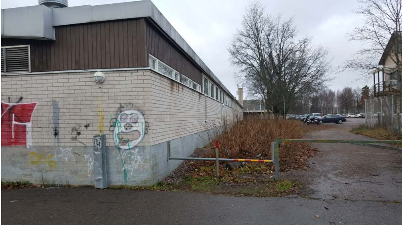
Kuva 55. Kuva ylärinteen puolelta (opetus-/luokkatilat 160-167 kohdalta). Maanpinnan kallistukset ovat paikoin puutteellisia.
