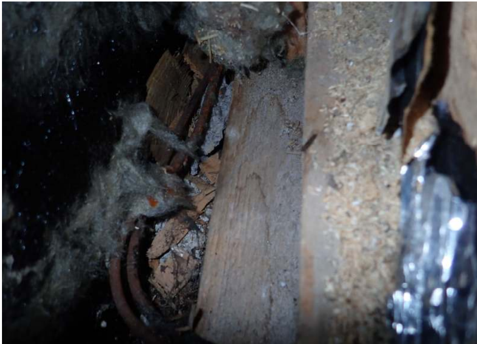
Kuva 9. Alaohjauspuussa on vuotojälkiä.
