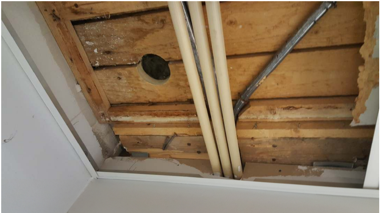
Kuva 35. Lautakoolauksissa on vuotojälkiä.
