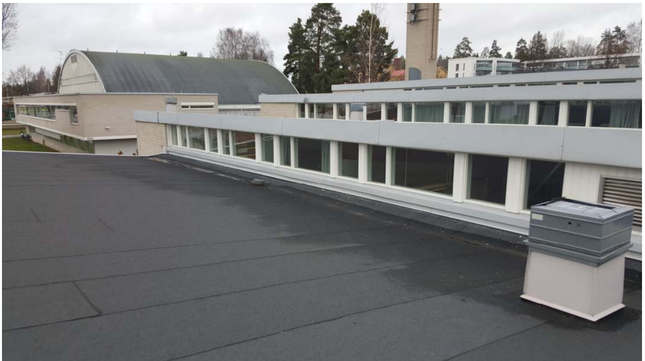
Kuva 45. Yleiskuva vesikatolta tasoerojen kohdalla, vedet ohjautuvat seinää vasten.
