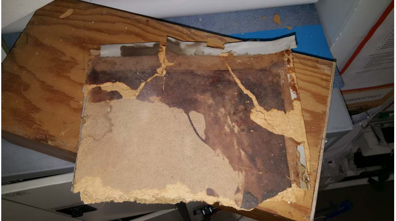
Kuva 34. Alkuperäisen sisäkattoverhouslevyn taustassa on laajoja vuotojälkiä.
