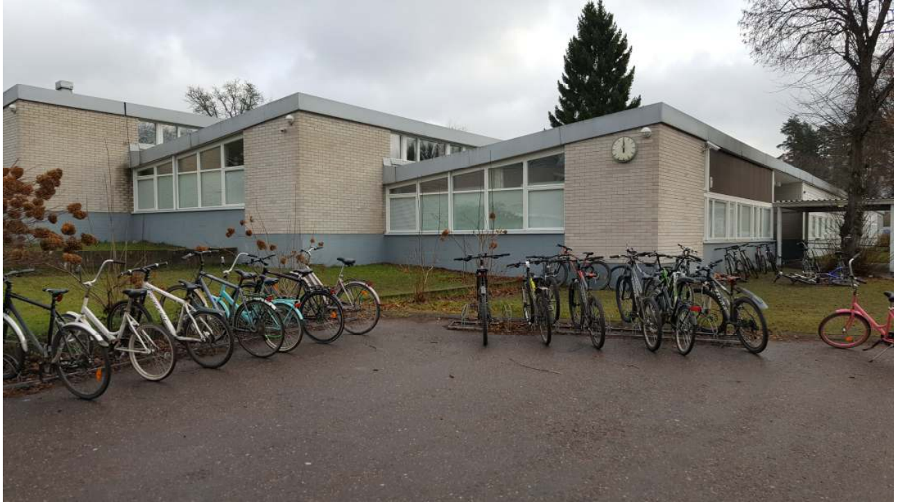
Kuva 53. Rakennus sijaitsee rinteessä, tilojen lattiapinnat ovat paikoin maanpinnan tasossa/hieman maanpintaa alempana. Maanpinnan kallistukset ovat paikoin puutteellisia. Betonisokkeli ulottuu ikkunoiden alareunan tasolle.
