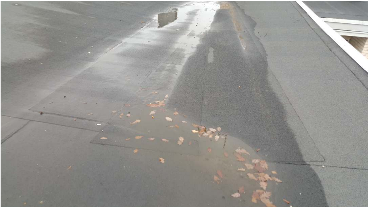
Kuva 43. Yleiskuva vesikatolta. Vesikatetta on paikkakorjattu jollain aikavälillä. Vesi lammikoituu paikoin.
