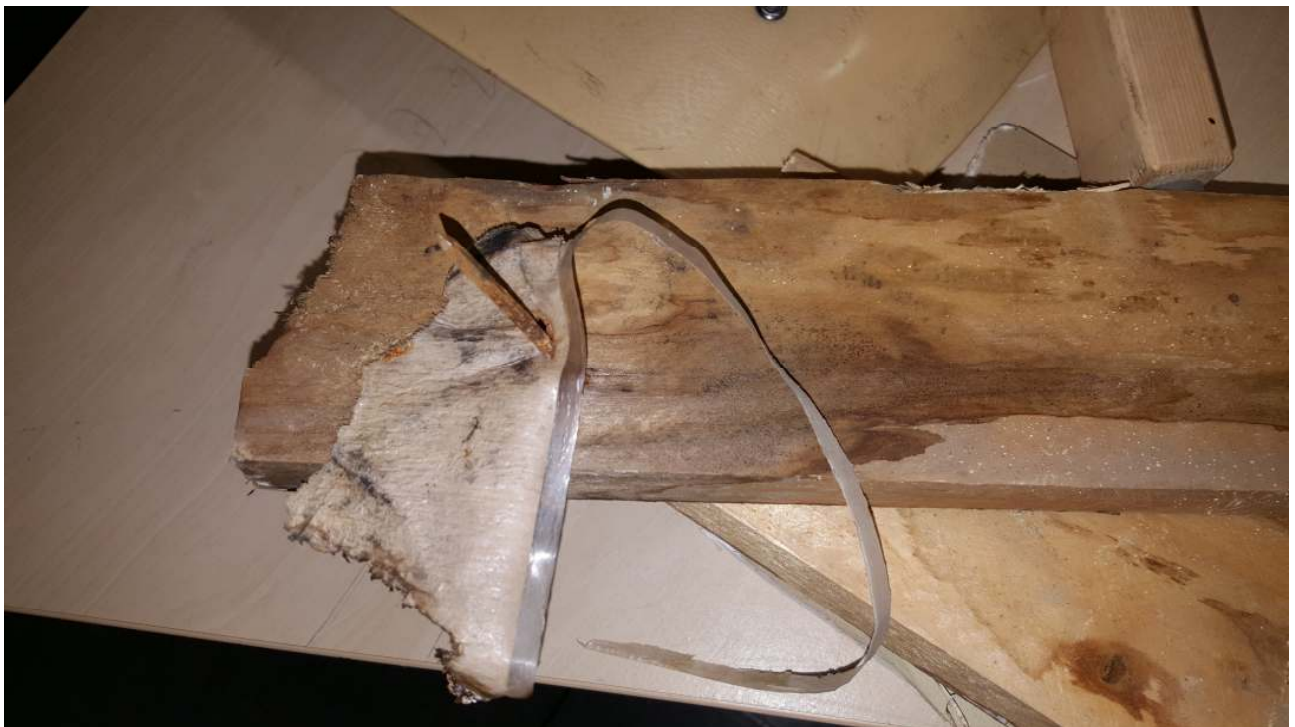
Kuva 30. Alaslaskun runkokuussa on veden valumajälkiä, joita todettiin myös paneelien taustassa.
