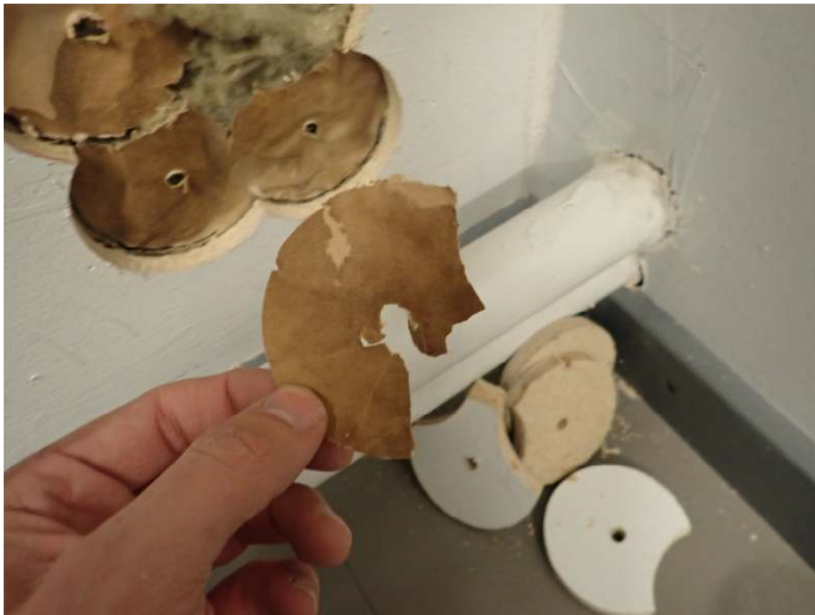
Kuva 25. Höyrinsulkupaperissa on vuotojälkiä.
