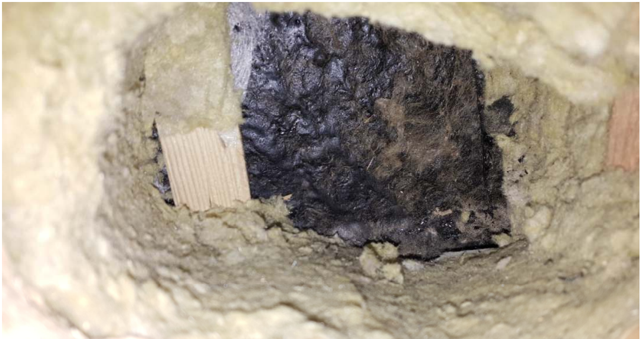
Kuva 21. Seinärakennetta on korjattu jollain aikavälillä, lämmöneristeet on uusittu. Lämmöneristeinä on tuulensuojapinnoitettu kivillä, joka on kiinni betonisokkelissa. Sokkelin taustapinnassa on pikisively.
