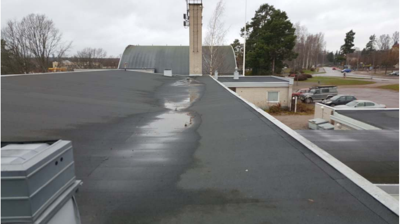
Kuva 42. Yleiskuva vesikatolta. Vesikatetta on paikkakorjattu jollain aikavälillä.
