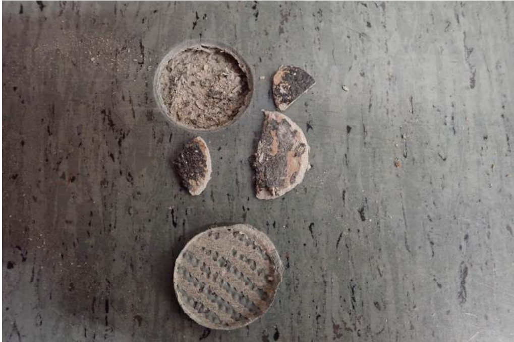
Kuva 56. Luokan 167 lattian muovimaton ja tasoitteen alla on vanha musta liima.
