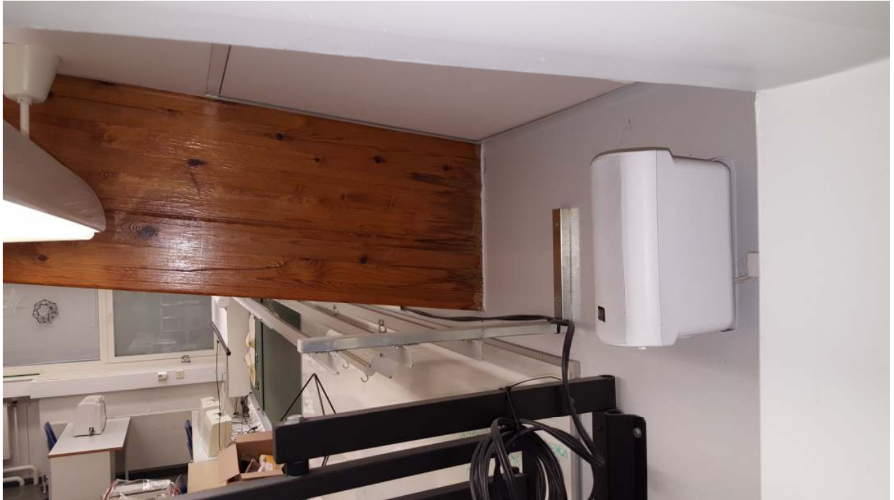
Kuva 38. Yleiskuva luokkatilasta. Liimapuupalkin päässä on vesivuotojälkiä.
