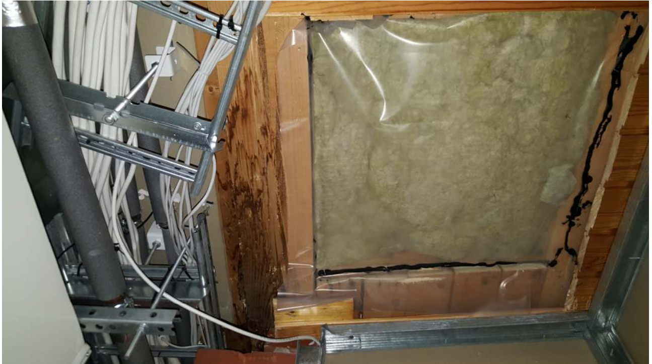
Kuva 29. Yleiskuva tutkimuspaikasta. Alaslaskun runkokuussa on veden valumajälkiä, joita todettiin myös paneelien taustassa.
