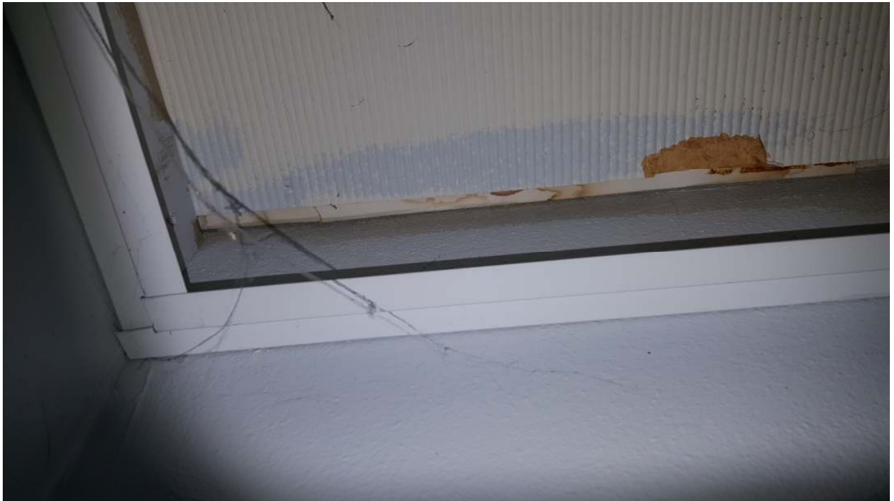
Kuva 33. Yleiskuva tutkimuspaikasta. Alkuperäisessä sisäkattoverhouslevyssä on vuotojälkiä.
