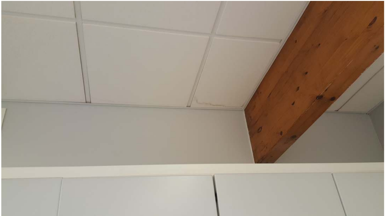
Kuva 36. Yleiskuva tutkimuspaikasta. Alaslasketun katon sisäkattoverhouslevyssä on vuotojälkiä.
