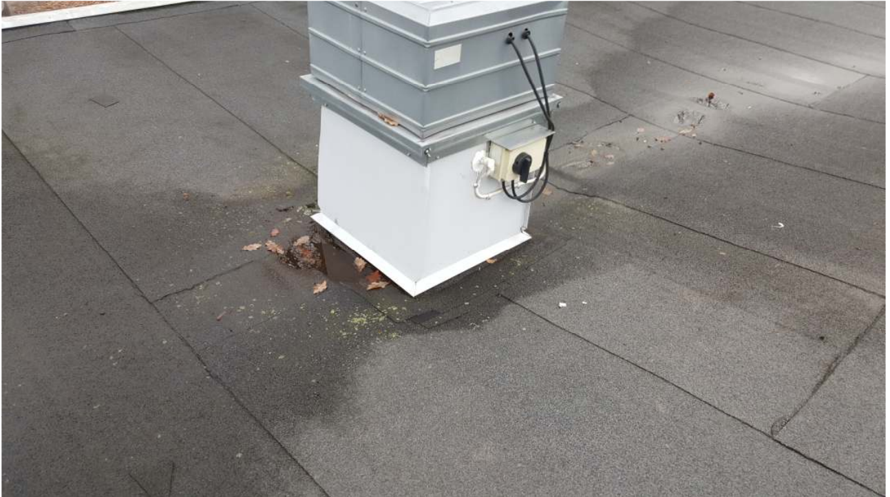
Kuva 48. Sadevesi lammikoituu läpiviennin vierustalla. Alapuolella havaittiin ko. kohdassa (luokka 160) vesivuotoa, jota huolto kävi selvittämässä ja korjaamassa tutkimuspäivän aikana.
