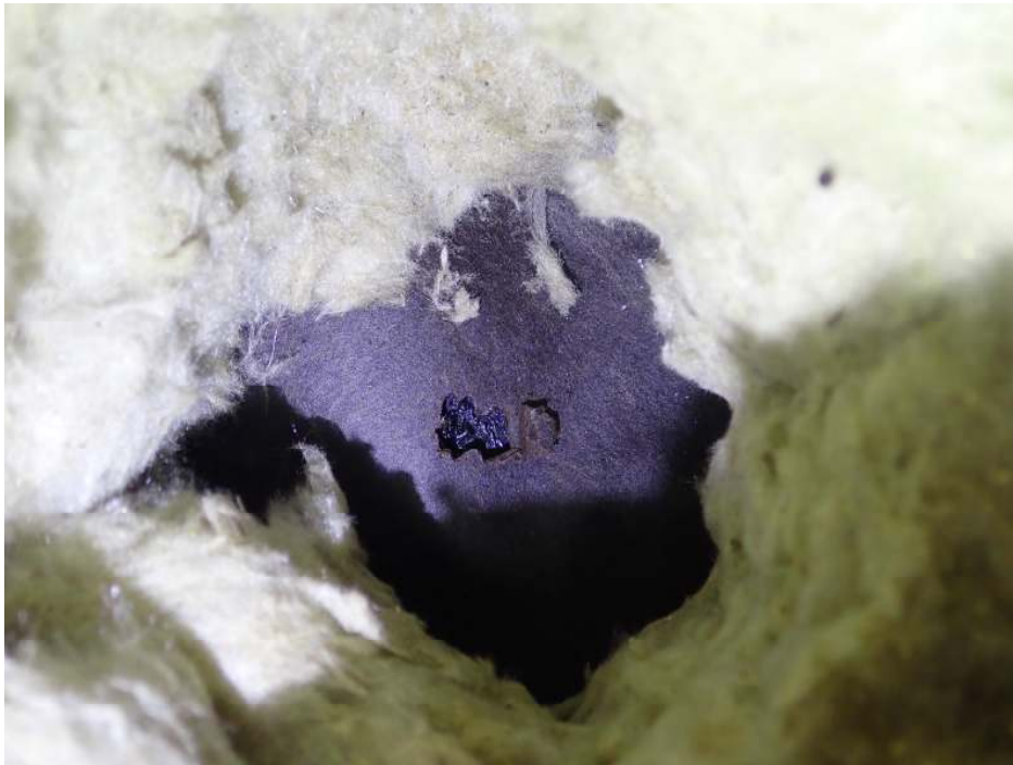
Kuva 7. Tervapaperi on kiinni betonisokkelissa, sokkelin taustapinnassa on bitumisively.
