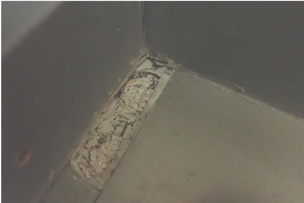
Kuva 57. Luokan 141 lattian vinyylilaatan ja tasoitteen alla on vanha liima.
