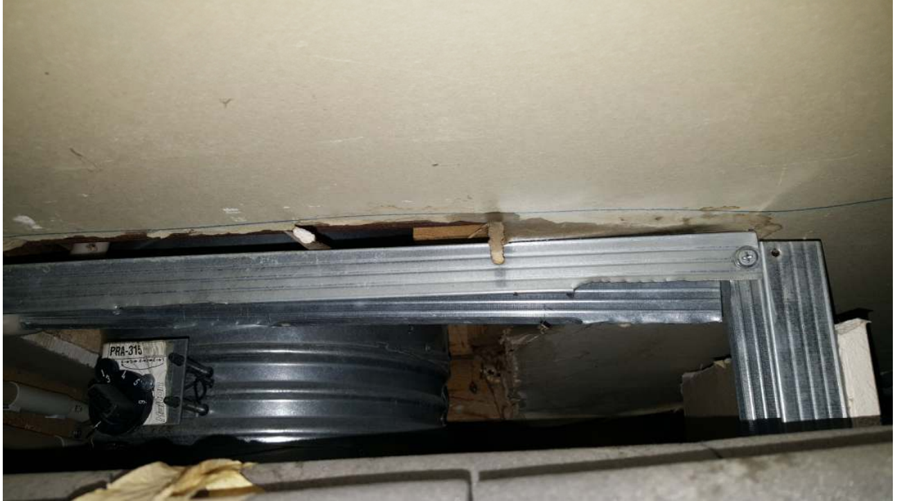
Kuva 40. Yleiskuva luokkatilan 160 alaslaskutilasta huippumurin läpiviennin kohdalta. Yläpohjan kipsilevy on märkä, vettä valui tutkimuksen aikana läpiviennin kohdalta. Läpiviennin kohdalta havaittiin voimakas ilmavirtaus luokkatilaan päin.
