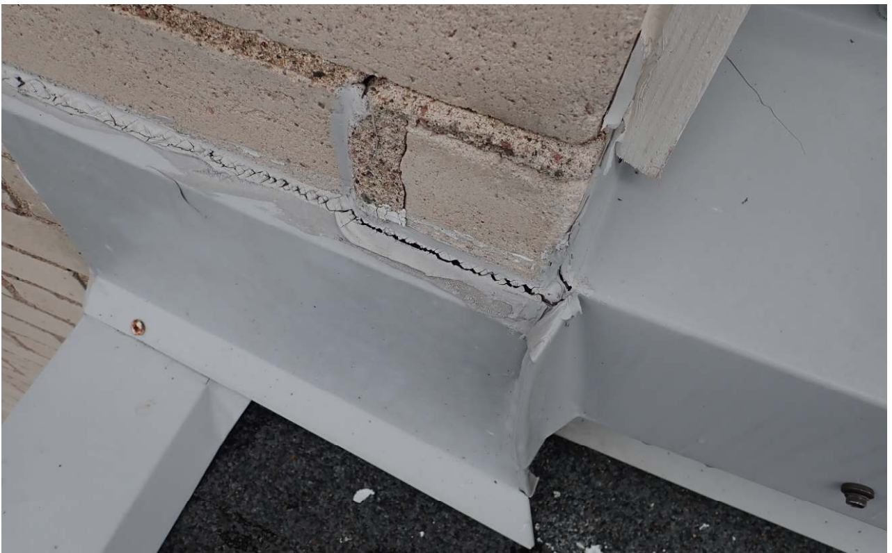
Kuva 49. Pellityksen ja tiiliverhouksen liitossauman saumamassa on revennyt.
