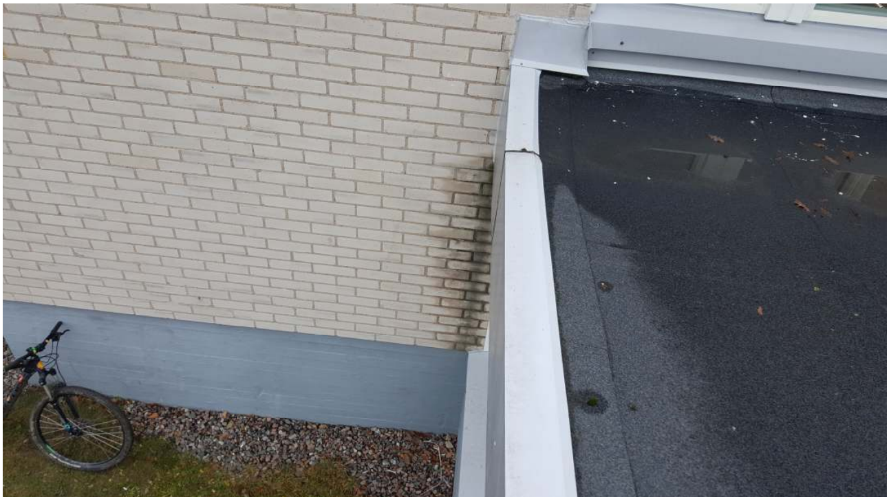
Kuva 47. Sadevesi pääsee valumaan tiiliseinälle. Suositellaan reunapeltien uusimista, uusi pelti muotoiltaan niin että se ohjaa sadeveden pois tiiliseinältä. Lisäksi suositellaan ulosheittäjäputkien asentamista mahdollisten kaivojen tukkeutumisen varalle. Kaivon padottaessa vesi ohjautuisi hallitusti talon päädystä ulosheittäjäputkien kautta.
