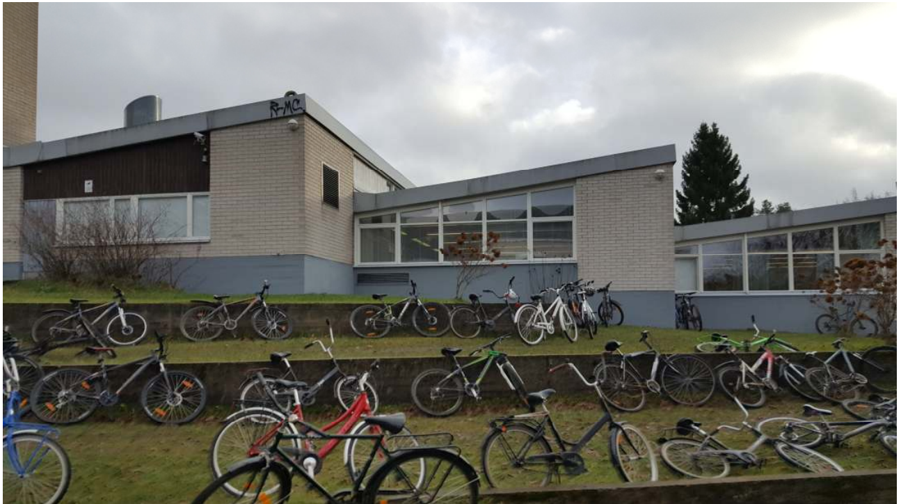
Kuva 54. Rakennus sijaitsee rinteessä, tilojen lattiapinnat ovat paikoin maanpinnan tasossa/hieman maanpintaa alempana. Maanpinnan kallistukset ovat paikoin puutteellisia. Betonisokkeli ulottuu ikkunoiden alareunan tasolle.
