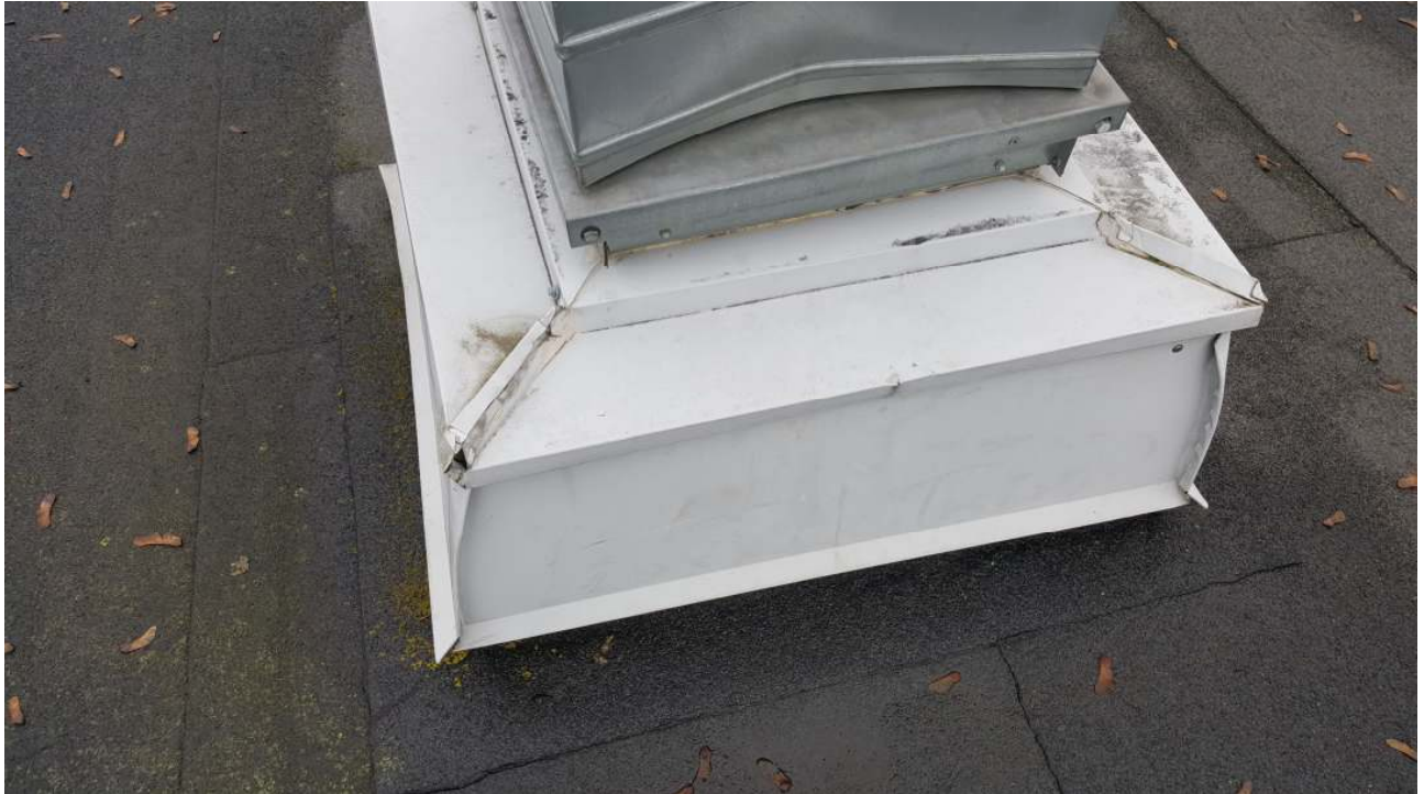
Kuva 50. Huippuimurin pellityksen saumat ovat vääntyneet auki, todennäköisesti ilkeivallan seurauksena.
