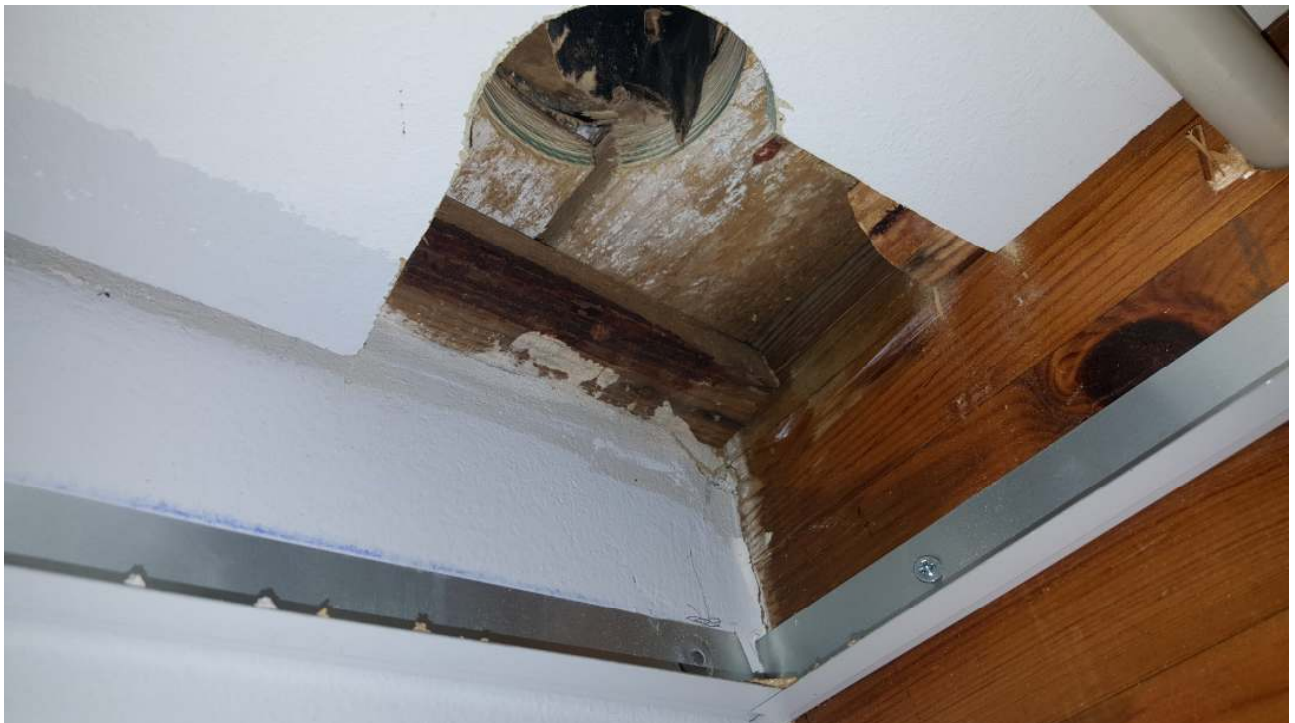
Kuva 37. Koolauspuissa ja liimapuupalkin yläreunassa on vuotojälkiä.
