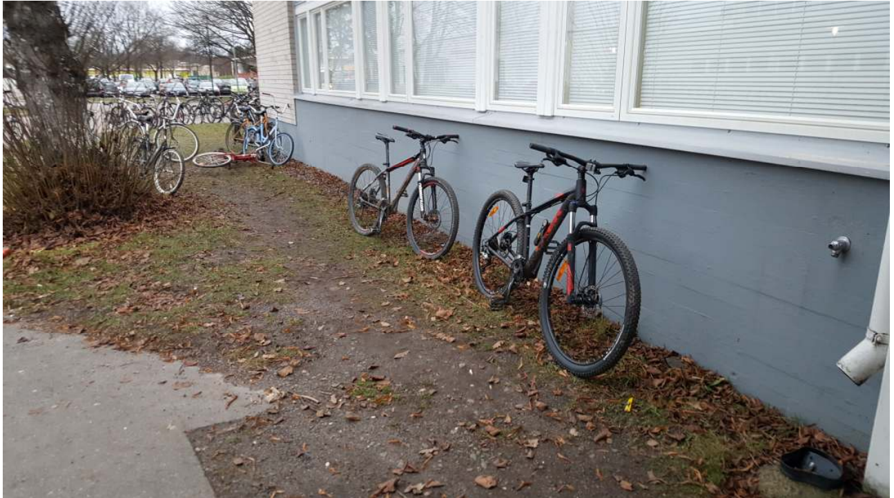
Kuva 51. Maanpinnan kallistukset ovat paikoin puutteellisia. Betonisokkeli ulottuu ikkunoiden alareunan tasolle. Sadevesisyöksyputki on liian lyhyt, kovemalla sateella vedet ohjautuvat ohi sadevesisuppilosta.
