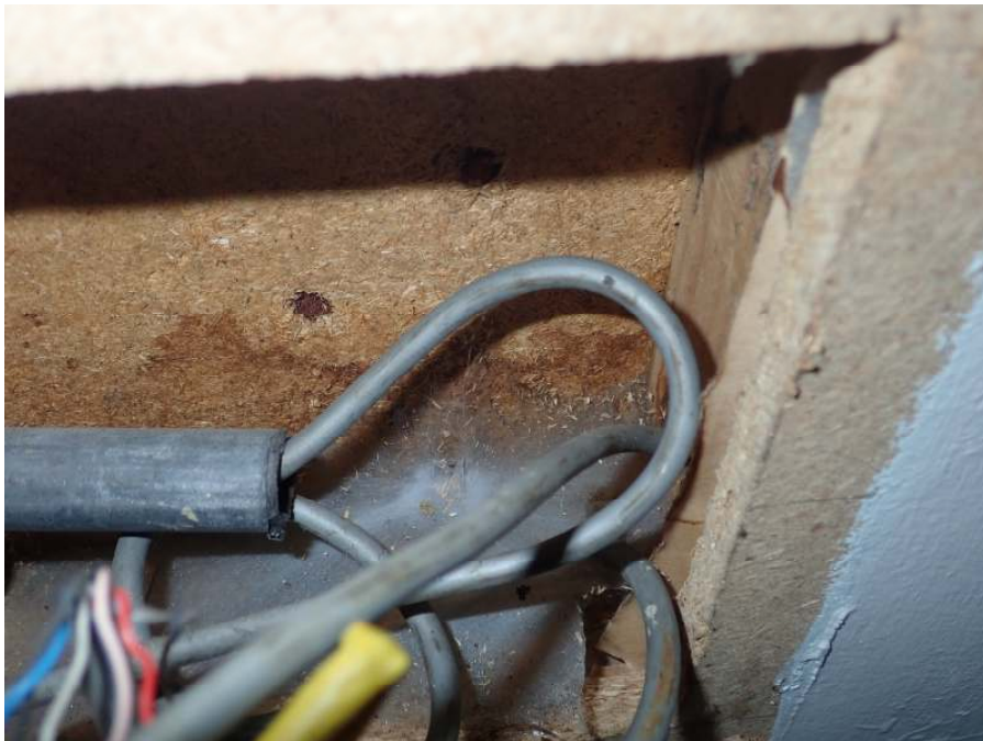
Kuva 23. Taustalevyssä on vuotojälkiä.
