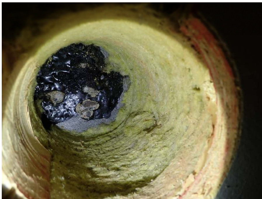
Kuva 19. Seinärakennetta on korjattu jollain aikavälillä, lämmöneristeet on uusittu. Lämmöneristeinä on tuulensuojapinnoitettu kivivilla, joka on kiinni betonisokkelissa. Sokkelin taustapinnassa on pikisively.
