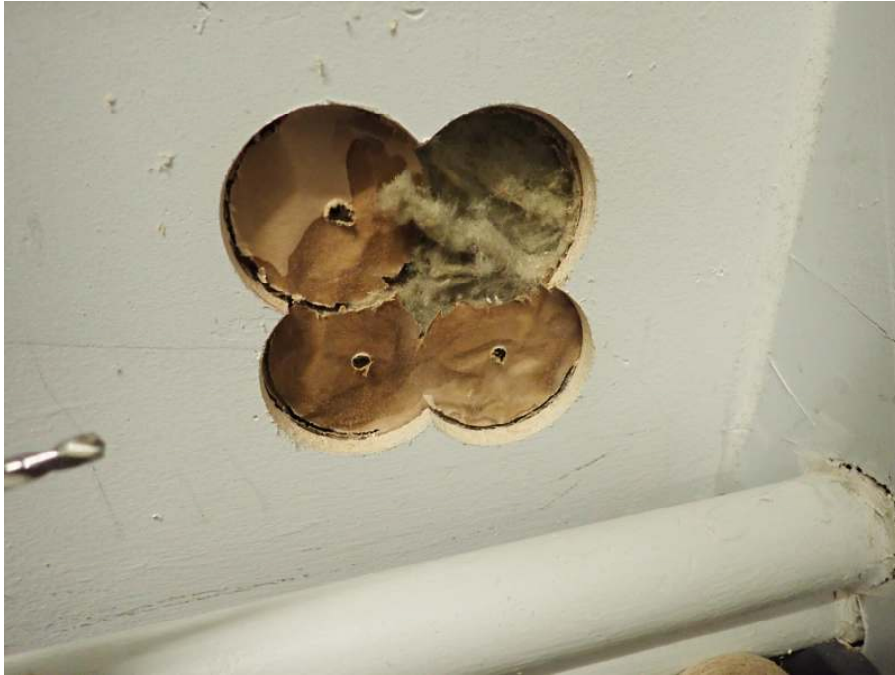
Kuva 24. Yleiskuva tutkimuspaikasta. Höyrinsulkupaperissa on vuotojälkiä.
