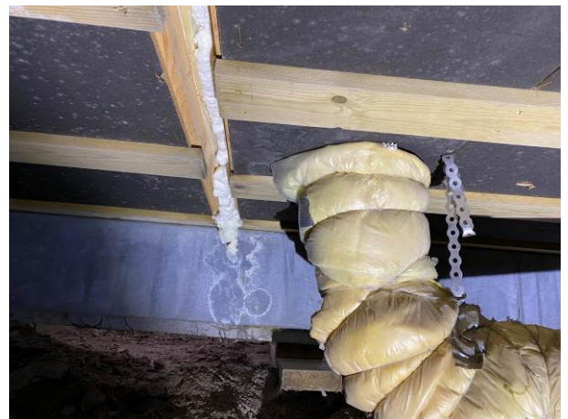
Sokkelin sisäpinnoilla havaittiin joitain kosteusjälkiä.
