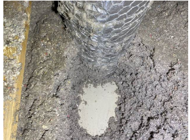
Tarkastetuissa läpivientikohdissa ei havaittu selkeitä viitteitä epätiiveyksistä.
