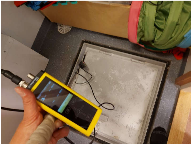
Kuva 9. Alapohjan käyntiluukut olivat epätiivitä. Merkkiainekaasu kulkeutui sisätilaan alapohjan käyntiluukun kautta.
