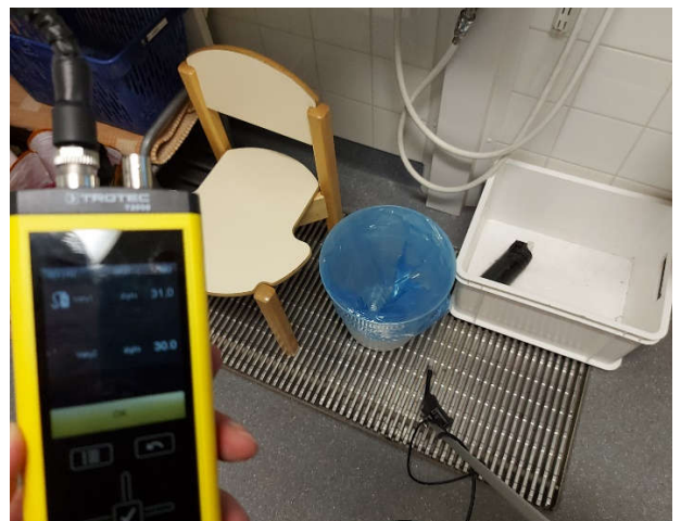
Kuva 12. Merkkiainekaasu kulkeutui sisätilaan alapohjasta kurakaukalon kautta tilassa pääskyt.
