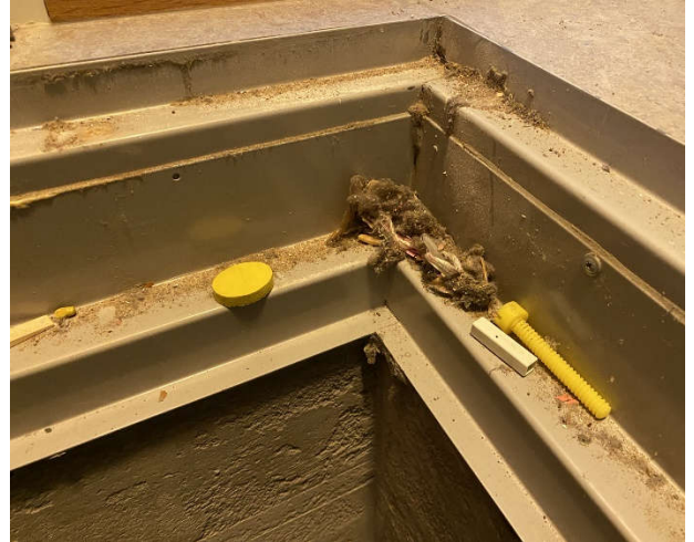
Kuva 8. Alapohjan käyntiluukut olivat epätiivitä.
