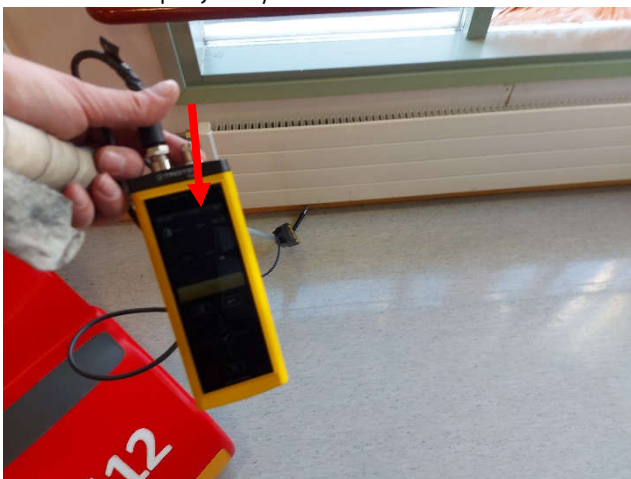
Kuva 11. Liikuntasali. Neulaset-ryhmä. Ilmavuotoa havaittiin ulkoseinä- alapohjaliittymästä.
