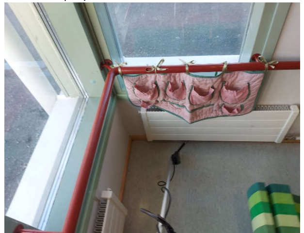
Kuva 10. Neulaset-ryhmä. Ilmavuotoa havaittiin ulkoseinä- alapohjaliittymästä.
