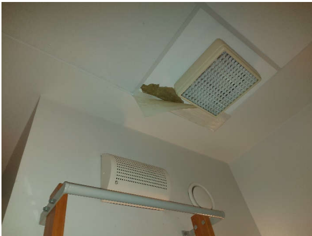
Kuva 15. Neulaset-ryhmässä havaittiin avointa mineraalivillapintaa (lepohuone) akustiikkalevyssä.
