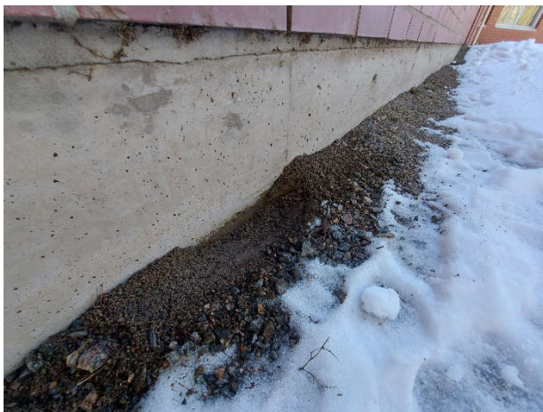
Kuva 12. Rakennuksen vierustan maa-aines on paikoin hiekkapitoista soraa.
