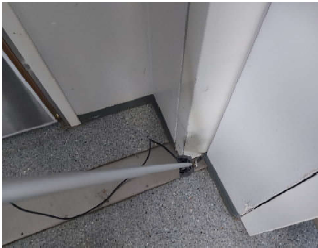
Kuva 102. Ilmavuotoa ulkoseinä-lattialiittymän kautta.
