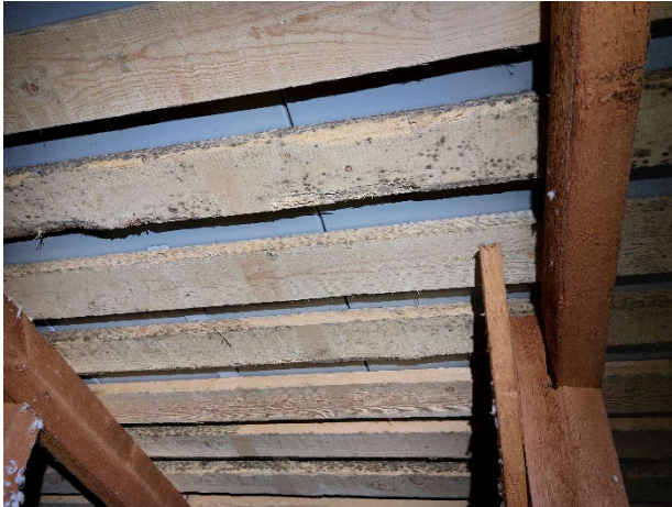
Kuva 82. Mikrobivaurioita päiväkodin yläpohjan puurakenteissa.
