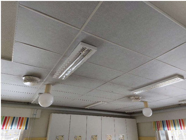
Kuva 63. Päiväkodin vanhaa akustiikkalevyverhoilua..
