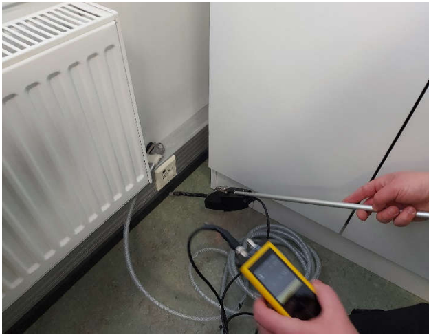
Kuva 90. Ilmavuotoa ulkoseinä-lattialiittymän kautta.
