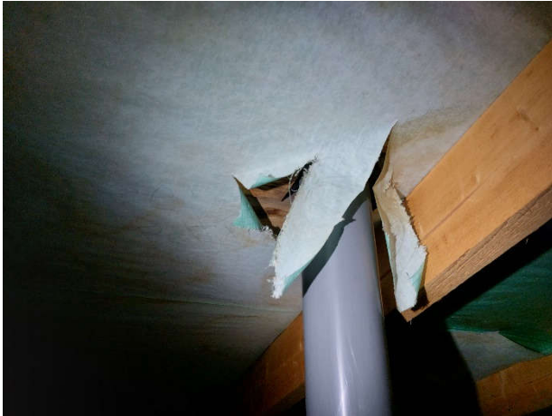
Kuva 77. Viemärin tuuletusputken aluskateläpivientä ei ole tiivistetty (D-osa).
