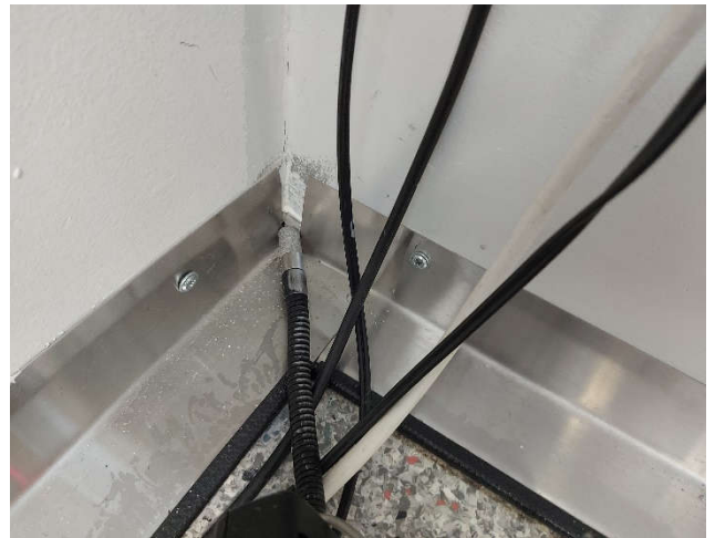
Kuva 93. Ilmavuotoa ulkonurkkauksen kautta.
