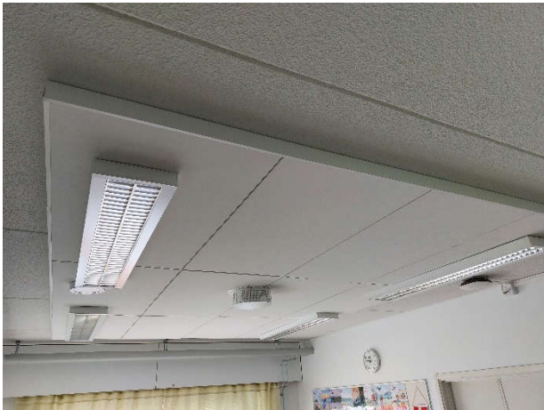
Kuva 57. Päiväkodin lepo- ja leikkitalan akustiikkalevyverhoilua katossa.
