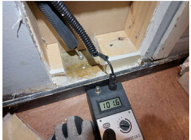
Kuva 54. Lattian pintakosteuslukemat ovat koholla.
