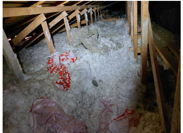
Kuva 84. Lämmöneristeessä rakennusjätettä (C-osa).
