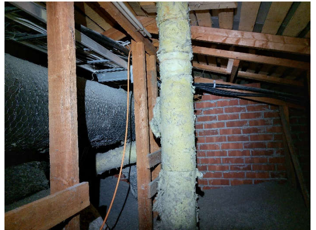
Kuva 81. Päiväkodin yläpohjan viemärin tuuletusputket on eristettyjä.
