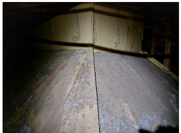
Kuva 86. Kattoikkunan eristeiden pinnalla jäätynyttä vettä (C-osa).
