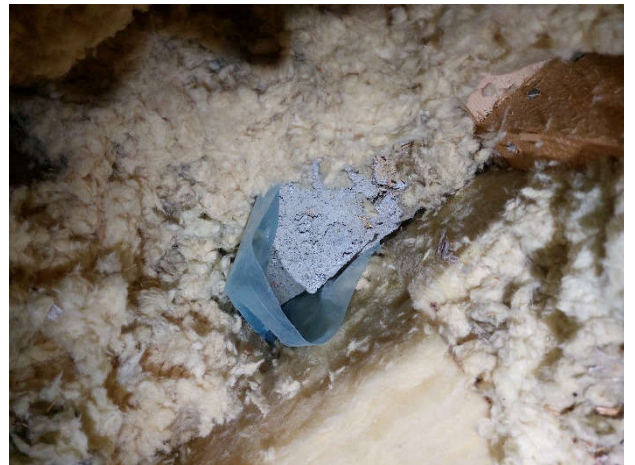
Kuva 76. Höyrynsulkua ei ole liitetty ulkoseinärakenteeseen.
