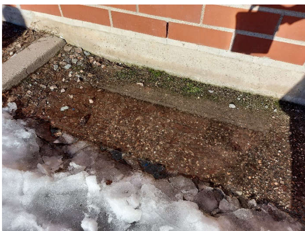
Kuva 14. Maanpinnan muotoilussa havaittiin paikoin puutteita: vesi lammikoituu vierustalle.
