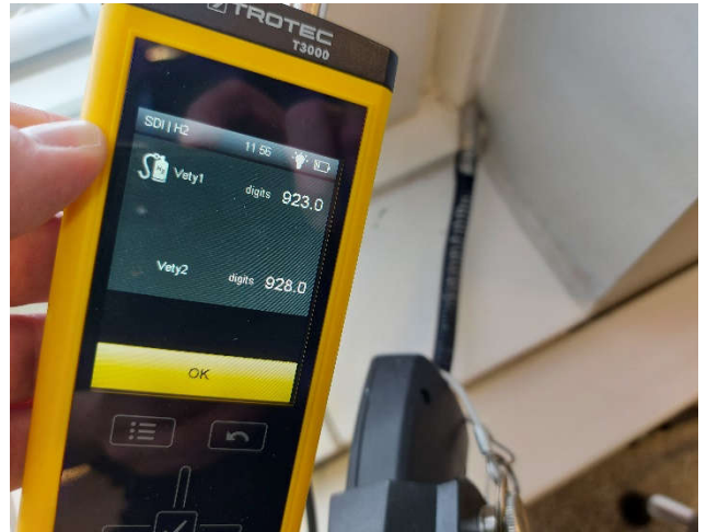
Kuva 95. Ilmavuotoa ikkuna-ulkoseinäliittymän kautta.
