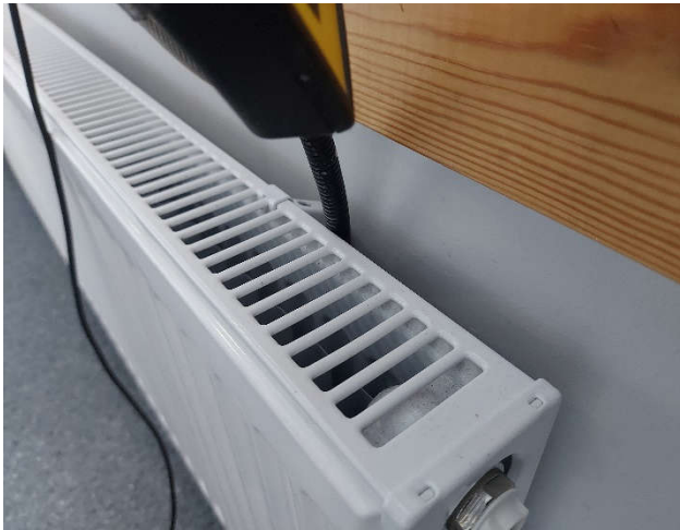
Kuva 100. Ilmavuotoa patterikannakkeiden kautta.
