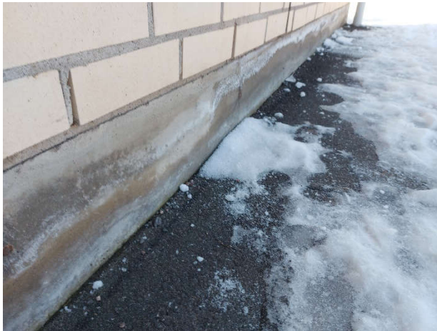
Kuva 16. Sokkeleissa havaittiin kosteuden aiheuttamia jälkiä.
