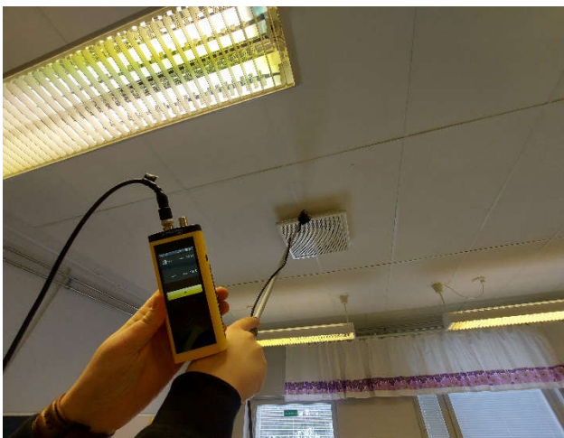
Kuva 98. Ilmavuotoa yläpohjasta läpivientien kautta.
