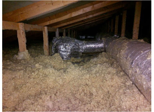
Kuva 74. Lämmöneristeet on epätasaisesti yläpohjassa (D-osa).
