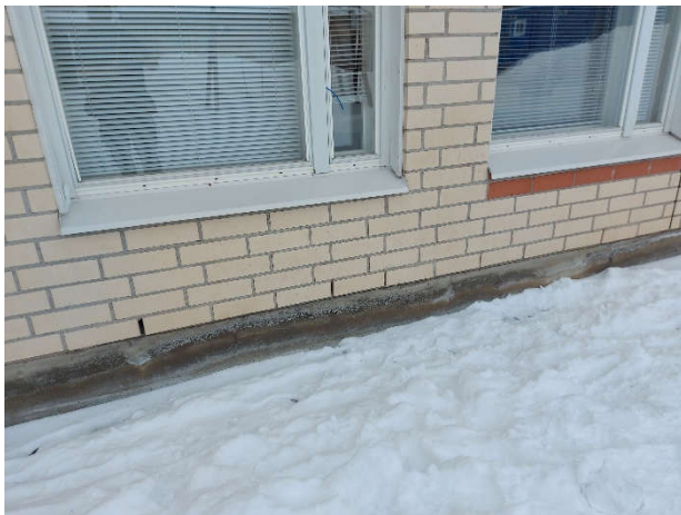
Kuva 39. Sokkelissa havaittiin kosteusvauriojälkiä avauskohdalla.
