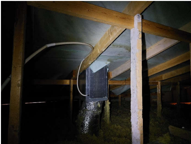
Kuva 79. Huippumurin aluskateläpivientä ei ole tiivistetty (D-osa).
