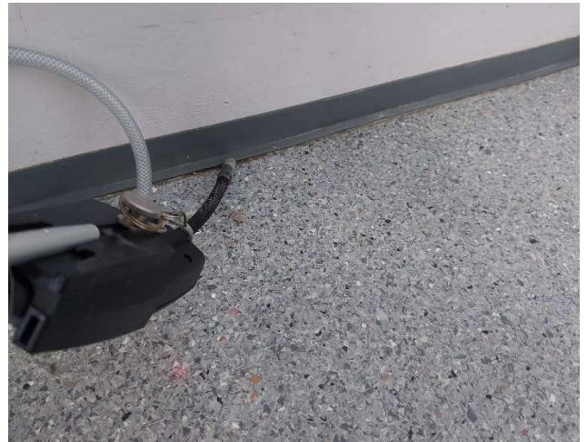
Kuva 101. Ilmavuotoa vanhan ulkoseinän eli nykyisen väliseinä-lattialiittymän kautta.
