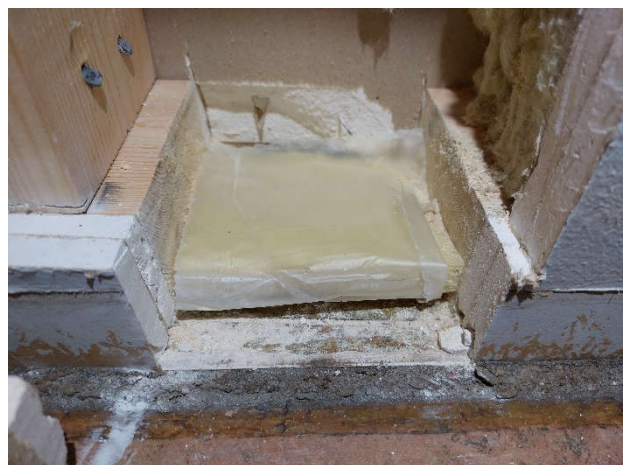
Kuva 50. Väliseinän puurakenteiden ja lattian välissä on muovilla suojattu irroitustaista.
