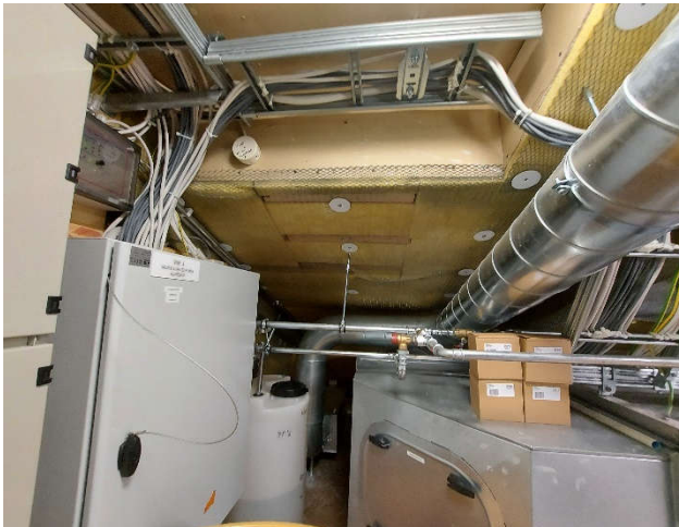
Kuva 69. IV-konehuoneessa havaittiin avoimia mineraalivillapintoja.
