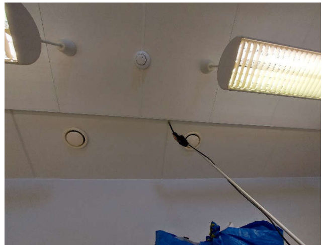
Kuva 97. Ilmavuotoa ontelolaatan saumojen kautta yläpohjasta.
