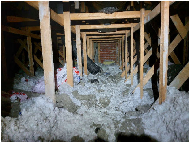
Kuva 83. Lämmöneristekerros epätasainen ja painunut (C-osa).
