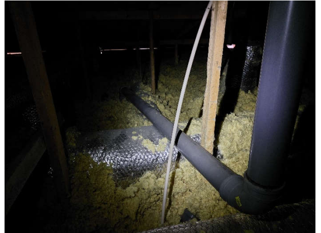
Kuva 78. Viemärin tuuletusputki on puutteellisesti kannakoitu ja eristetty (D-osa).
