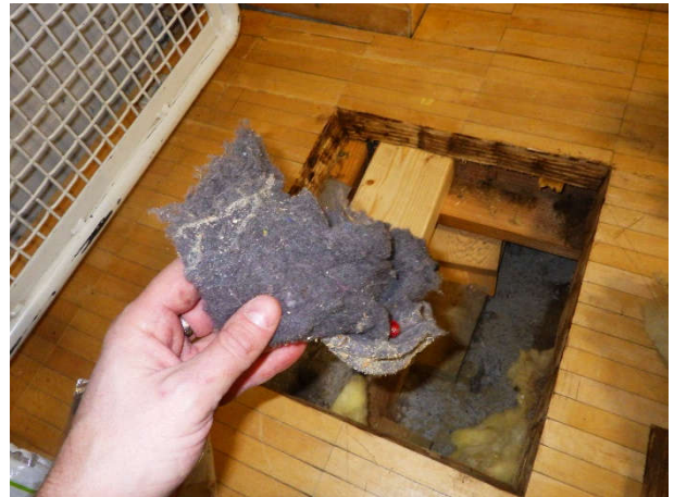
Kuva 28. AP21. Alapohjarakenteen sisään kertynyttä pölyä.
