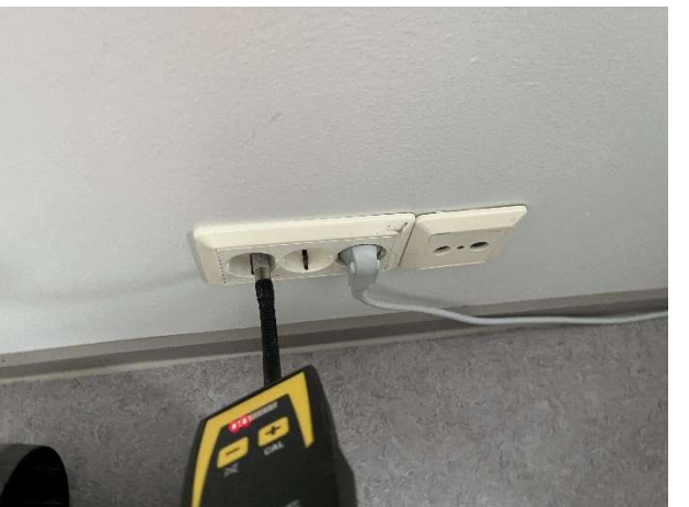
Kuva 87. Merkkiainekaasun havaittiin kulkeutuvan sisäilmaan sähköpistorasioiden kautta.
