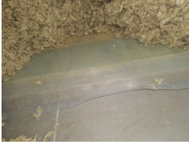
Kuva 78. Höyrynsulun limityksiä ei ole teipattu.
