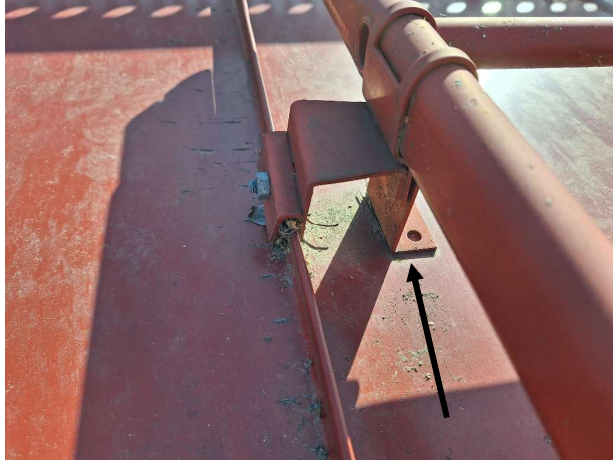
Kuva 72. Laajennusosa. Lapetikkaan jalka naarmuttaa katetta.
