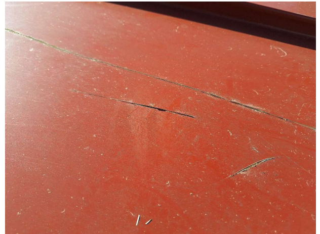
Kuva 63. Laajennusosa. Katteessa naarmuja.
