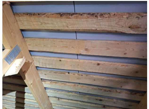
Kuva 75. Laajennusosan katossa ei ole aluskatetta.
