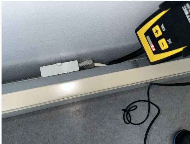
Kuva 84. Merkkiainekaasun havaittiin kulkeutuvan sisäilmaan patteriikiinnikkeiden kautta.
