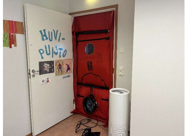
Kuva 83. Tilat aalipaineistettiin keinotekoisesti merkkiainekokeen ajaksi.
