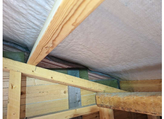
Kuva 79. Räystäällä on pieneläinverkko.
