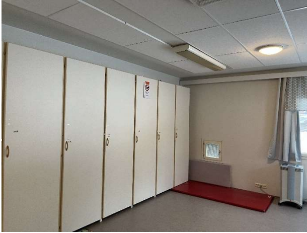
Kuva 92. Korkeiden kaappien päällä havaittiin paikoin runsasta pölykertymää.
