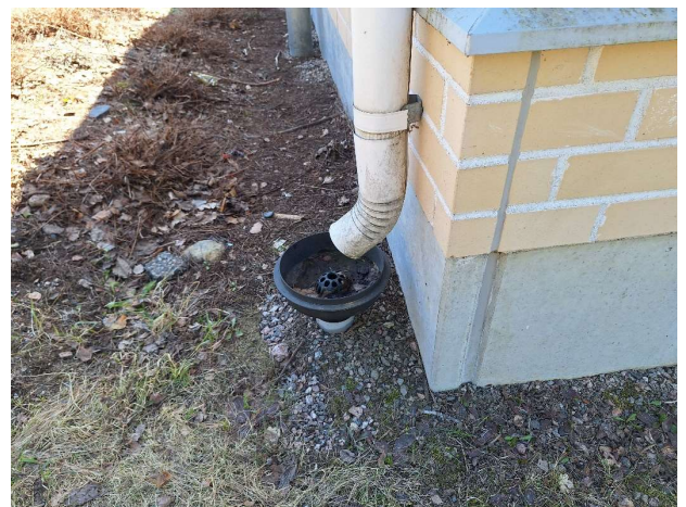
Kuva 81. Sadevedet ohjataan sadevesiviemärointiin.
