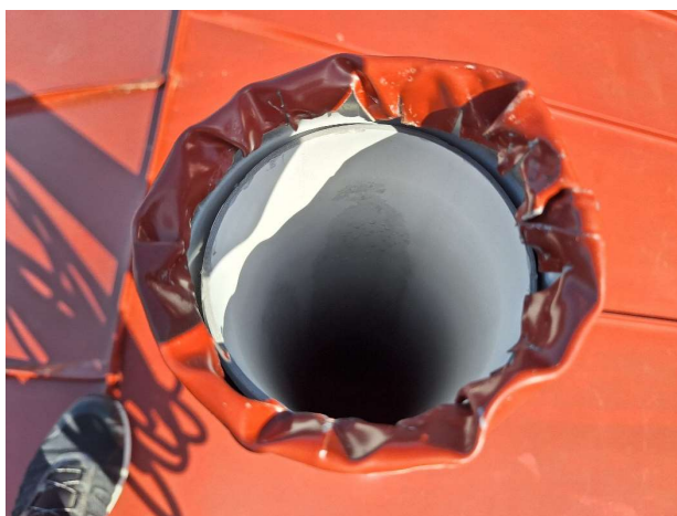
Kuva 68. Laajennusosa. Viemärin tuuletusputken pellitykset toteutettu huonosti yläpäästä.
