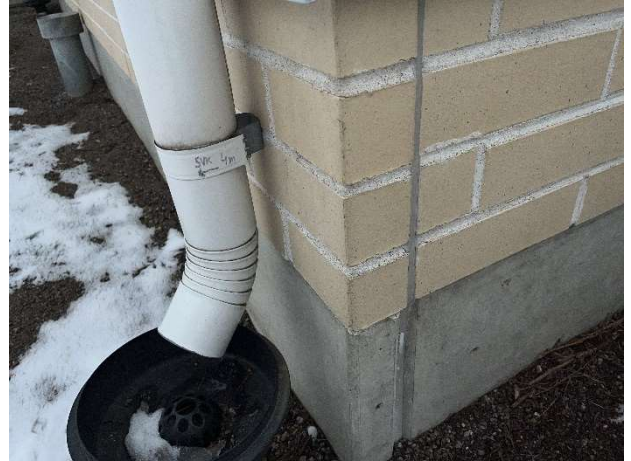
Kuva 29. Saumauksissa havaittiin paikoin puutteita.
