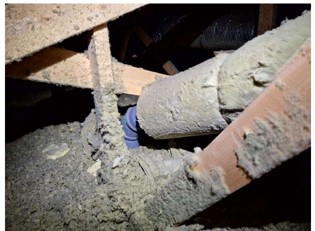
Kuva 77. Viemärin tuuletuksen eristykset irronneet.
