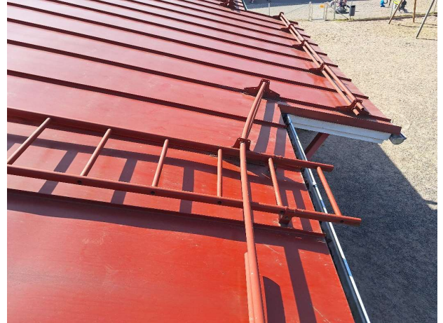
Kuva 73. Lumiesteet ovat paikoin taipuneet lumikuormasta alkuperäisosaalla ja laajennusosalla.
