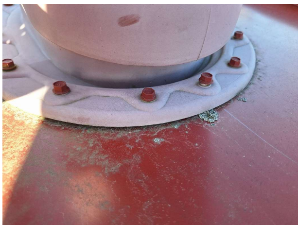
Kuva 70. Huippumurin ja kateen liitos on suositeltavaa uusia.
