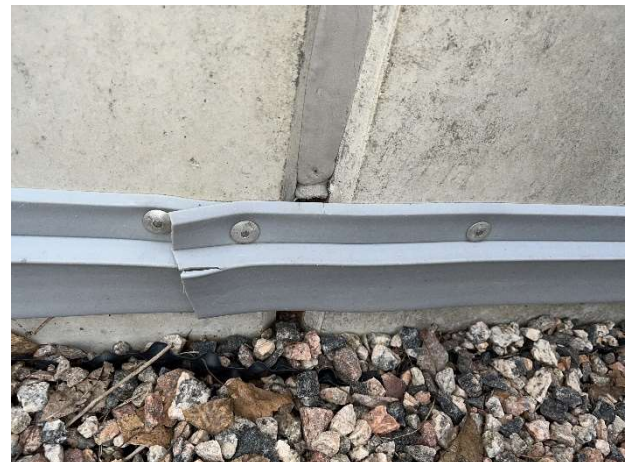
Kuva 33. Patolevyn ja reunalistan kiinnitys puutteellinen. Sokkeliementin saumaus on puutteellinen.
