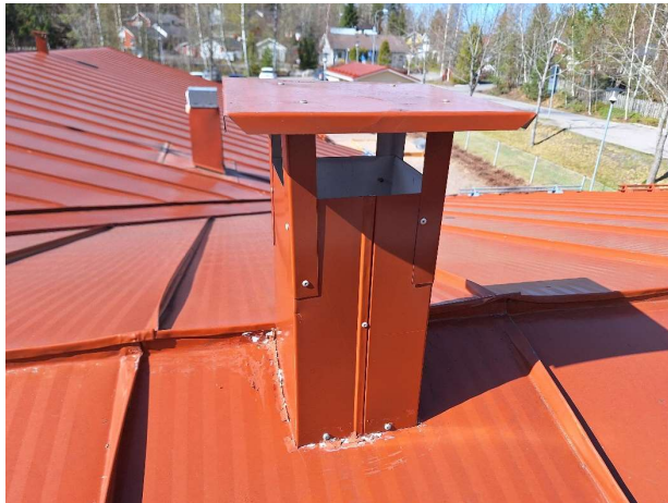
Kuva 66. Alkuperäisosa. Yläpohjan tuuletuskanavan juuren tiivistysmassat ovat haurastuneet.
