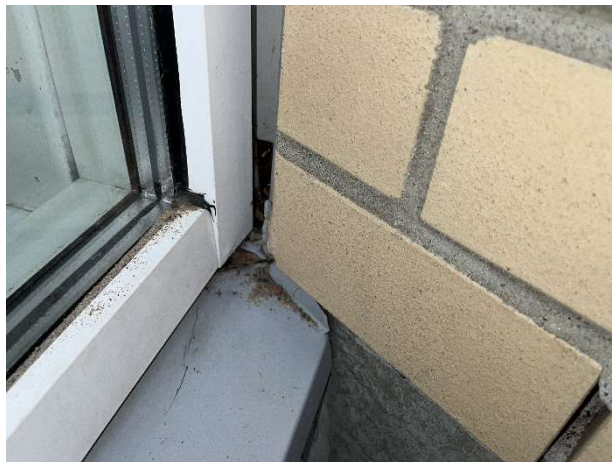
Kuva 32. Yhdyskäytävän ja laajennusosan liittymässä epätiivelyksiä.
