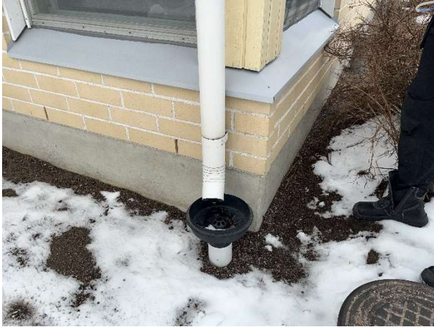
Kuva 28. Alkuperäisosa. Tiilimuurauksessa joka kolmas sauma on auki.
