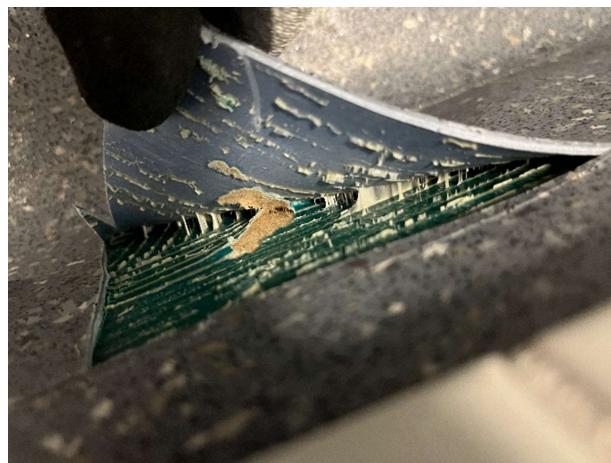
Kuva 20. WC-tilan muovimaton seinänostoa.
