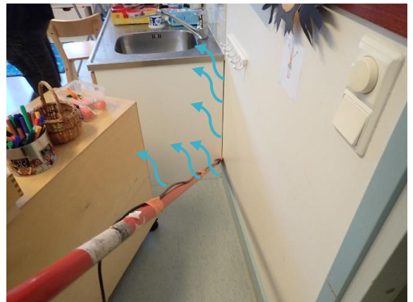
Kuva 37 028 ryhmähuone: Runsasta vuotoa allaskaapin liittymistä huonetilaan.
