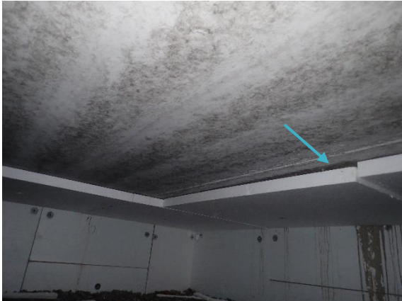
Kuva 22 Sokkelien sisäpinnat ja alapohjan reunavyöhykkeet on lisäeristetty EPS -eristelevyin. Eristelevyt on kiinnitetty mekaanisin kiinnikkein. Eristelevyjen saumoja ei ole tiivistetty.
