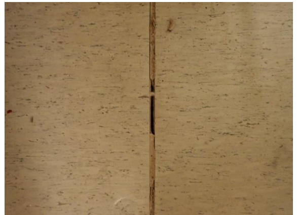
Kuva 9 Päällimmäisen luukun sauma on tiivistetty elastisella massalla. Massaus ei kuitenkaan ole tiivis. Massaus on ikääntynyt, eikä sitä ole uusittu edellisen luukun aukaisun jälkeen.
