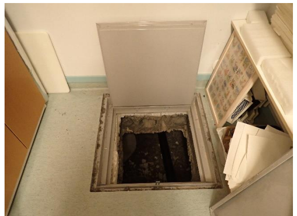
Kuva 11 Sisemmän luukun ja karmin välissä oli runsaasti likaa. Ei tiivistettä luukussa.
