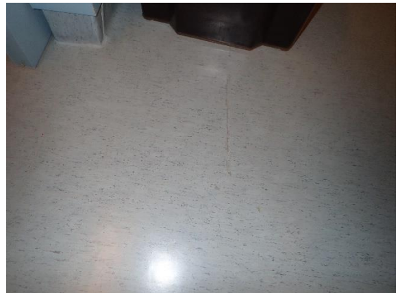
Kuva 5 Tasoeron kohdalla verstautilan puolella muovimatossa repeämä, joka viittaa kantavan rakenteen saumakohdan liikkeeseen.
