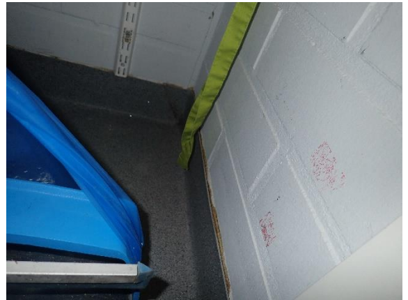
Kuva 13 Muovimaton seinänoston irtoaminen tilassa 049 siivouskomero.
