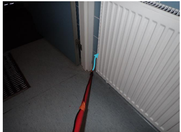
Kuva 43 027 pesuhuone: Pistemäinen vuotohavainto väliovikarmin ja ulkoseinän liittymästä.
