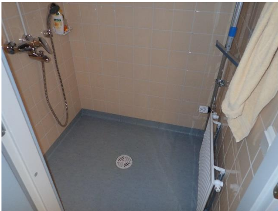
Kuva 46 Henkilökunnan suihkutila 043 todettiin erittäin kylmäksi. havaintojen perusteella lämmityspatterissa ei kiertänyt vesi.
