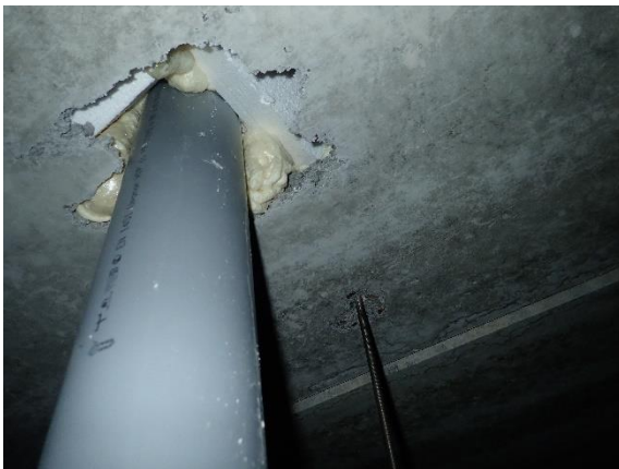
Kuva 18 Putkiasennusten läpivientejä on osittain tiivistetty vaihtelevilla materiaaleilla, kuten EPS -eristepaloilla ja uretaanivaahdolla.
