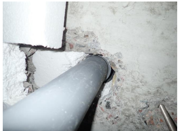
Kuva 19 Läpiviennin tiivistystä EPS -levyin ja solumuovilla. Läpiviennit eivät silmämääräisesti arviotuna ole tiiviitä.
