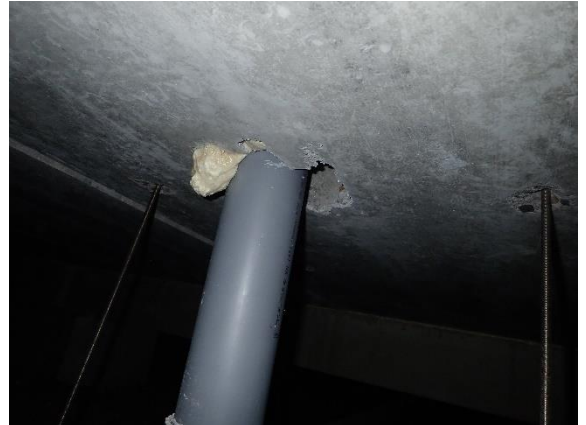
Kuva 17 Putkiasennusten läpiviennit eivät ole tiiviitä.
