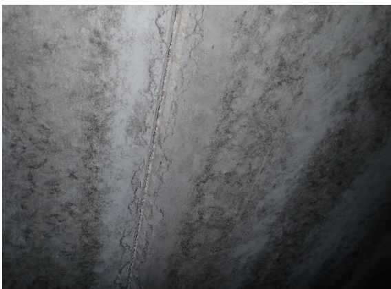
Kuva 20 Ontelolaattojen saumat ovat valettuja ja mahdolliset vuodot niiden kautta vähäisiä.
