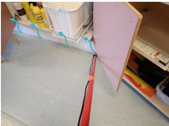
Kuva 38 028 ryhmähuone: Runsasta vuotoa allaskaapin liittymistä huonetilaan.
