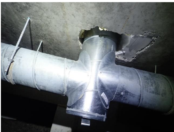
Kuva 26 Ryömintätilan poistoilmakanavan läpivienti tiivistetty epäluotettavasti.
