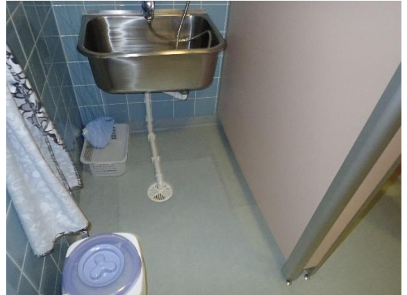
Kuva 7 Uusittua muovimattoa, jossa reunoilla säästetty alkuperäistä pinnoitetta tilassa 003.
