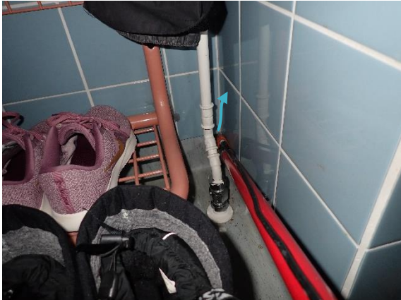
Kuva 40 025 kuraeteinen: Pistemäinen vuotokohta väli-seinän sisään tai ulkoseinäliittymään ja pistemäisesti maton seinänoston kulmakohdasta sisätilaan.
