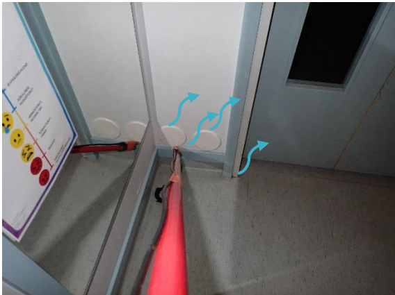
Kuva 34 Eteinen 026: Runsasta vuotoa väliseinän sisälle ja sähköasennusten ja karmiliittymien kautta sisätiloihin.
