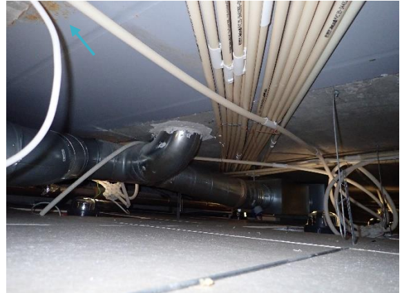
Kuva 51 Havaitut läpiviennit olivat asianmukaisesti tiivistettyjä. Deltapalkin alalaidassa todettiin paikallisesti hieman ruostumista.
