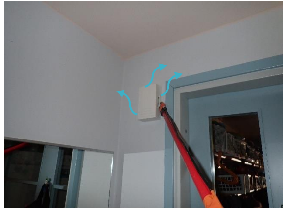
Kuva 35 Eteinen 026: Runsasta vuotoa väliseinän sisälle ja ovikelloasennuksen kautta huonetilaan.
