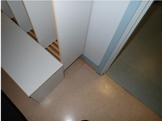
Kuva 6 Eteistilassa 002 lattiassa on paikkaamaton porareikä.
