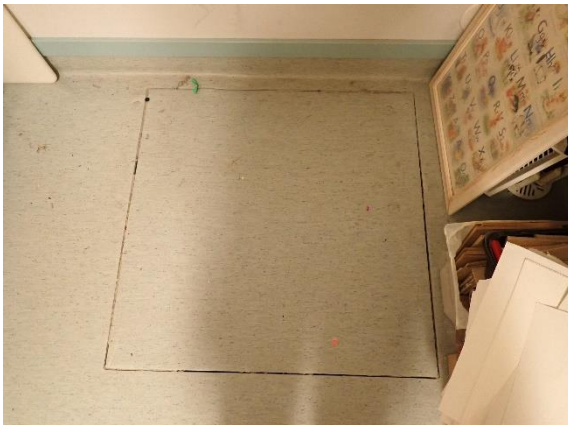
Kuva 8 Alapohjan ryömintätilan päällimmäinen käyntiluukku varastossa 034. Saumakohdistista oli aistittavissa selkeä kylmän ilman virtaus sisätilojen suuntaan.
