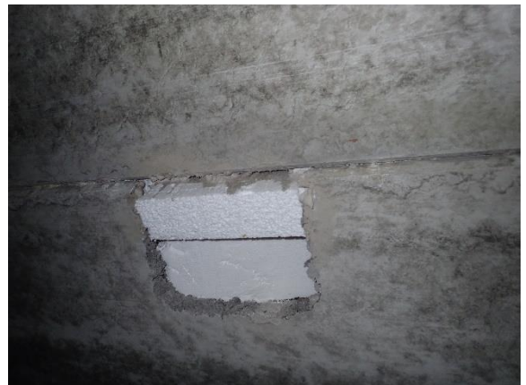
Kuva 25 Epäluotettavasti tiivistetty läpivientivaraus.
