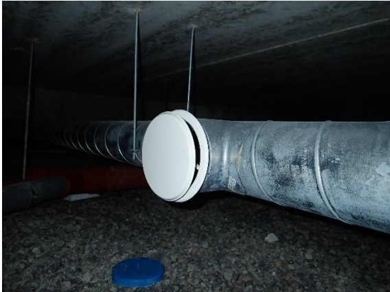
Kuva 16 Ryömintätilan ilmanvaihto on järjestetty poistoilmapuhaltimella, joka pitää ilmavirran liikkeellä kaikissa olosuhteissa.
