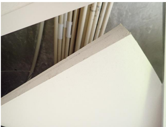
Kuva 48 Alakattojen levyt todettiin pääosin reunapinnoitetuiksi.
