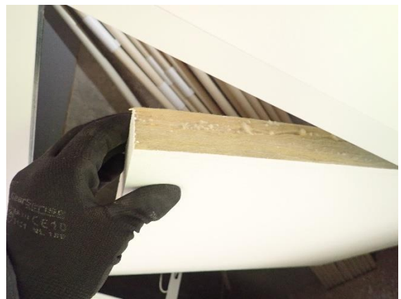
Kuva 49 Leikatuissa levyissä esiintyy reunasuojauksen puutteita.
