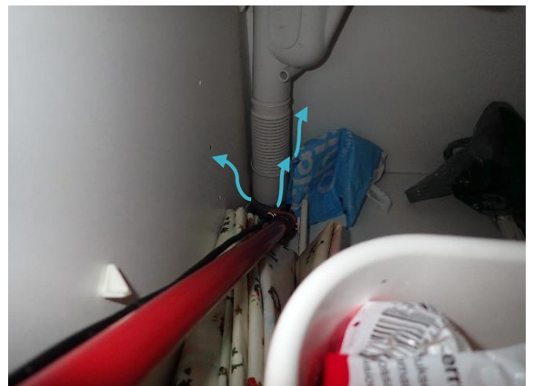
Kuva 39 028 ryhmähuone: Runsasta vuotoa viemäri liittymästä allaskaapin sisälle.
