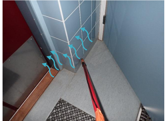
Kuva 41 025 kuraeteinen: Runsasta vuotoa alapohjan ja ulkoseinän liittymän alueella kynnyksen alta ja muovimaton sekä laatoituksen rajasta.
