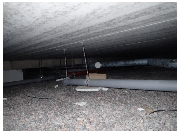
Kuva 15 Pieniä yksittäisiä roskia tilassa havaittiin. Ei kuitenkaan merkittäviä määriä. Putkiasennukset on kannakoitu asiallisesti eikä putkien taipumia havaittu.
