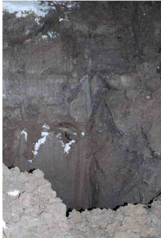
Kuva 8. KK2. Kuoppa kaivettu 9 m syvyydelle, reunat epästabiilit.
