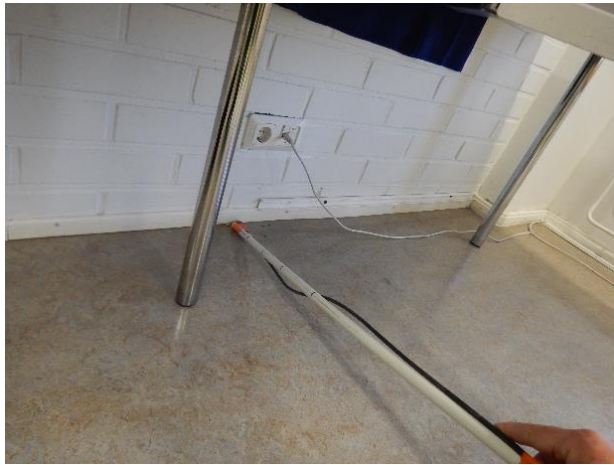
Kuva 9. Ilmavuotoja havaittiin myös väliseinien ja alapohjan liitoksesta. Tiiliväliseinät lähtevät pintalaatan päältä (laatan vahvennos). Betonirakenteet (kuten pilarit, paikallavaletut portaikot ja hissikuilu) lähtevät perustuksien päältä ja ”läpäisevät” pintalaatan. Kuva luokasta 11. Havaitut ilmavuodot aiheutuvat todennäköisesti pintalaatan vahvennoksen ja normaalin vahvuisen pintalaatan rajakohdan halkeilusta.
