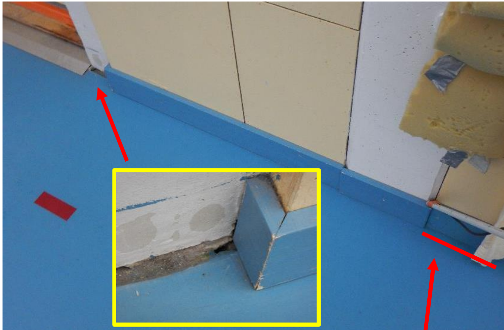
Kuvat 14a ja b. Pohjoispäädystä havaittiin voimakkaita ilmavuotoja lattian ja seinän liitoskohdassa.
