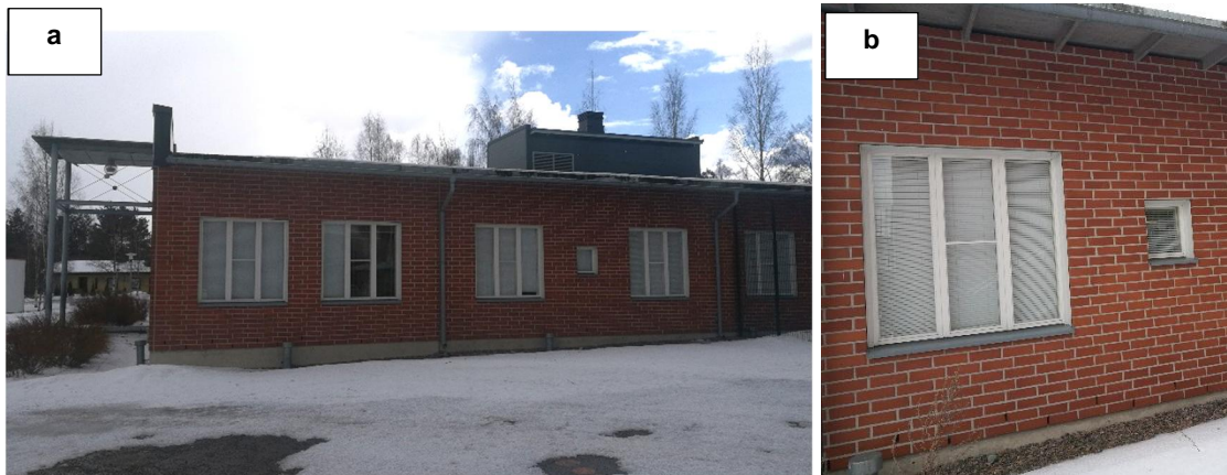
Kuvat 19a ja b. Laajennusosan tiilikuorimuuraus on hyväkuntoinen. Eristetila tuulettuu yläosan tuuletusraon ja alaosan joka kolmannen avatun laastisauman avulla. Räyställä ei ole eläinverkkoa ja linnut ovat levitelleet yläpohjan mineraalivillaeristeitä pihamaalle.
