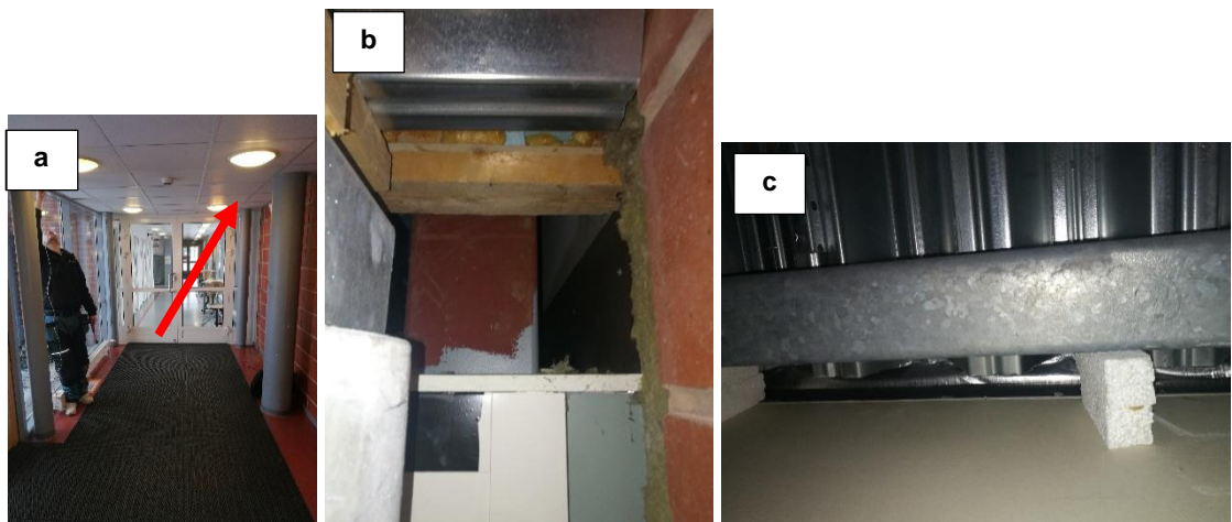
Kuvat 26a-c. Laajennusosan ja B-osan yhdistävän käytävän tiiliseinä on vanha ulkoseinä. Alakattotilassa todettiin hiiren pesä sekä liitoskohdassa yhteys alakatosta yläpohja/ulkoseinätilaan. Ulkoseinän ja yläpohjan liitoskohdassa oli nähtävillä höyrynsulukulaminaatti (c). Nuolella osoitetussa kohdassa oli hiiren pesä. Kohdasta irrotettiin alakattolevy ja kuva b on otettu alakattotilasta laajennusosan suuntaan.
