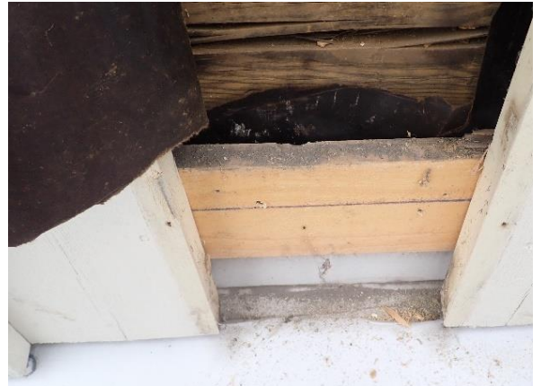
Kuva 42 Julkisivun tuulettuvuus on heikkoa, sillä peiterimalaudoituksen takana on vaakakoolaus, jolloin tuuletusväli ei ole avoin.
