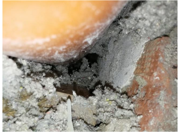
Kuva 64 Viemärin tuuletusputken yläpohjan läpivienni tiivistämättä.
