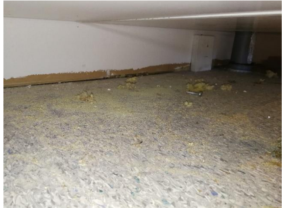
Kuva 60 Luokassa 109 kaapiston alla runsaasti mineraalivillakuitueristettä, joka on peräisin väliseinän ja alapohjarakenteen liittymästä.
