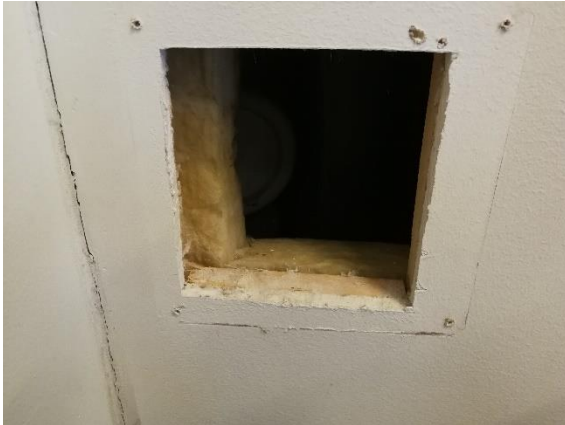
Kuva 59 Luokassa 109 väliseinään tehty viemärin tuuletusputken tarkastusluukku, aukosta selvää ilmayıhtöä sisätilaan. Koteloinnista on ilmayhteys alapohjaan.
