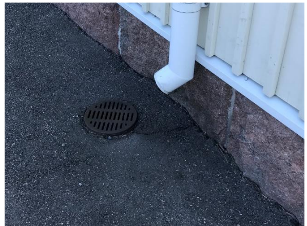
Kuva 6 Syöksytorven asemointi puutteellinen kaivon nähden, kaikki kattovedet eivät osu kaivoon. Lisäksi kaivon reuna on asfaltin pintaa korkeammalla, jolloin myöskään pintavedet eivät kulkeudu kaivoon.
