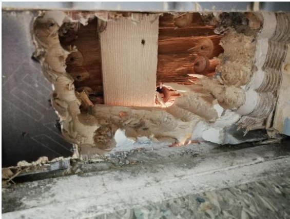
Kuva 27 Edellisten kuvien rakenneavauskohta sisäpuolelta avattuna.
