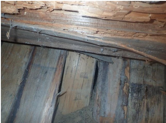
Kuva 33 Käytävätilojen hiekkatäytöt ja kevytbetonivalut on toteutettu laudoitusta vasten, joka on jätetty rakenteeseen. Muottilauoissa on lahovaurioita
