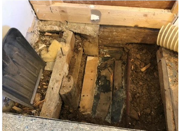
Kuva 58 Luokassa 109 vanhan ulkoseinän (hirsi) ja alapohjan liittymärakenne on tiivistetty mineraalivillalla. Ilmavuodot ovat mahdollisia.
