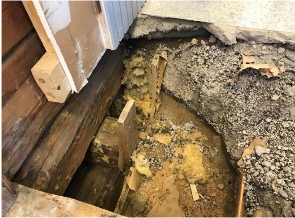
Kuva 31 Käytävään 07 tehdyn rakenneavauksen kautta selvitettiin alapohjan kevytbetonivalun ja väliseinän liitosrakennetta. Alapohjarakenteesta on suora ilmayhteys sisäilmaan päin (AP6).
