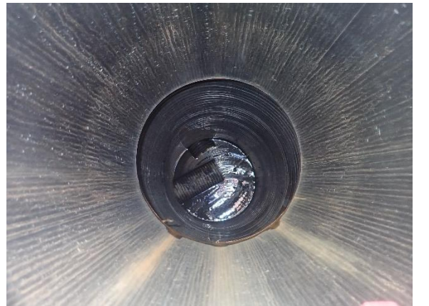
Kuva 10 Salaojien tarkastuskaivossa havaittiin vettä.
