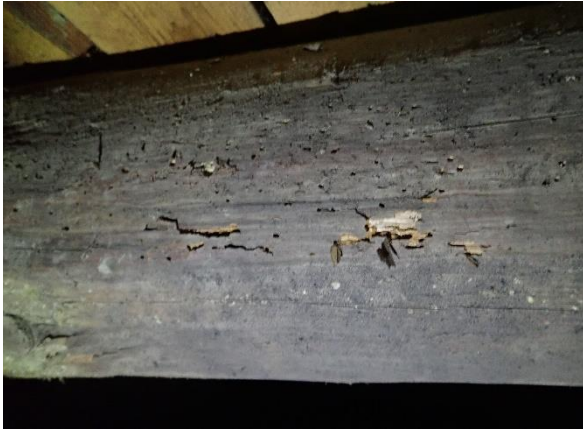
Kuva 18 Kantavassa puupalkissa havaittiin paikallisesti hyönteisten jälkiä. Palkeissa ei kuitenkaan havaittu pehmentymää puukolla koetettaessa.
