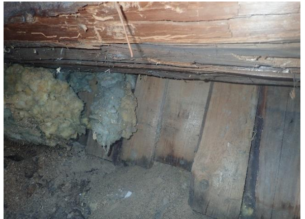
Kuva 34 Rakenteessa käytetty myös mineraalivillaa. Hiekkaa vasten oleva muottilaudat ovat vaurioituneet.
