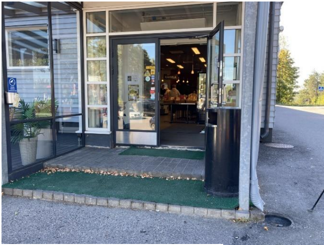
Pääsisäänkäynti ei ole esteetön
