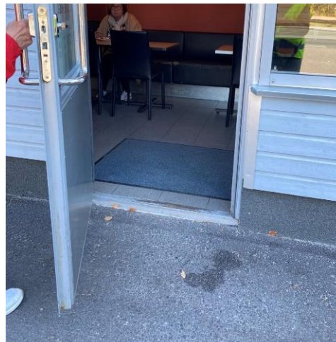
Sivuovi on kapea ja siinä on korkea kynnyks
