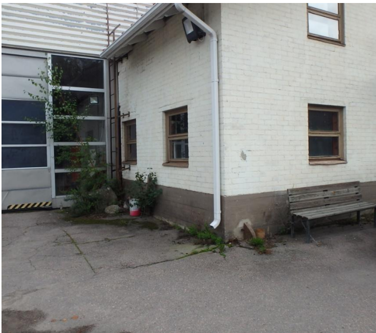
Kuva 5. Rakennuksen luoteissivu. Rakennus rajautuu laajennusosaan. Sadevedet ovat ohjattu syöksytorvella sokkelin vierustalle asvaltille. Asvaltin läpi kasvaa sammalta ja puuntaimia.
