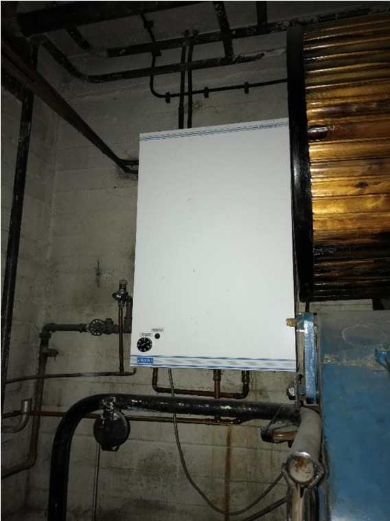
Kuva 36. Lämpimän käyttöveden sähkövaraaja kellarin lämmönjakohuoneessa.
