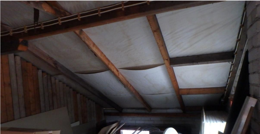
Kuva 25. Käyttöullakon aluskatteessa näkyy vesivuotojälkiä, todennäköisesti peltikaton kondenssista johtuen.
