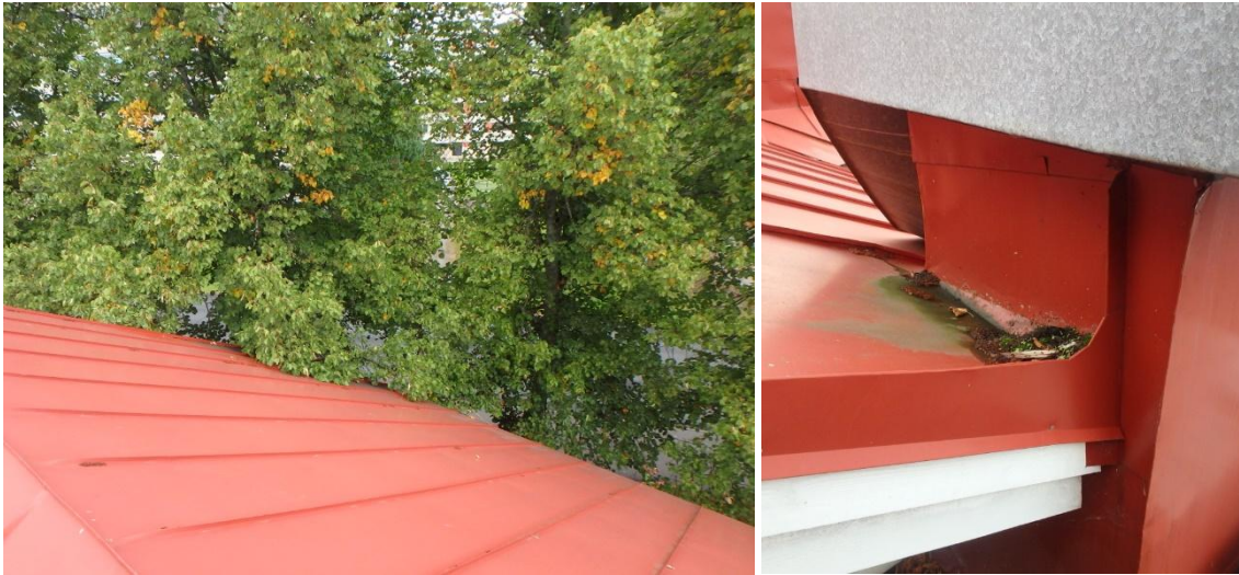
Kuvat 19 ja 20. Puiden oksat ovat paikoin vesikaton päällä. Vesikate lammikoi paikallisesti piippujen juurilla.
