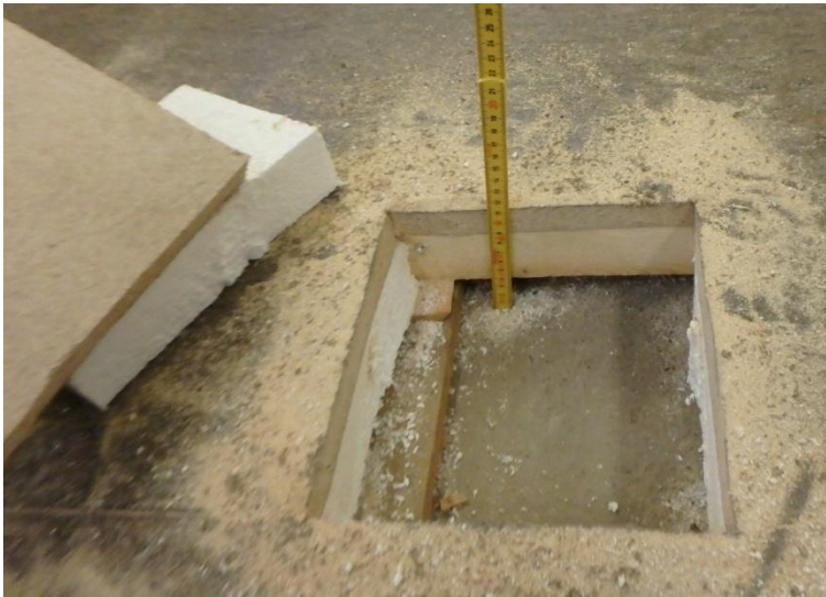
Kuva 16. Rakennuksen lounaispäädyssä on puurakenteinen korotettu lattia vanhan alapohjalaatan päällä. Puurakenteissa ei havaittu poikkeavaa kosteutta, mutta rakenteista lähti mikrobiperäinen haju.
