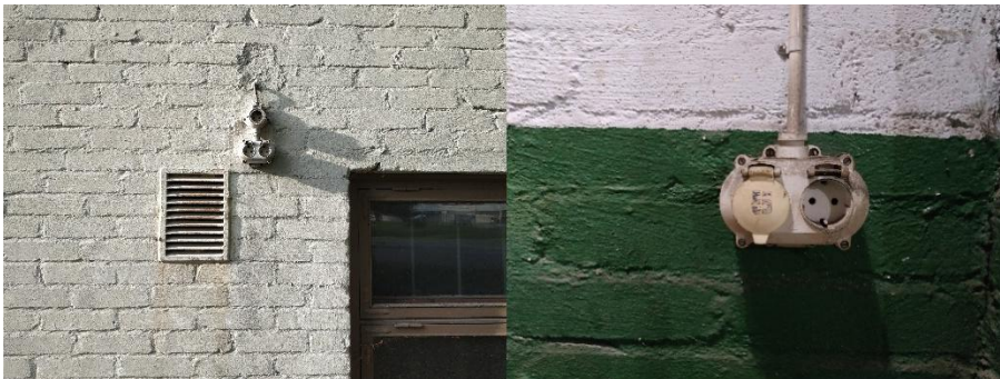
Kuvat 52 ja 53. Vaurioituneita pistorasioita julkisivussa (päädyssä) ja 1. kerroksen takatiloissa.
