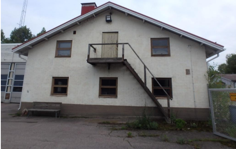
Kuva 4. Rakennuksen lounaispääty. Piha on kokonaan asfaltoitu, sokkelin vierustalla on asvaltin läpi kasvavaa kasvustoa, sammalta ja noin 2 m korkea puuntaimi. Ullakolle menevät puuportaat ovat heikossa kunnossa.
