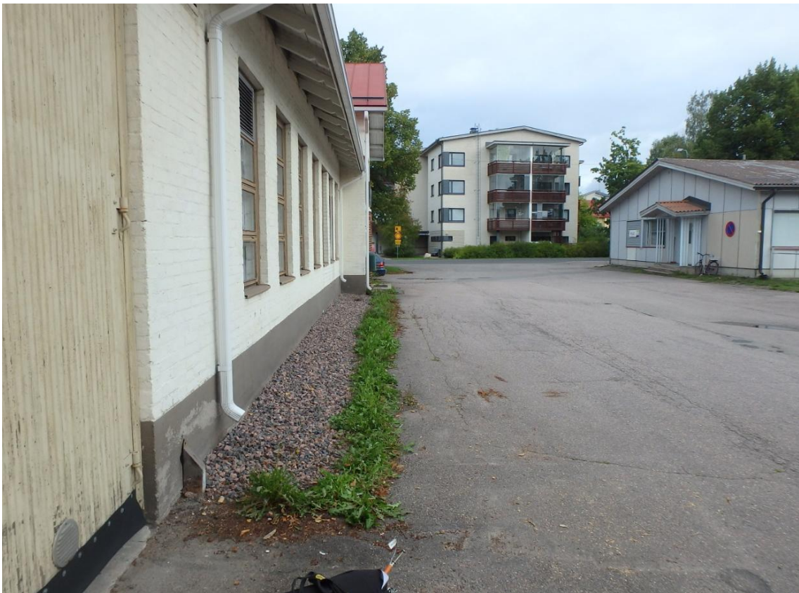
Kuva 7. Rakennuksen kaakkoissivulla on osa sokkelin vierustasta sepelöity. Asvaltissa painumia ja jälkiä veden lammikoitumisesta. Sadevedet ovat ohjattu sokkelin vierustalle.
