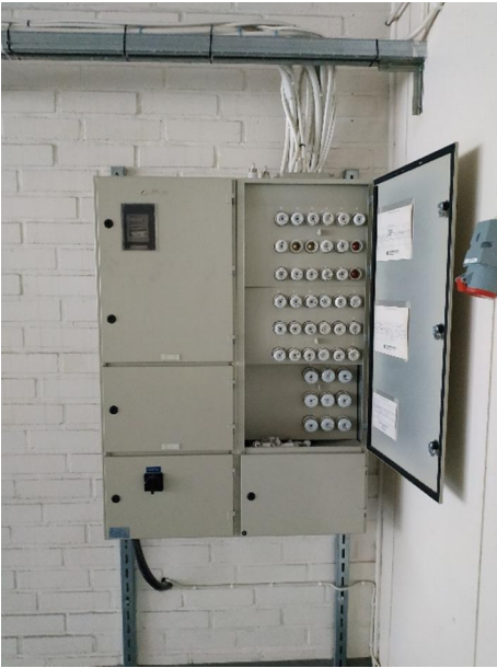
Kuva 42. Pesulan laitteiden sähkönsyöttöä palvellut ryhmäkeskus 1. kerroksessa.
