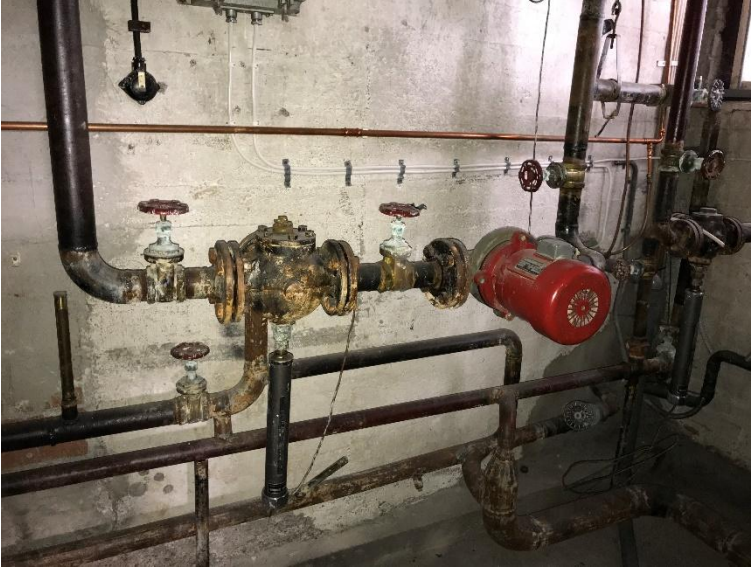
Kuva 32. Vanhoja käytöstä pois jääneitä lämmitysputkiasennuksia kellarin lämmönjakuhuoneessa.
