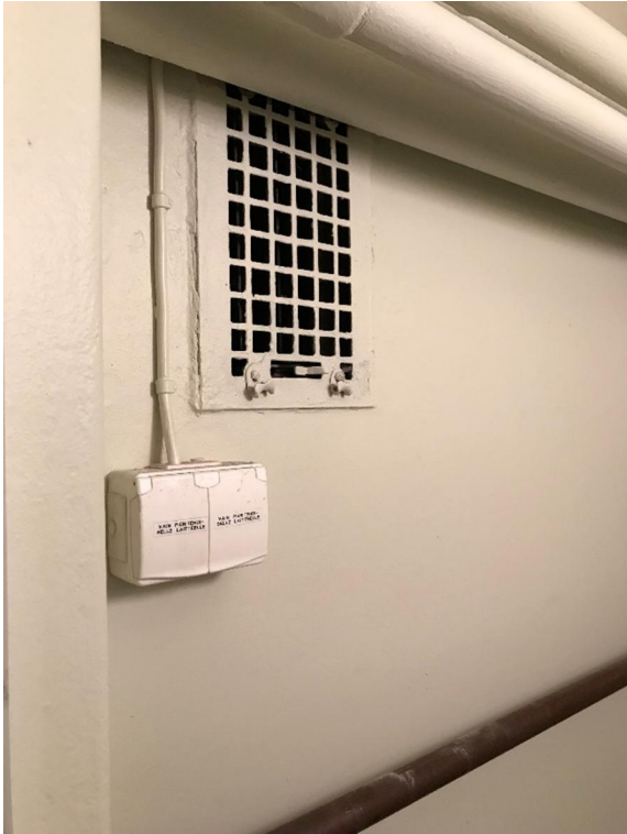
Kuva 34. Painovoimaisen ilmanvaihdon poistoilmasäleikkö.
