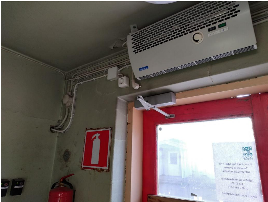
Kuva 48. Sähkötoiminen oviverhohallin 1. kerroksen tuulikaapissa.
