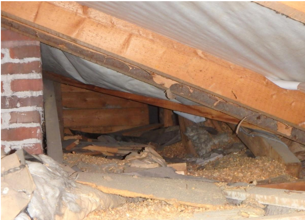
Kuva 22. Yläpohjan eristeiden joukossa on rakennusjätettä. Aluskate repsottaa paikoin.
