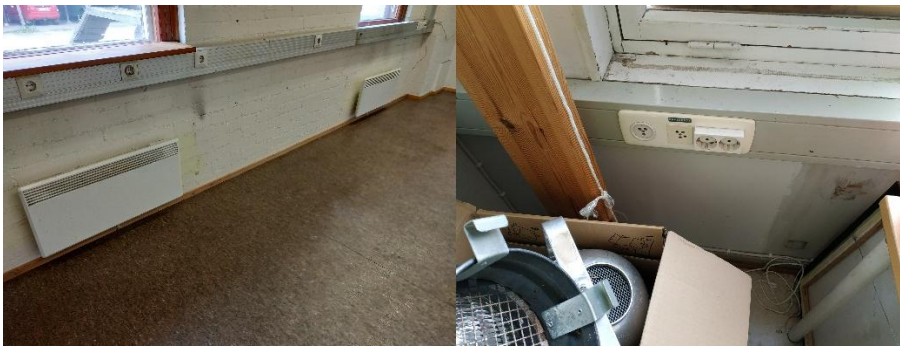
Kuva 39. Johtokouruja 1. kerroksen entisissä toimistotiloissa sekä 2. kerroksen toimistotiloissa/työhuoneissa.
