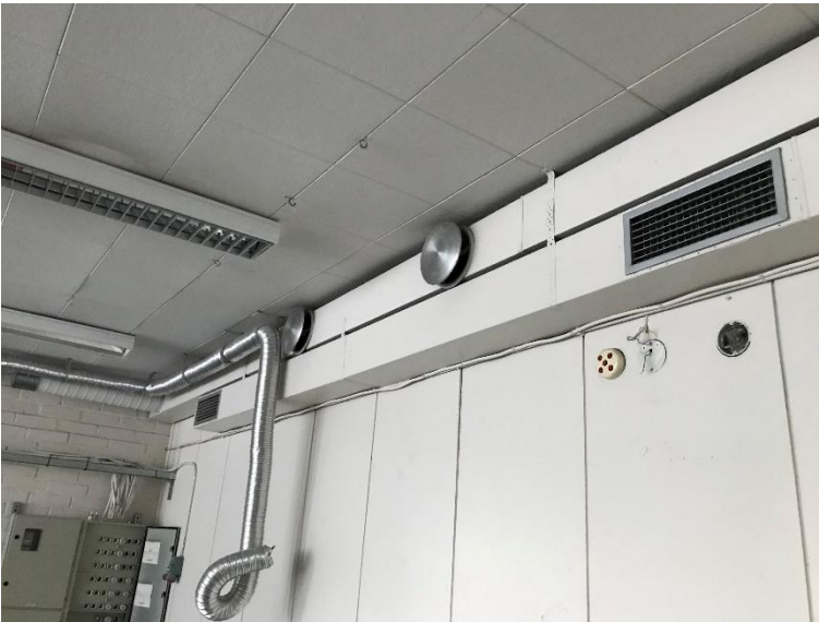
Kuva 33. Pesutilaa palvelevia tulo- ja poistoilmanvaihdon päätelaitteita.
