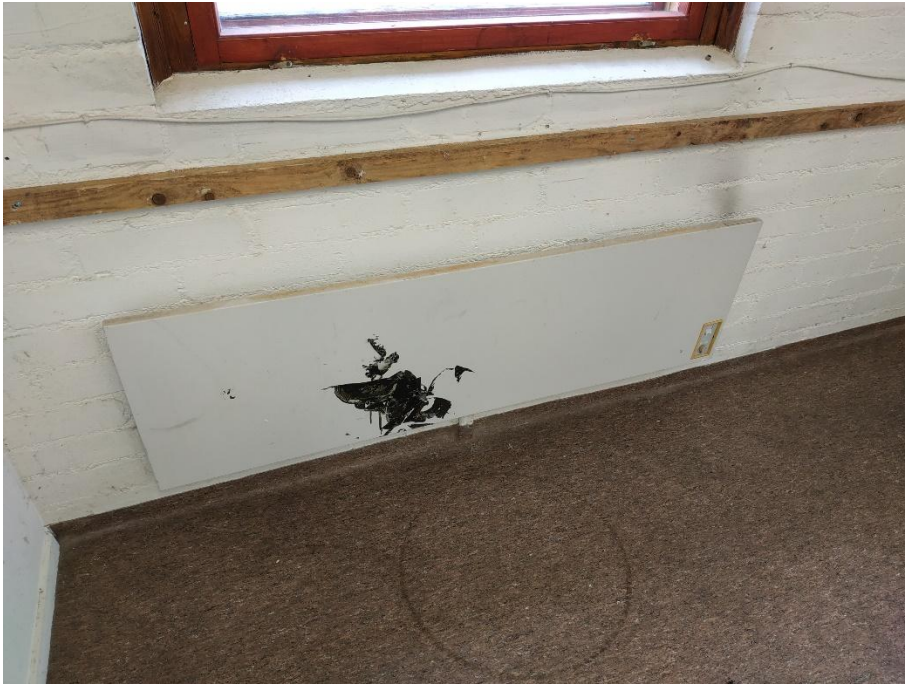
Kuva 47. Vanha sähkölämmitin 1. kerroksessa.
