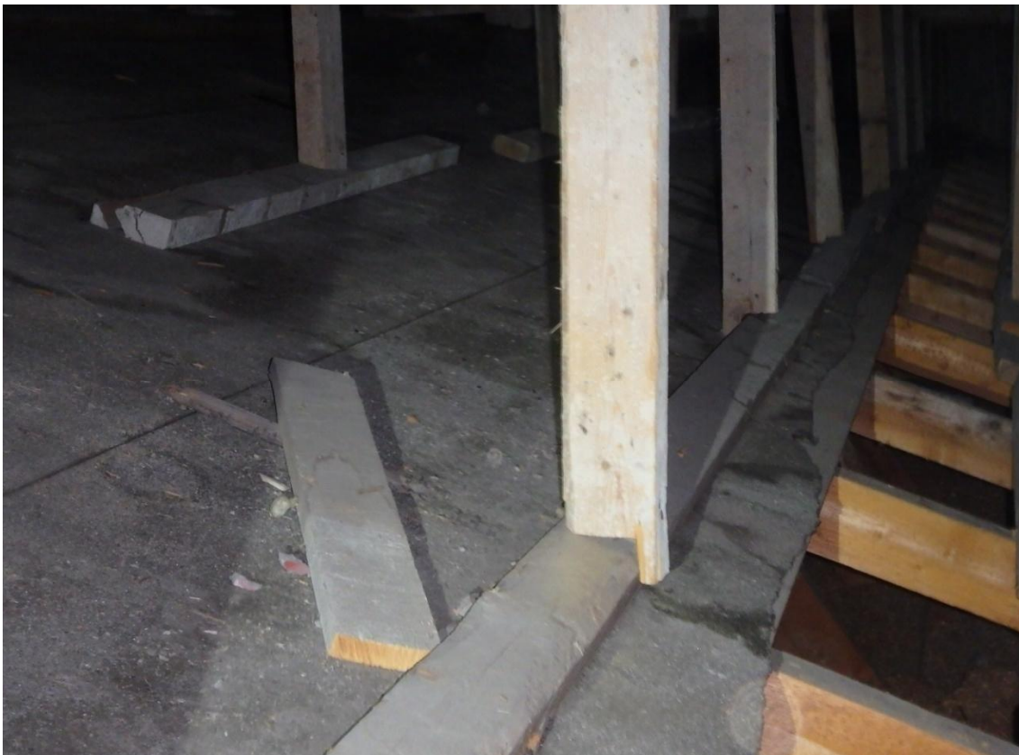
Kuva 21. Laajennusosan tasakaton alla on vanhan harjakaton umpilaudoitus ja katekemit.
