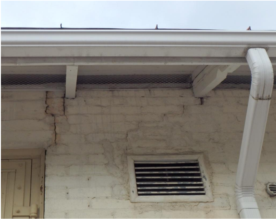
Kuva 9. Rakennuksen koillissivulla ja kaakkoissivuilla havaittiin useita porrastavia hálkeamia. Halkeamat olivat yleensä ovi- ja ikkuna-aukkojen nurkissa.
