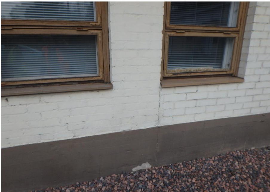
Kuva 10. Ummistettu oviaukko erottuu julkisivussa. Oviaukon saumassa on halkeamat. Ikkunoiden maalipinnat ovat heikossa kunnossa. Vesipellit ovat láhes vaakasuorassa.
