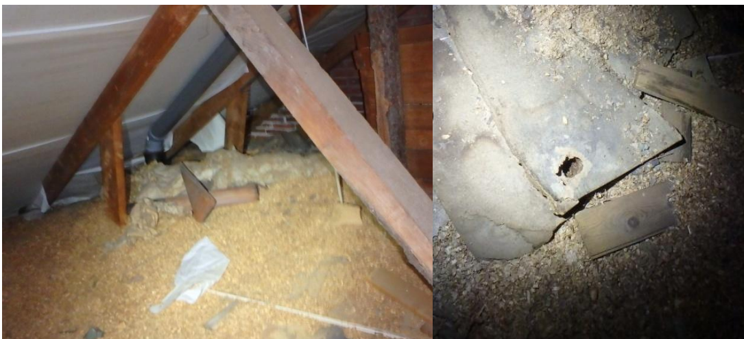
Kuvat 23 ja 24. Yläpohjan eristeiden joukossa on rakennusjätettä. Aluskate repsottaa paikoin. Oik. Yksittäinen vesivuotokohta.
