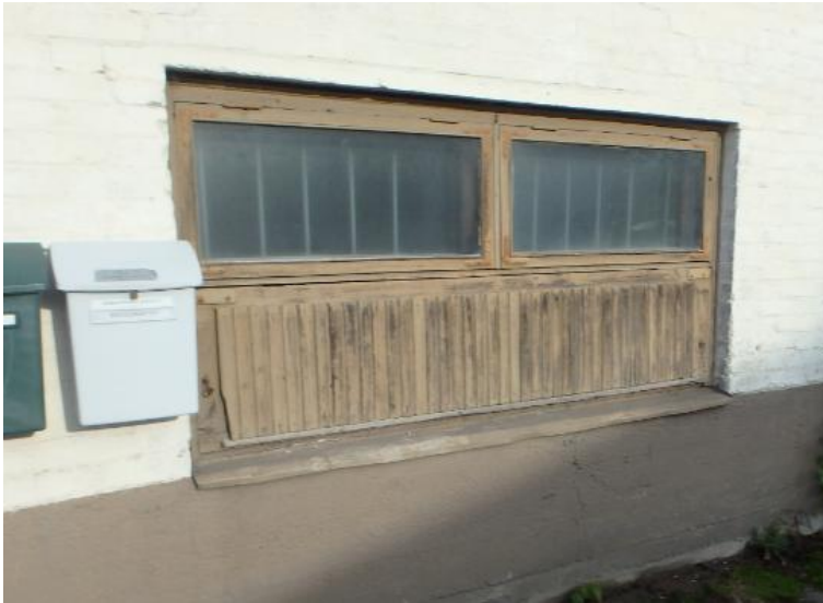
Kuva 11. Kellarin ikkuna on osittain paneloitu umpeen. Panelointi on heikossa kunnossa. Vesipelti on lähes vaakasuorassa.
