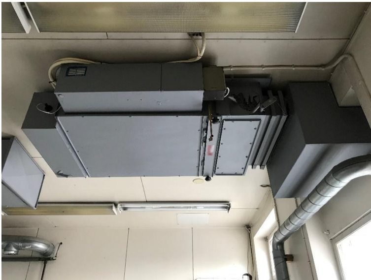
Kuva 35. Pesulan erillinen tuloilmakone.
