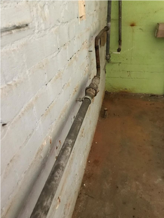
Kuva 37. Sinkittyä kylmävesiputkea kellarissa.
