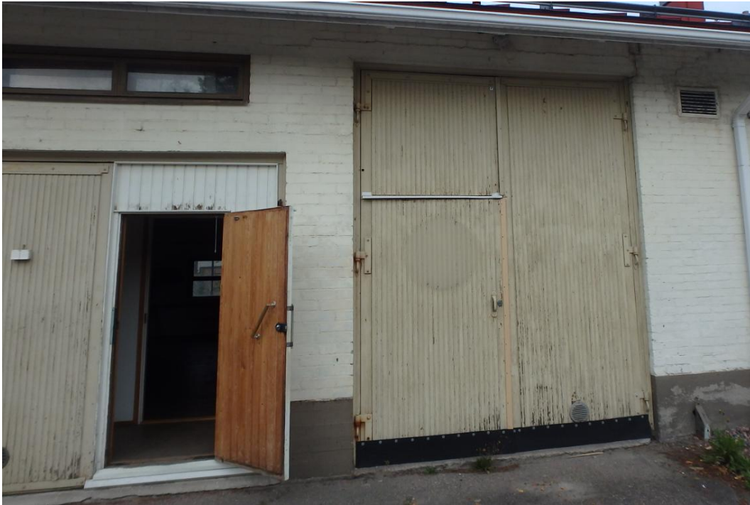
Kuva 13. Autotallien ovet ovat heikossa kunnossa. Ovia on muokattu pienemmiksi.
