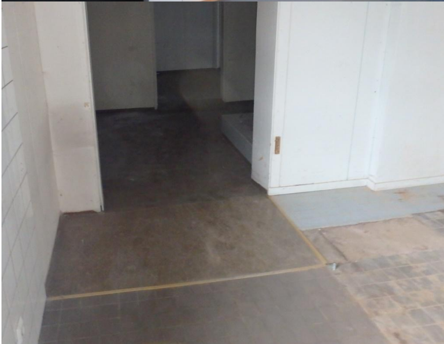
Kuva 27 ja 28. Tilapinnat ovat yleisesti heikossa kunnossa.
