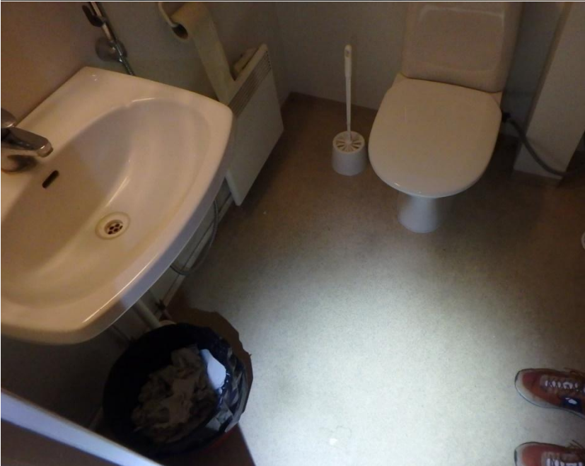
Kuvat 29 ja 30. WC-tilojen pinnat heikossa kunnossa.
