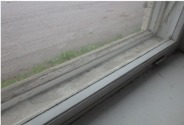
Kuva 12. Ikkunoiden pinnoitteet ovat heikossa kunnossa
