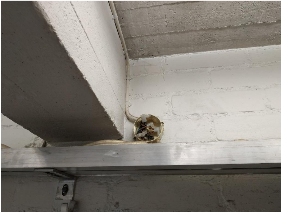
Kuva 51. Jakorasias, josta puuttuu kansi (1. kerroksessa entisissä toimistotiloissa).
