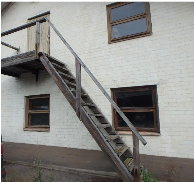
Kuva 14. Rakennuksen lounaispäädyn ikkunat ovat hieman paremmassa kunnossa. Vesipellit ovat lähes vaakasuorassa. Ullakon ikkunoista puuttuu vesipellit. Ullakon portaat ovat heikossa kunnossa.
