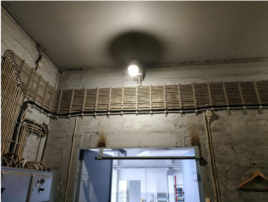
Kuva 40. Seinälle tehtyä pinta-asennuskaapelointia pääkeskushuoneessa (maanmittausosaston puolella).
