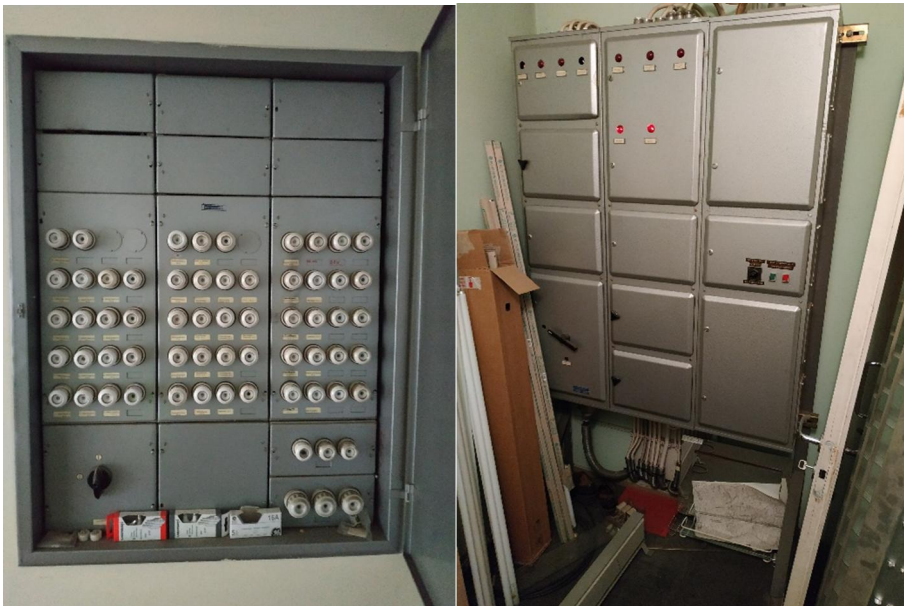
Kuvat 45 ja 46. 2. kerroksen ryhmäkeskus ja 2. kerroksen IV- ryhmäkeskus.
