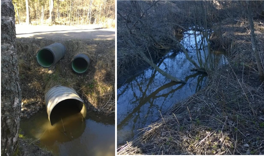
Kuvat 6 ja 7. Heinojantien alittavat rummut ja Heinoja. Heinojantien parantamisen yhteydessä rummut kannattaa korvata yhdellä suurella rummulla
