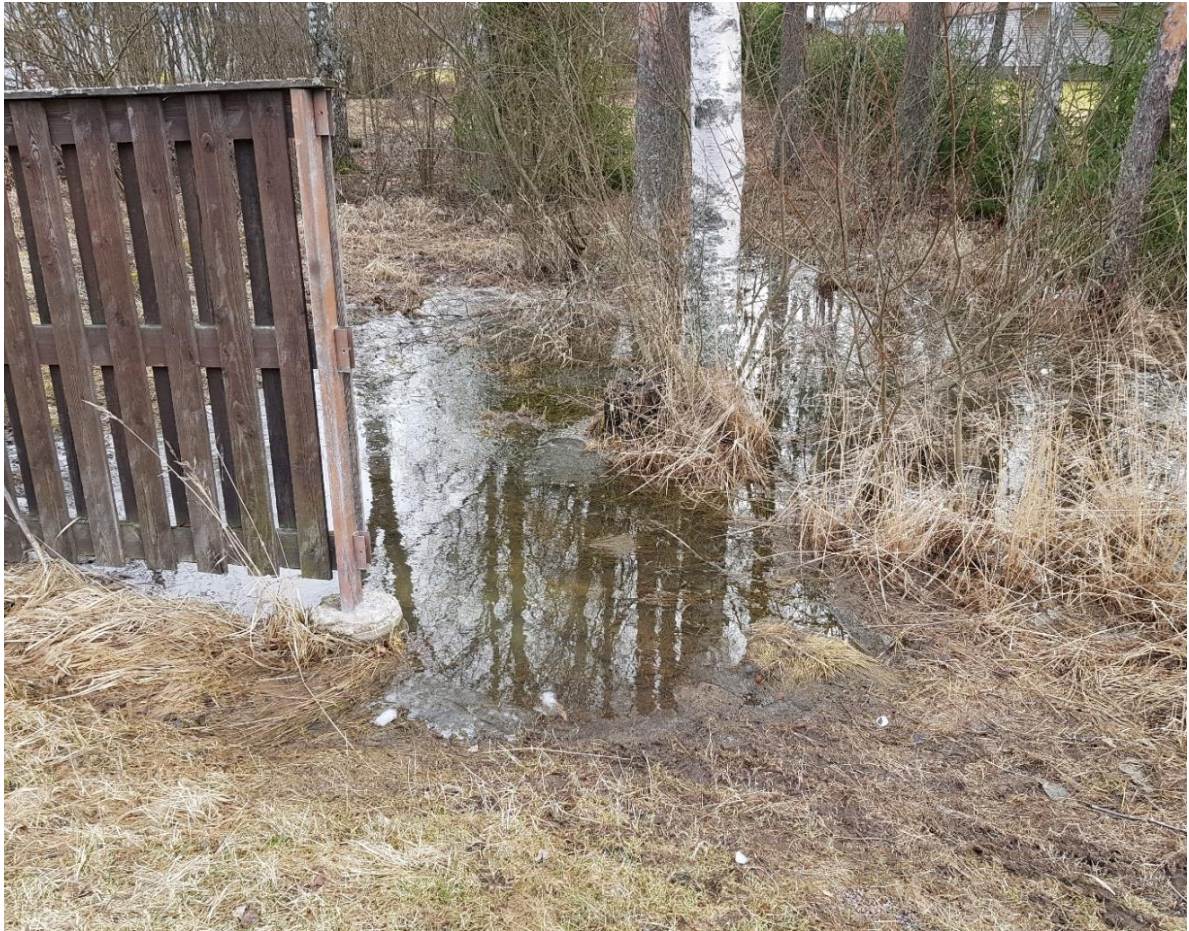
Kuva 10. Kuivatusongelmia Hellaskujan pohjoisen puoleisen lähikiinteistön rajalla. Kuva otettu Rajamäentieltä itään päin. [Ramboll, 3/2020]
