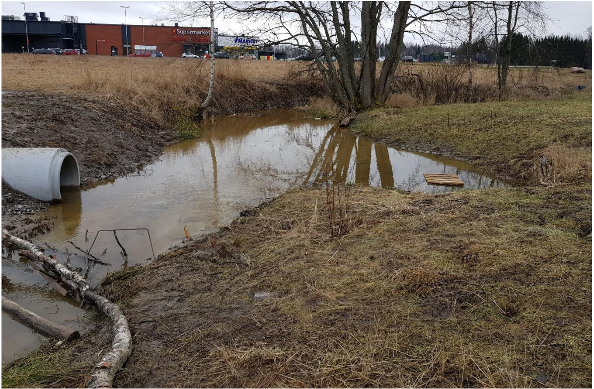
Kuva 15. Laskuojan levennys, johon Rajamäentien reunojen vedet johdetaan. Laskuojaan virtaa hulevesiä myös Kylänpään alueelta. Hulevedet johdetaan ojaverkoston ja hulevesipainanteiden kautta Matkunojaan. [Ramboll, 3/2020]
