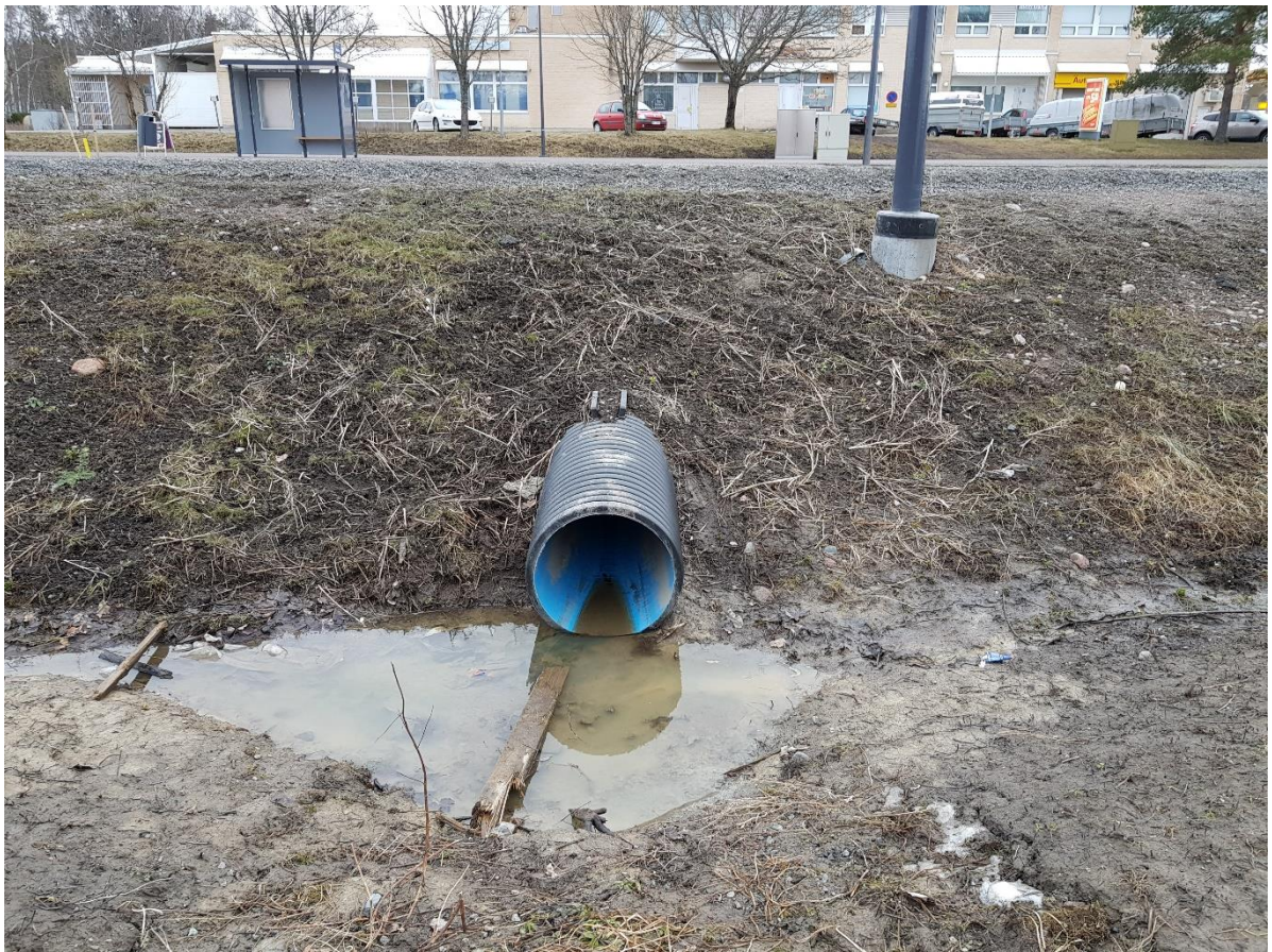
Kuva 12. Rajamäentien alittava 680 M rumpu Kiljavantien kiertoliittymän pohjoispuolella. Hulevesikaivon ja rummun kautta hulevedet virtaavat Rajamäentien itäpuolelta länsipuolelle. [Ramboll, 3/2020]
