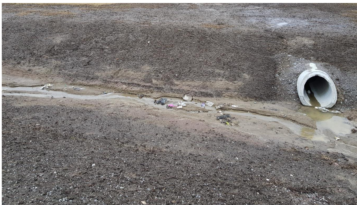
Kuva 14. Rajamäentien länsipuolen reunaojasta vedet johdetaan 800 B putkella laskuojaan. [Ramboll, 3/2020]
