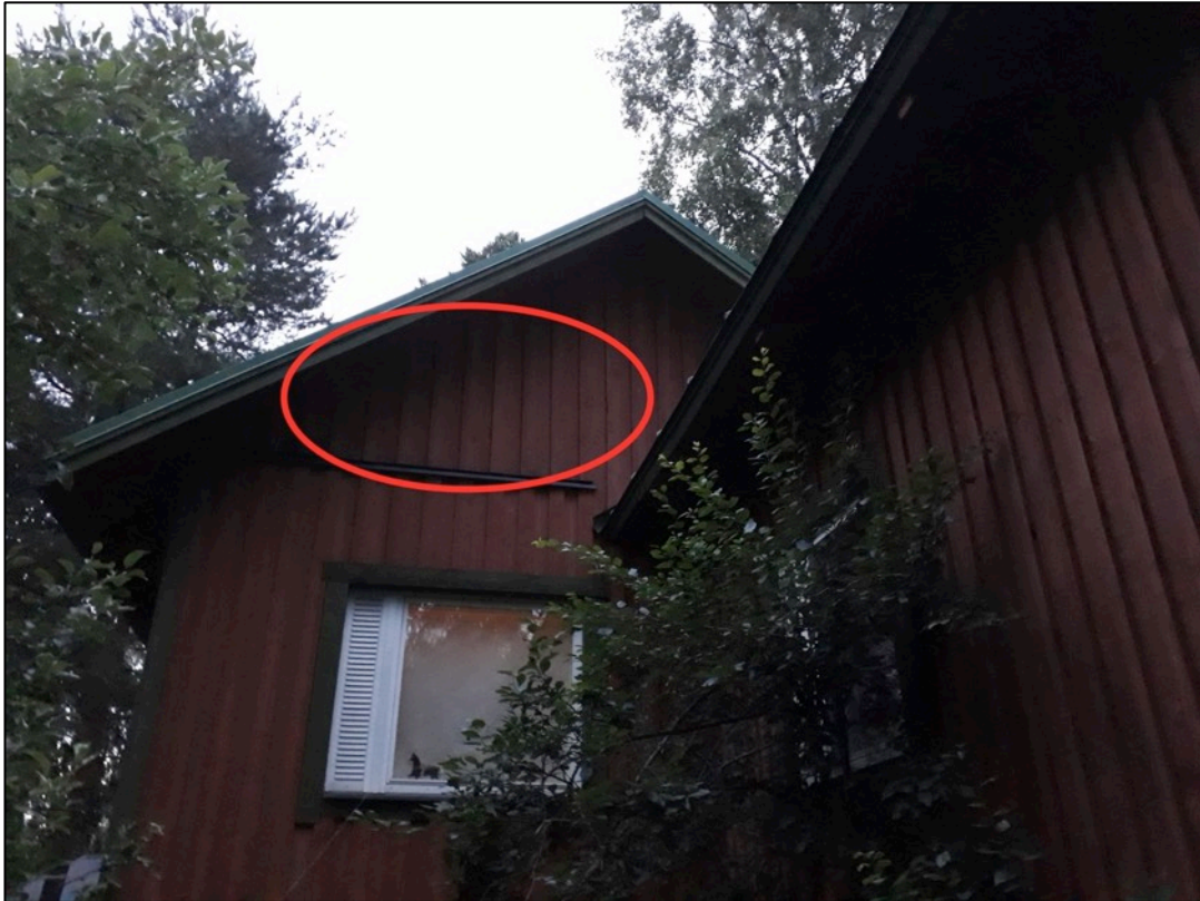
Liite 5 – Heinojantie 25 ja lepakoiden piilopaikka seinärakenteissa
