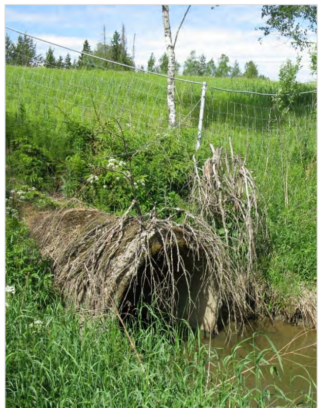
Kuva 2. Hämeenlinnanväylän alittava rumpu oli risukon peitossa.
