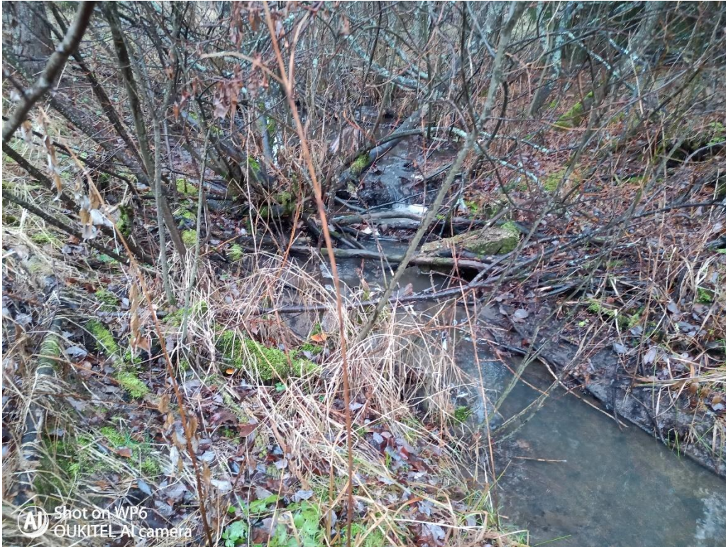
Kuva 7 Lounaisen valumareitin alapuolinen oja on osittain tukkeutunut puiden ja pensaiden kasvun vuoksi.
