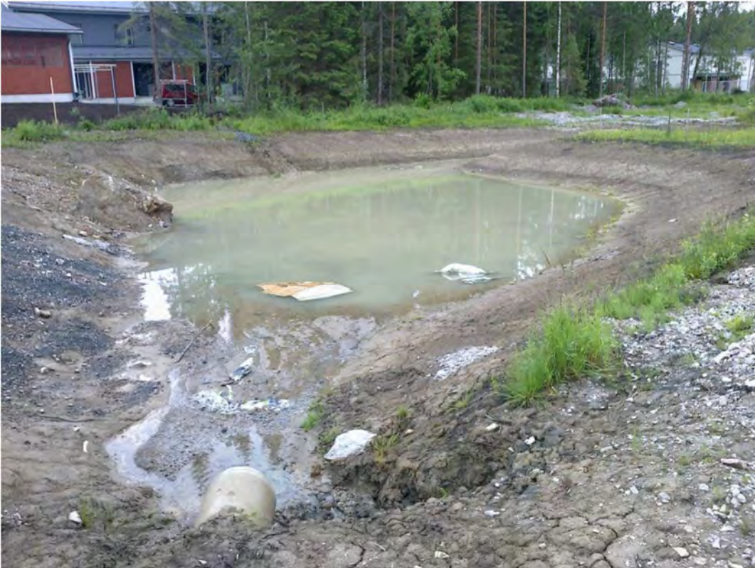
Kiintoaineksen laskeutusaltaalla suojaamattomat luiskat lisäävät altaan kuormitusta.
