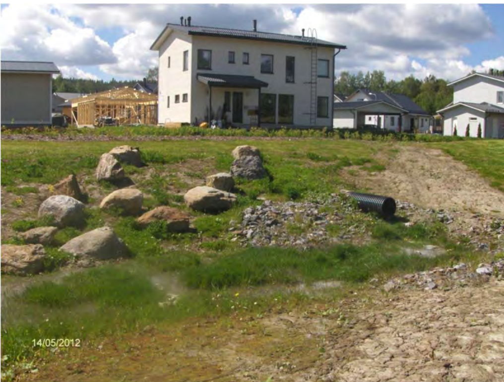
Rambollin suunnitteleman Kangasalan Vaarinmaan hulevesien hallintarakenteen luiskiin tehtiin heti kaivutöiden jälkeen nurmikylvö, mutta kylvämisen jälkeen sattuneet sateet huuhtoivat kylvöalueet osittain paljaksi ennen nurmen juurtumista. Luiskien suojaaminen eroosiosuojamatolla olisi auttanut kasvillisuuden juurtumista.
