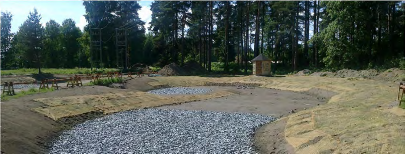
Rambollin suunnittelema Kangasalan Kuohunlahden puiston hulevesien hallinta-alue rakenteilla. Alue on suunniteltu nykyisen virtausreitän sivuun siten, että allas voidaan rakentaa kuivatyönä ja hulevedet käännetään altaalle vasta sen valmistuttua. Reunaluiskat on suojattu kookosmatolla, johon on kylvetty nurmi. Kuva 24.6.2013 noin kaksi viikkoa eroosiosuojamaton asentamisen jälkeen.
