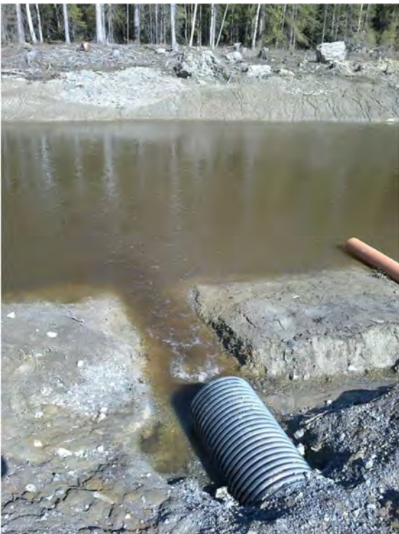
Puhtaiden valumavesien johtaminen kiintoaineen laskeutusaltaalle heikentää laskeutuksen tehoa. Haittavaikutusta kasvattaa entisestään käytetty liian lyhyt putki, josta purkautuvat vedet kuluttavat voimakkaasti altaan suojaamattomia maaluisikia.
